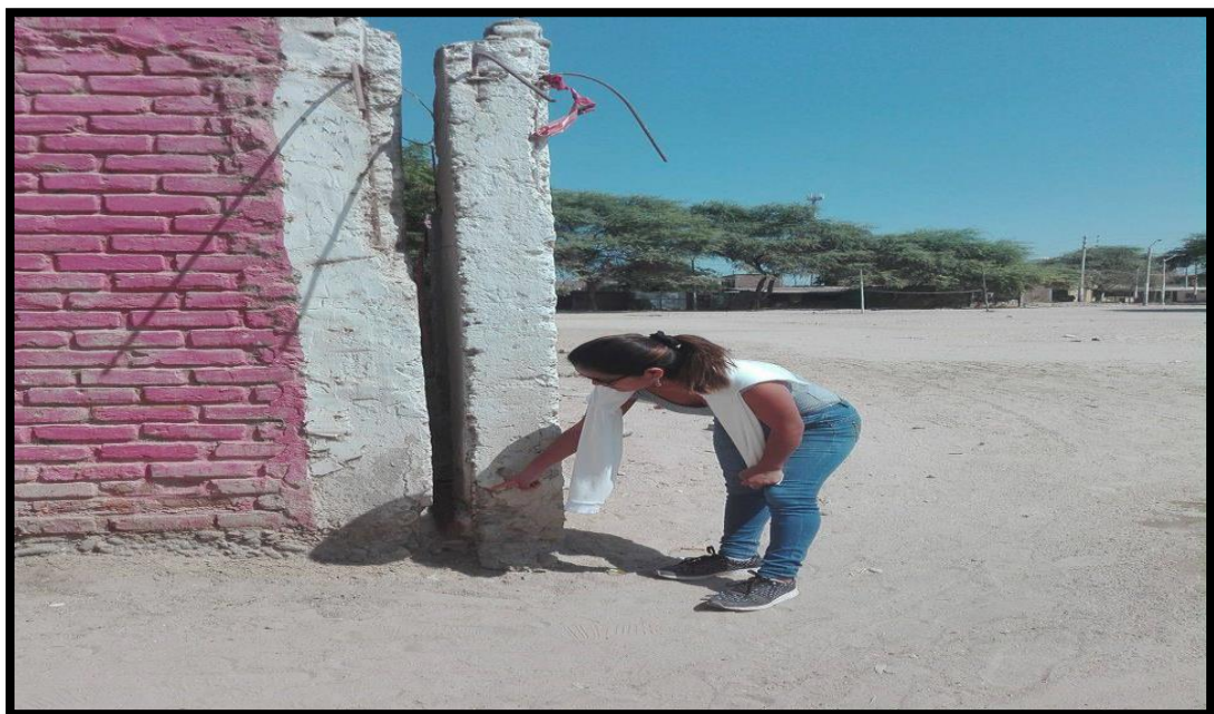
Imagen 16: Identificación de Corrosión, Desprendimiento y Oxidación, UM 03 calle Ca. Hector patorro.
