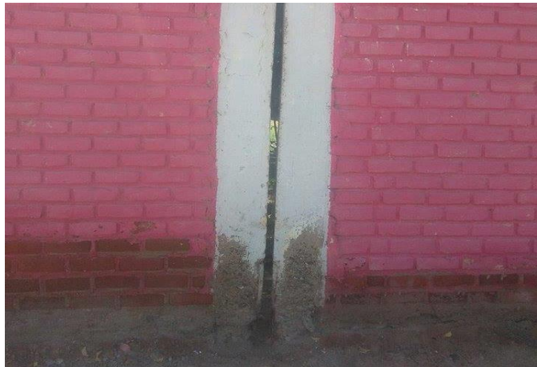
Imagen 5: corrosión de acero en columna
