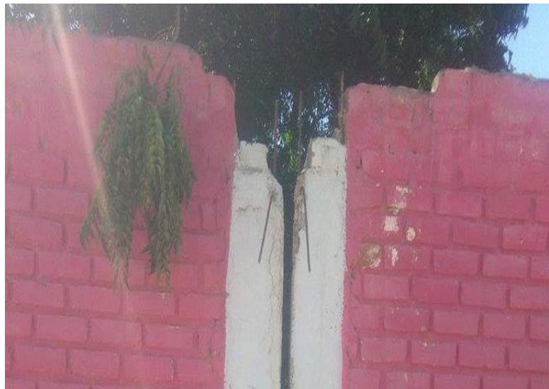
Imagen 8: Desprendimiento de columna y muro
