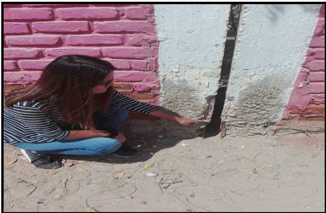
Imagen 18: Identificación de Corrosión, UM 06 calle Psj.F.Cossio del Pomar.
