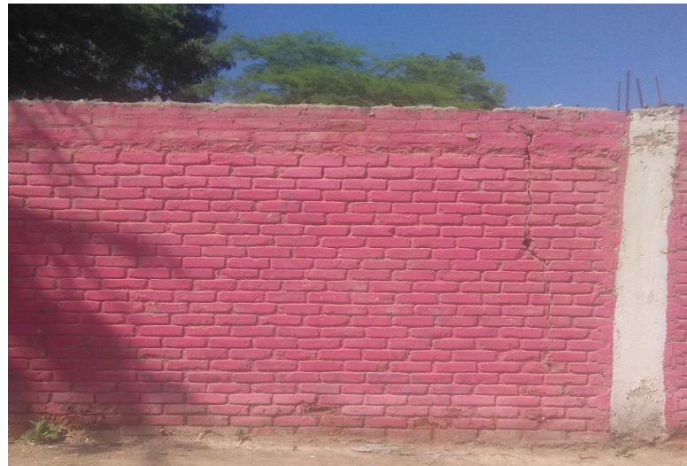
Imagen 2: Grieta en muro de albañilería confinada
