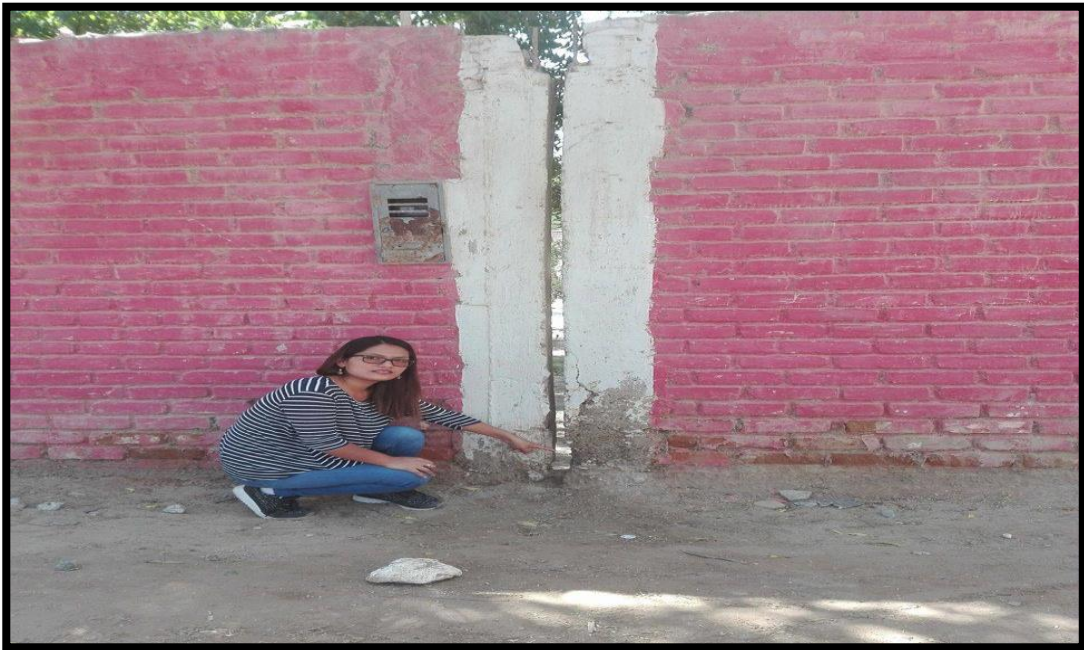
Imagen 23: Identificación de Desprendimiento, Erosión y eflorescencia, UM 13 calle Ca. Robles Razuri.
