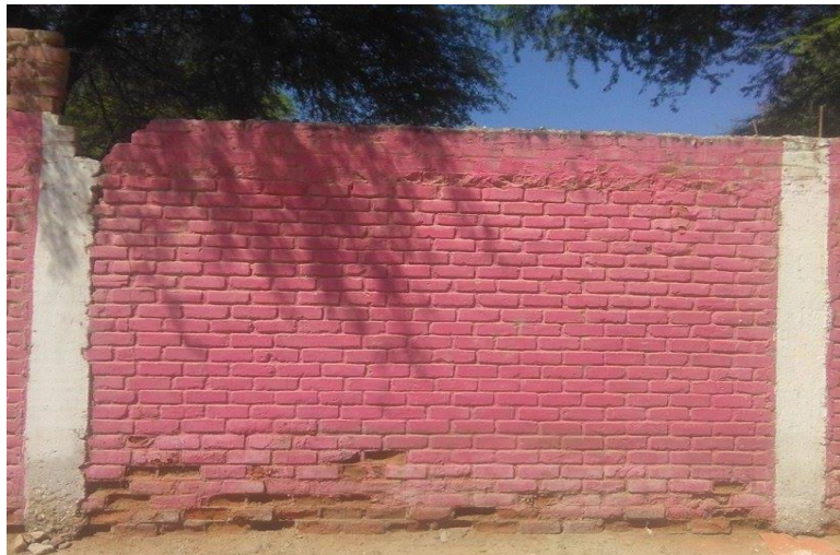
Imagen 4: Erosión en muro de albañilería confinada
