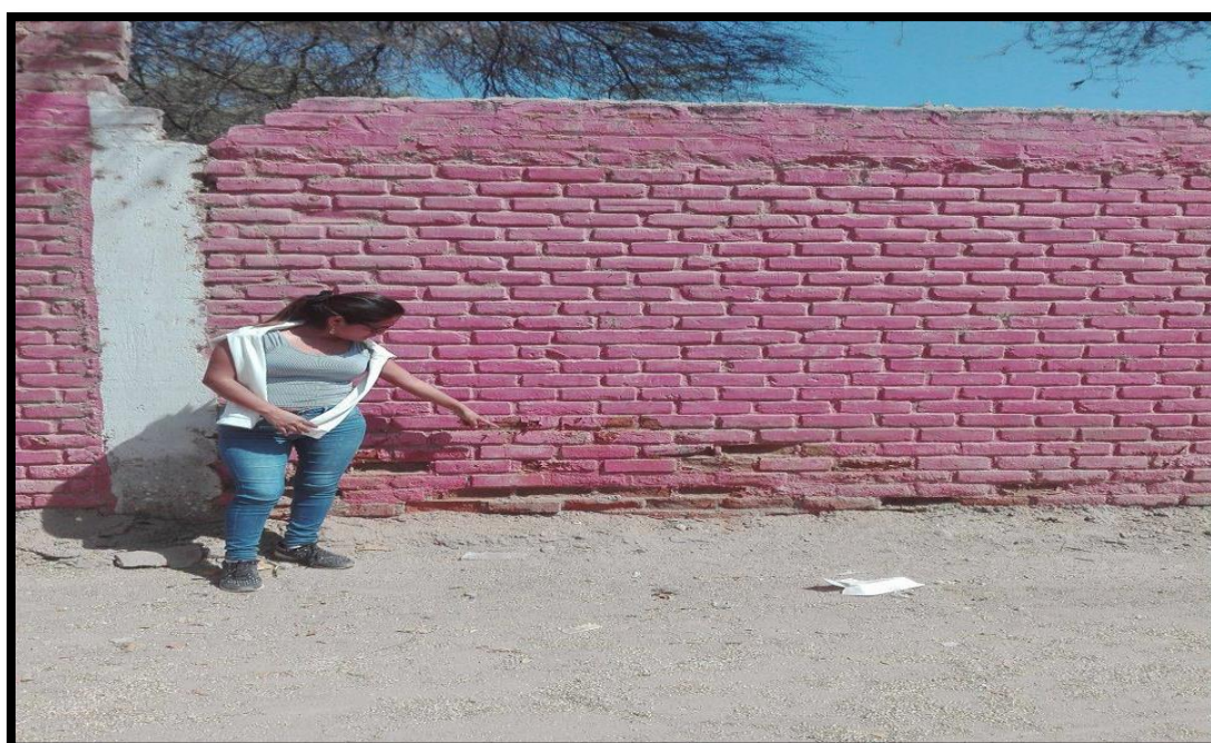
Imagen 12: Identificación de Erosión y Desprendimiento, UM 01 calle Ca. Hector patorro.
