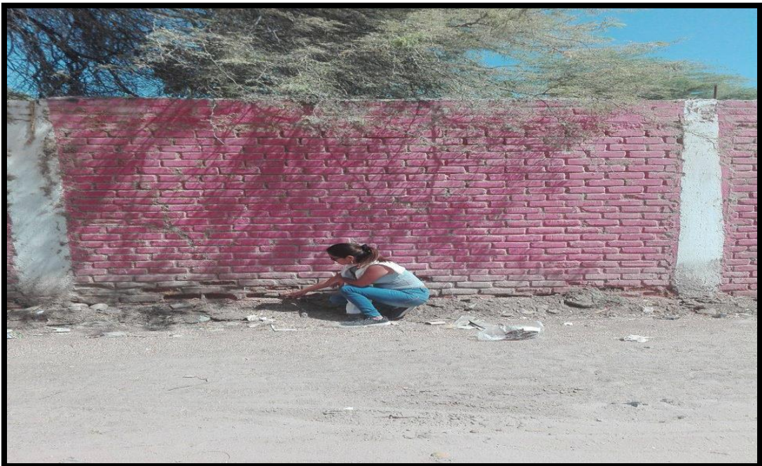
Imagen 14: Identificación de Erosión, UM 02 calle Ca. Hector patorro.
