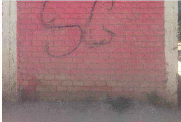
Imagen 3: Eflorescencia en muro de albañilería confinada
