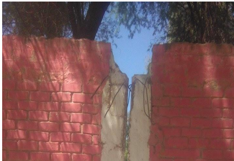
Imagen 6: Oxidación de acero en columna
