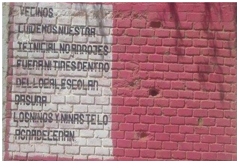
Imagen 7: Picadura en muro de albañilería confinada
