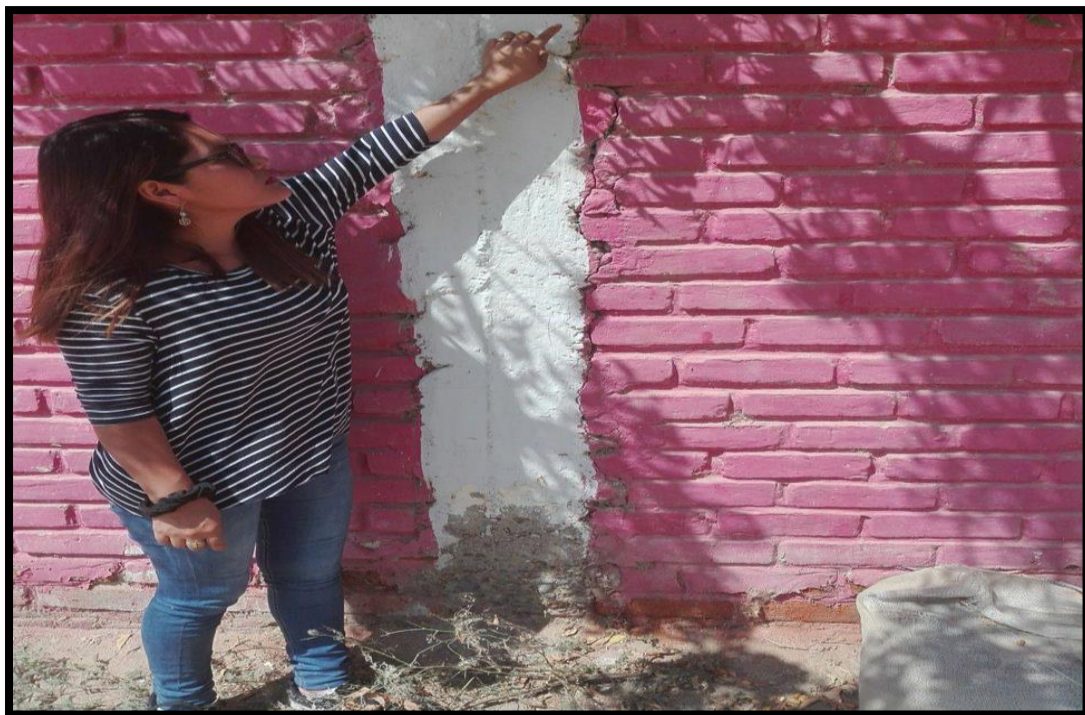
Imagen 20: Identificación de Fisura, UM 07 calle Psj.F.Cossio del Pomar.
