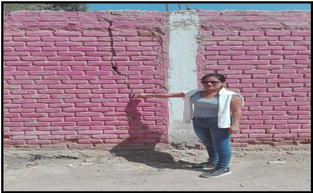
Imagen 15: Identificación de Grieta y Erosión, UM 03 calle Ca. Hector patorro.
