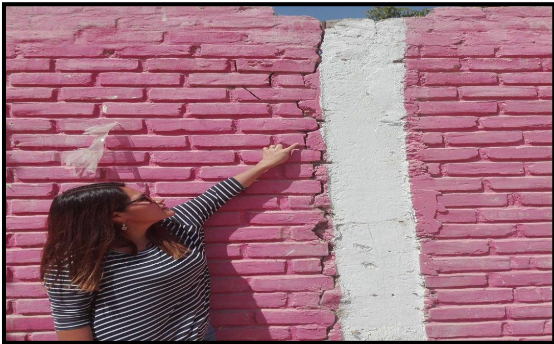
Imagen 19 : Identificación de Grieta, UM 06 calle Psj.F.Cossio del Pomar.
