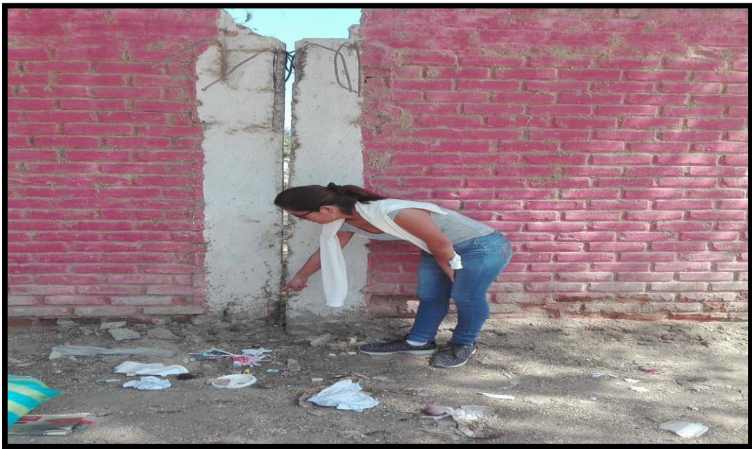
Imagen 13: Identificación de Erosión, Corrosión, Desprendimiento y oxidación, UM 02 calle Ca. Hector Patorro.
