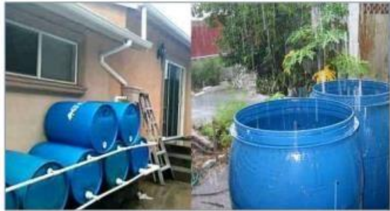
Figura 04. Sistema de agua de lluvia
