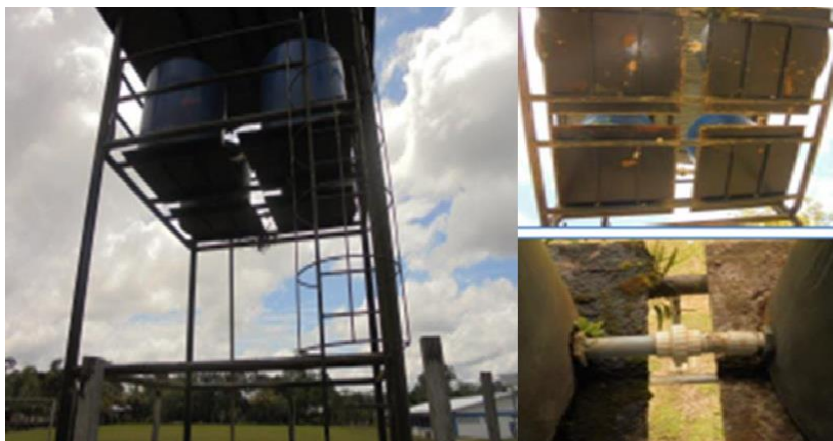
Figura N°18.: Estado del tanque de la CC.NN Santa Rosa.
