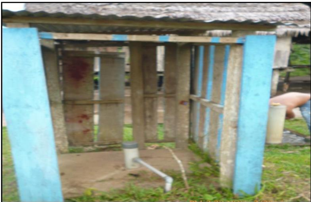
Vista del Pozo tubular en mal estado de la CC.NN Santa Rosa
