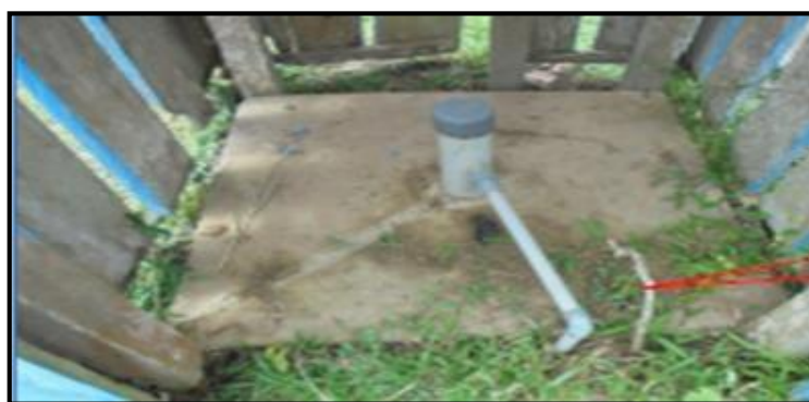
Figura N°17.: Línea de impulsión
