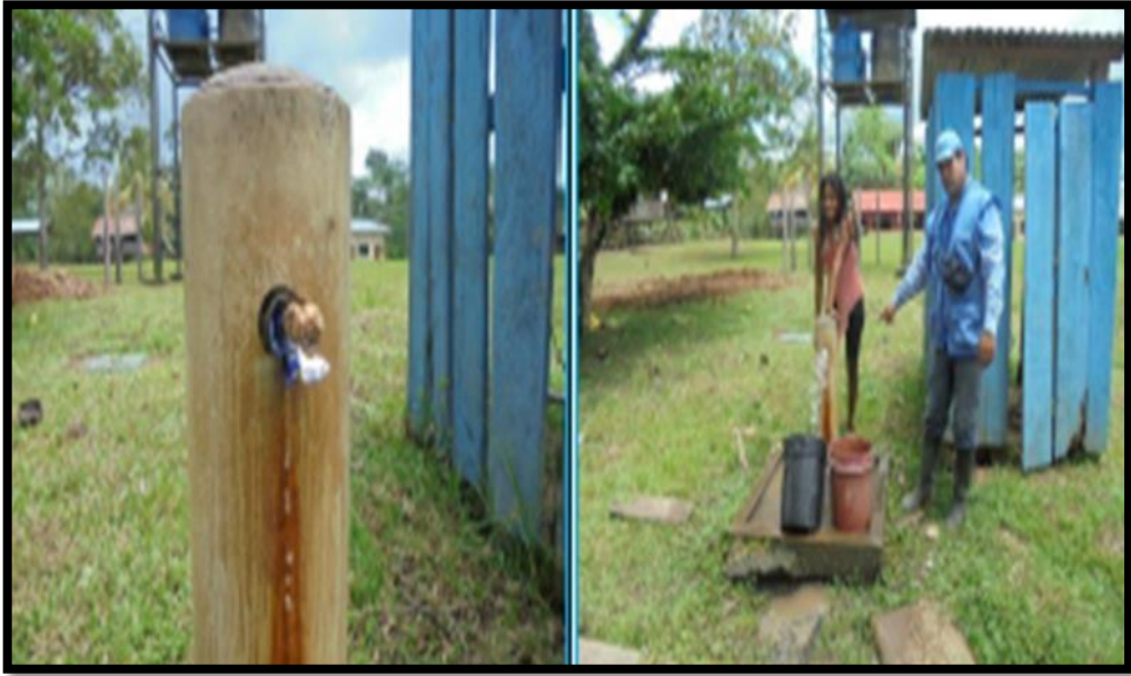
Se observa la pileta abastecedora de agua en mal estado
