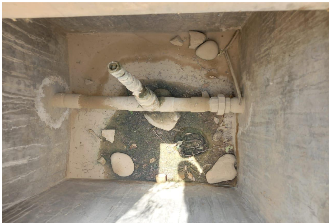
Figura 17: Detalle del interior de la válvula de aire.
