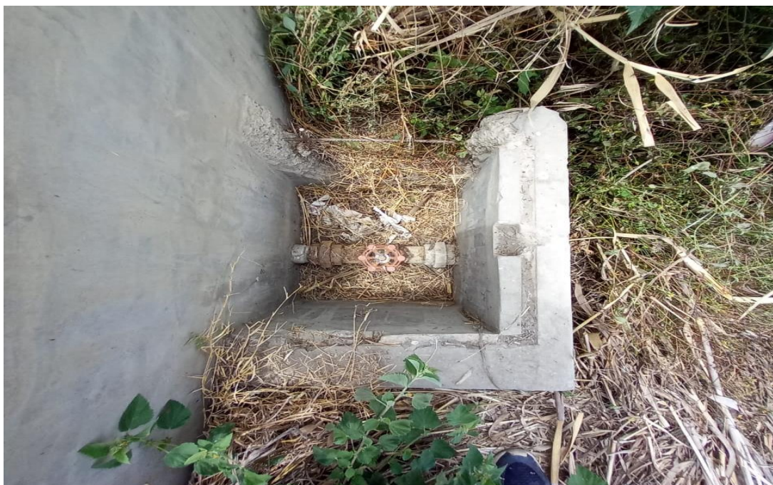
Figura 14: Caja de válvulas de la captación.
