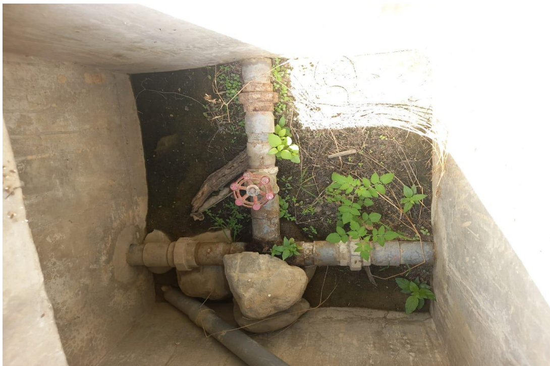
Figura 19: Detalle del interior de la válvula de purga
