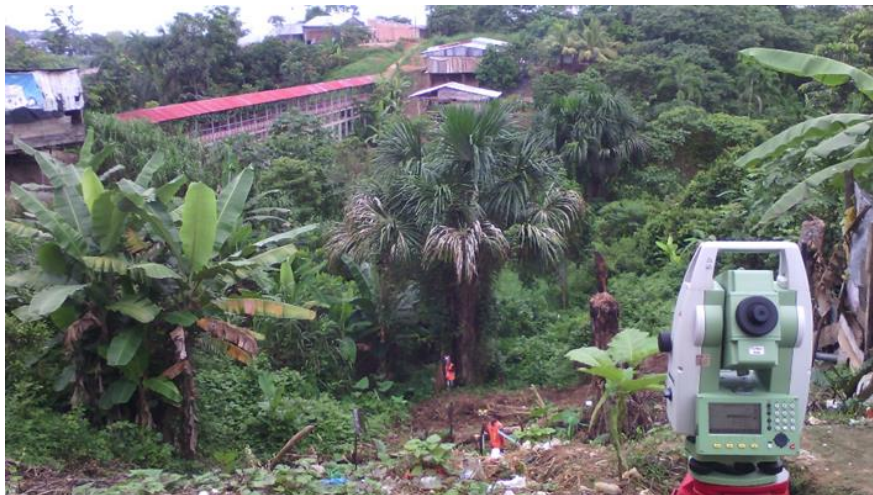
Imagen 13. Se observa el levantamiento topográfico en los barrancos donde se proyectaran algunos pases aéreos para la línea de impulsión.
