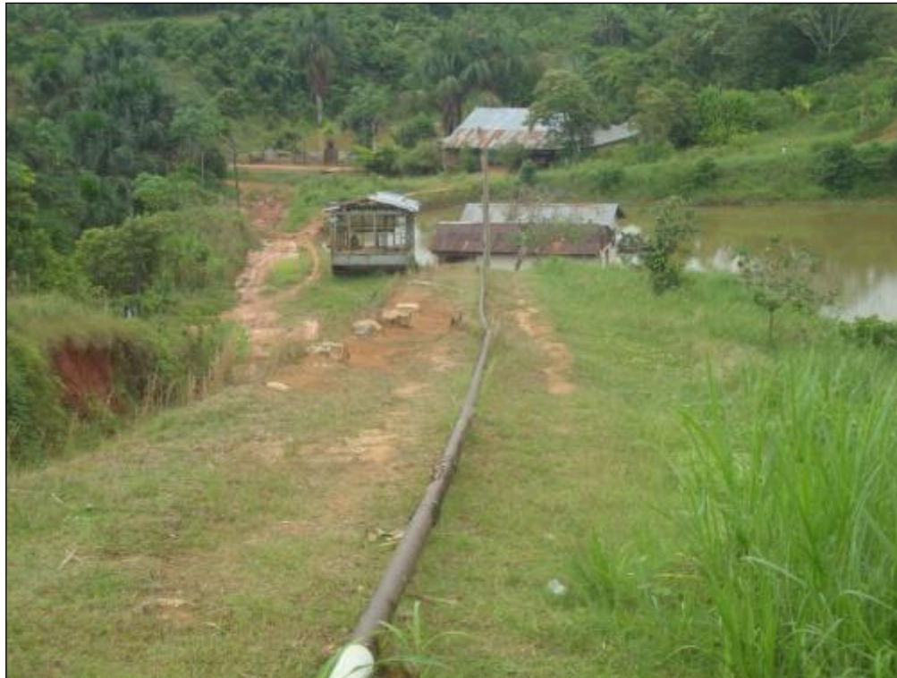
Imagen 2: Línea de Impulsión
