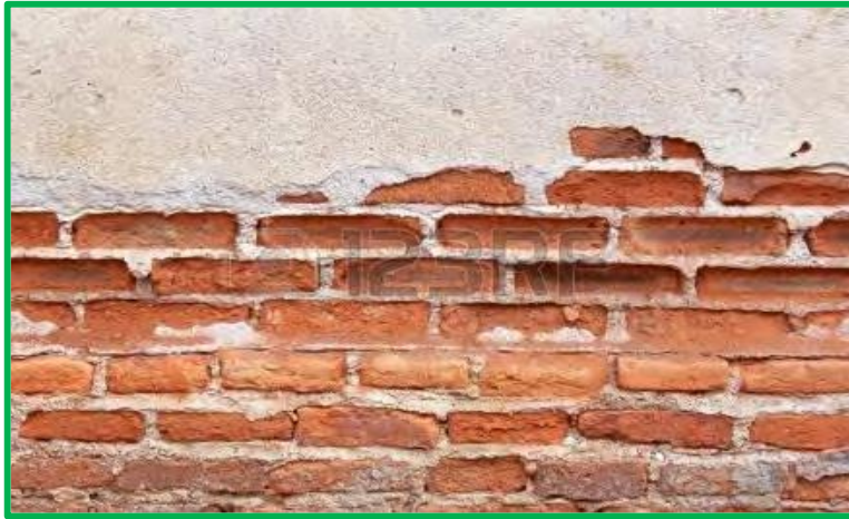
Figura 19. Erosión en muro de albañilería
