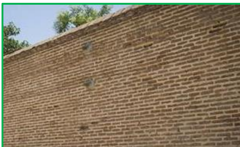
Figura 25. Picaduras en Muro de Albañilería
