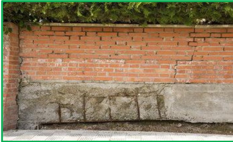
Figura 24. Corrosión en muro de albañilería
