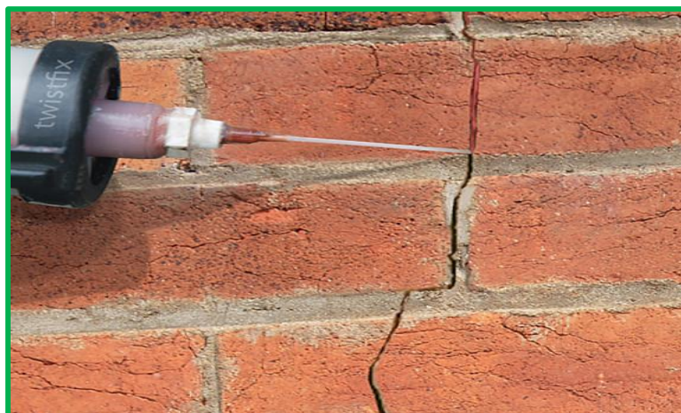
Figura 20. Fisura en Muro de Albañilería
