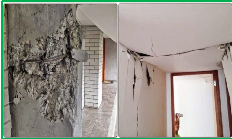
Figura 29. Lesiones Químicas en Muro de Albañilería
