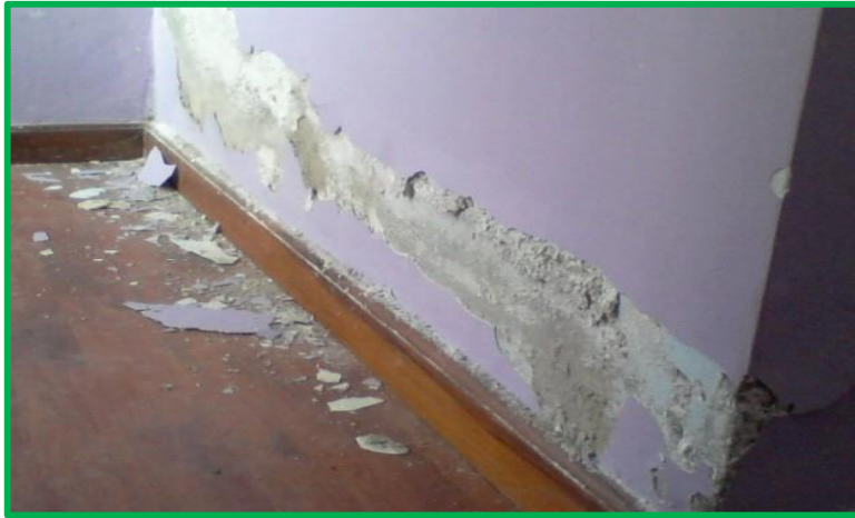
Figura 27. Lesiones físicas en Muro de Albañilería
