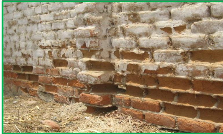
Figura 6. Muros de ladrillo con eflorescencia
