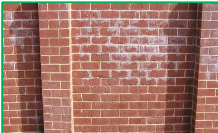
Figura 22. Eflorescencia en Muro de Albañilería
