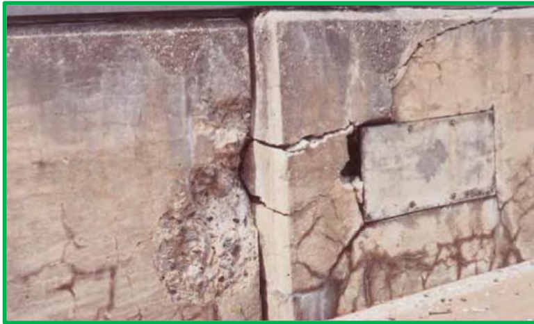
Figura 23. Distorsión en Muro de Albañilería
