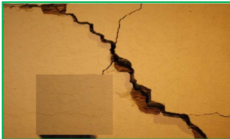
Figura 28 .Lesiones Mecánicas en Muro de Albañilería
