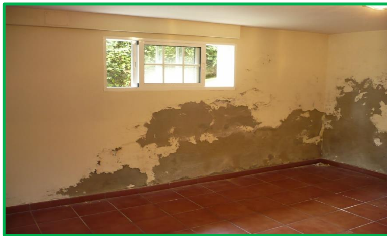
Figura 26. Humedad en Muro de Albañilería
