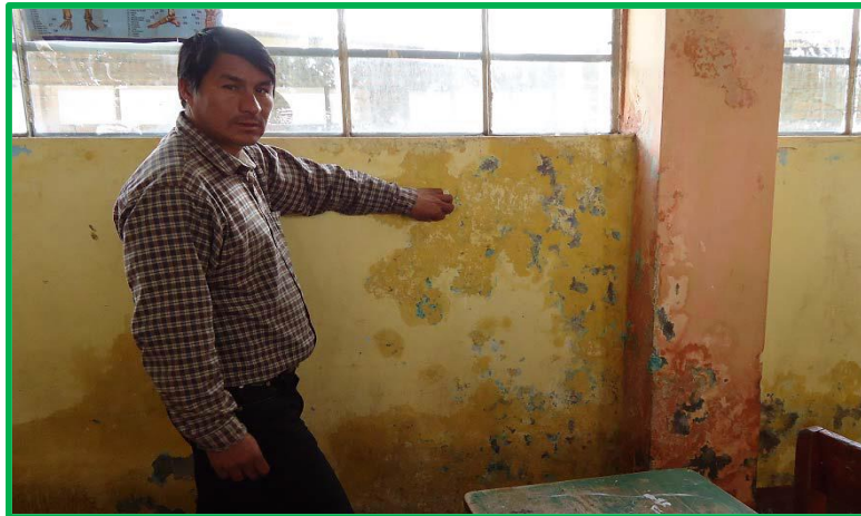
Figura 7. Falla patológica de origen de humedad
