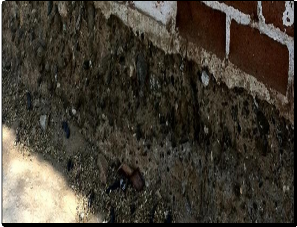
Imagen 13: Detalle de Patología Desintegración.
