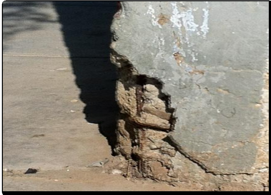
Imagen 15: Detalle de Patología Corrosión).
