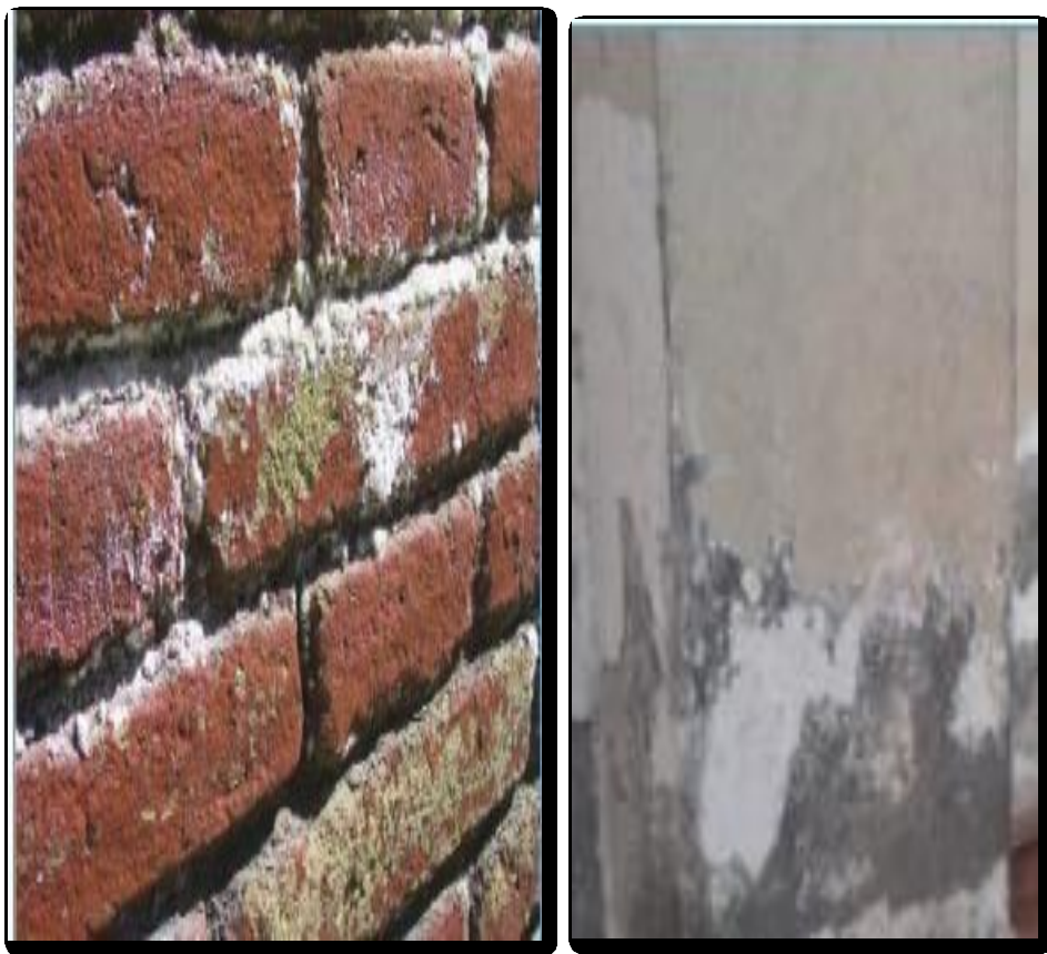
Imagen 17: Detalle de patología Eflorescencia en muro y columna.
