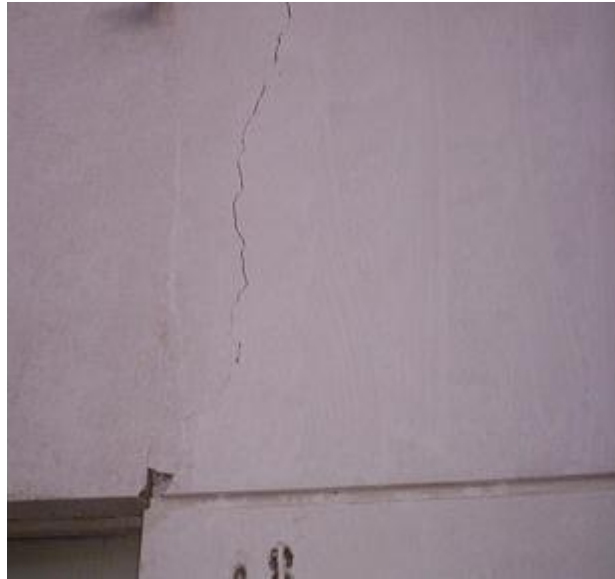
Imagen 11: Detalle de fisura en muro.
