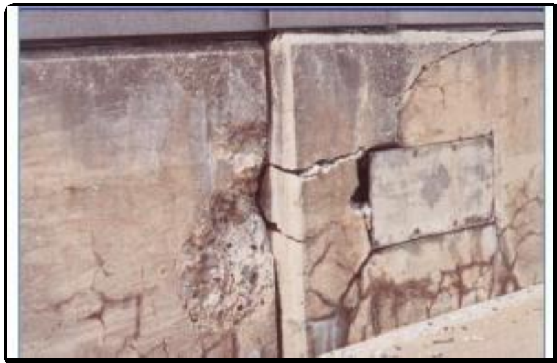
Imagen 16: Detalle de Patología Distorsión.
