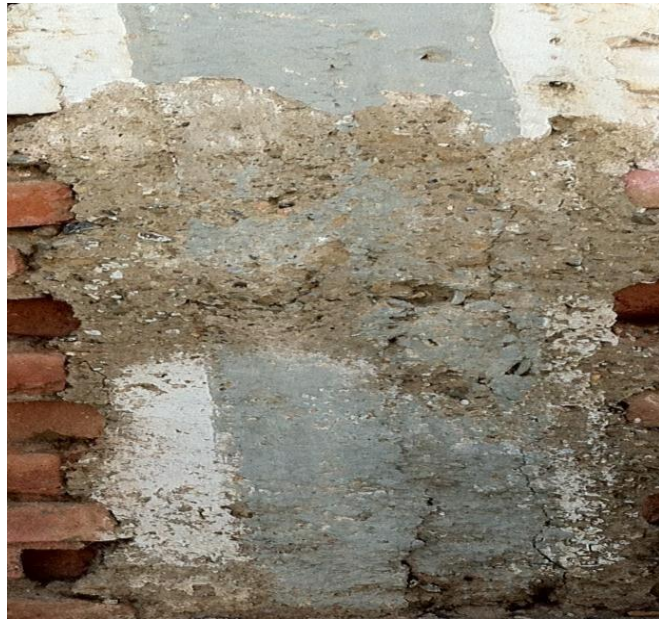
Imagen 12: Detalle de Patología Escamado.
