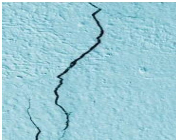
Imagen 10: Grieta en muro.
