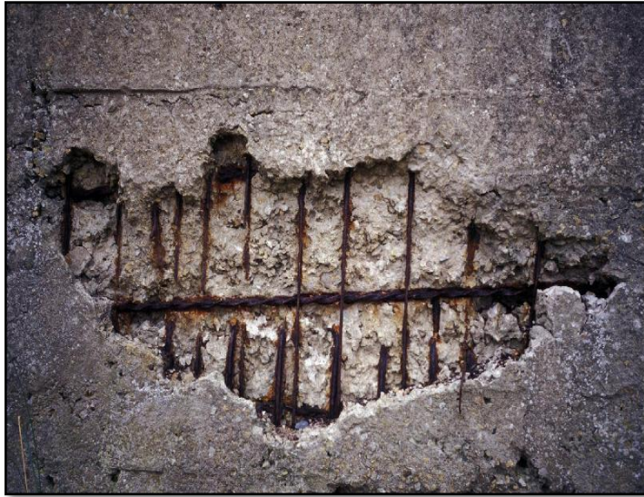
Gráfico 24: Deterioro por corrosión en el acero.
