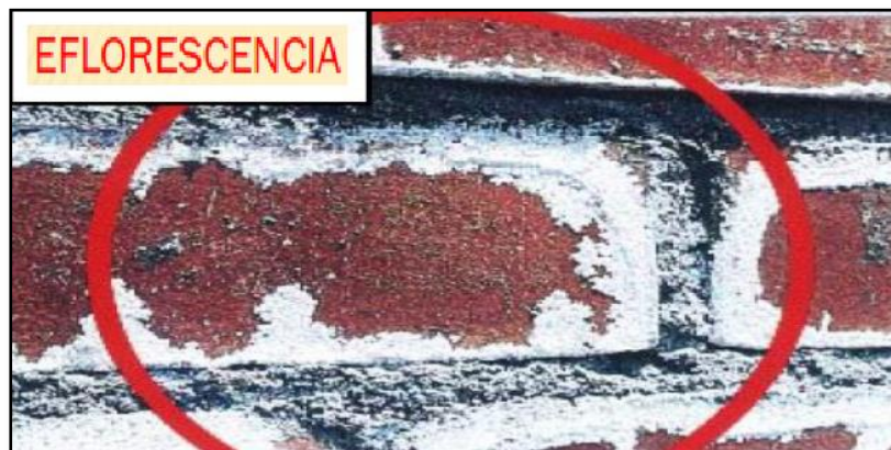
Gráfico 18: Eflorescencia en muro de albañilería.
