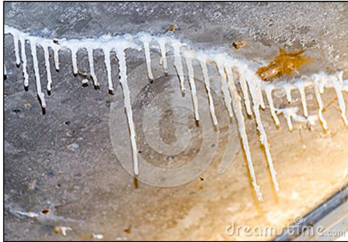
Gráfico 21: Estalactita en techo de concreto.
