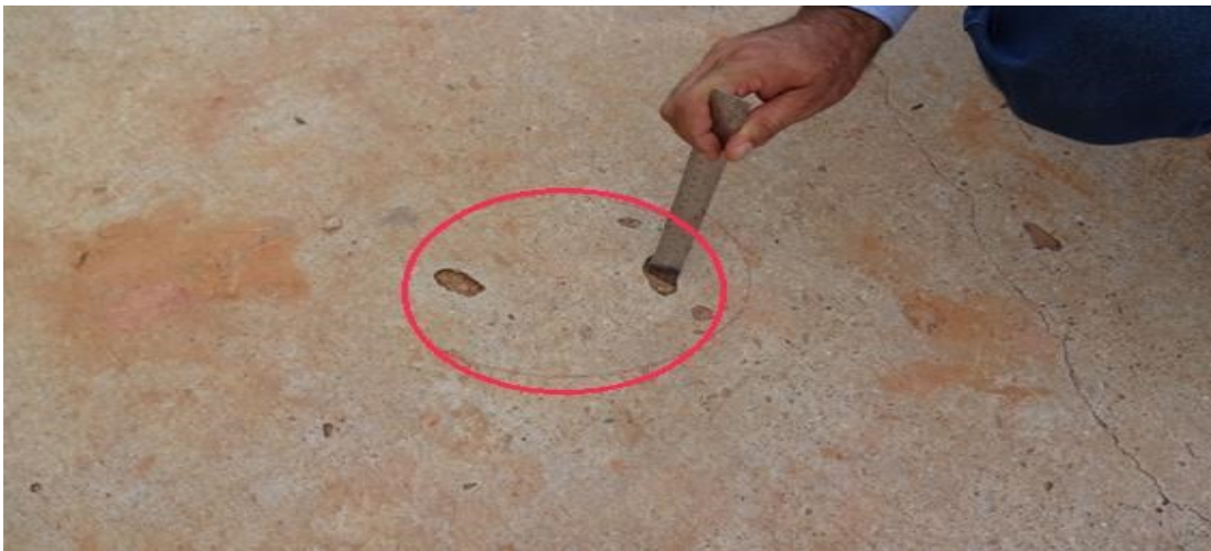
Figura N° 10 Se puede observar la presencia de falla de popouts en la plataforma deportiva del AA.HH. Las Loma de la Molina.
