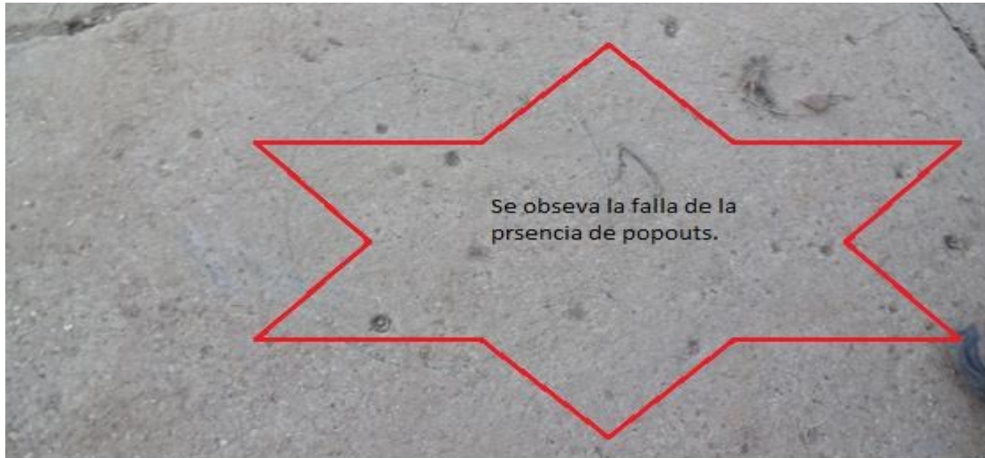
Figura N° 21 Se puede observar la presencia de falla de Popouts de la plataforma deportiva del AA.HH Nazarenos
