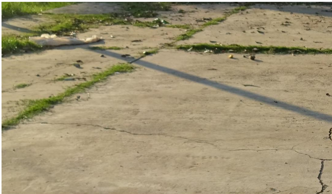
Figura N° 13 Se puede observar la presencia de falla del Daño de sello de la junta en la plataforma deportiva del AA.HH Miraflores.
