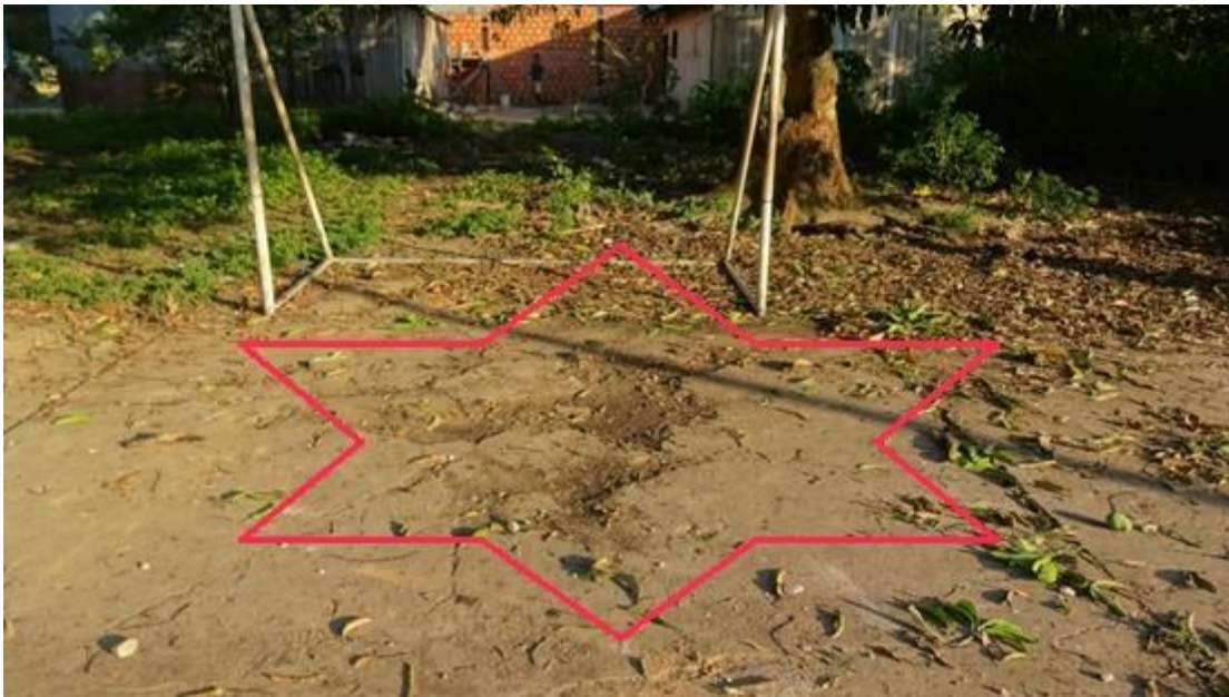
Figura N° 16 Se puede observar la presencia de falla de Desconchamiento de la plataforma deportiva del AA.HH Miraflores.
