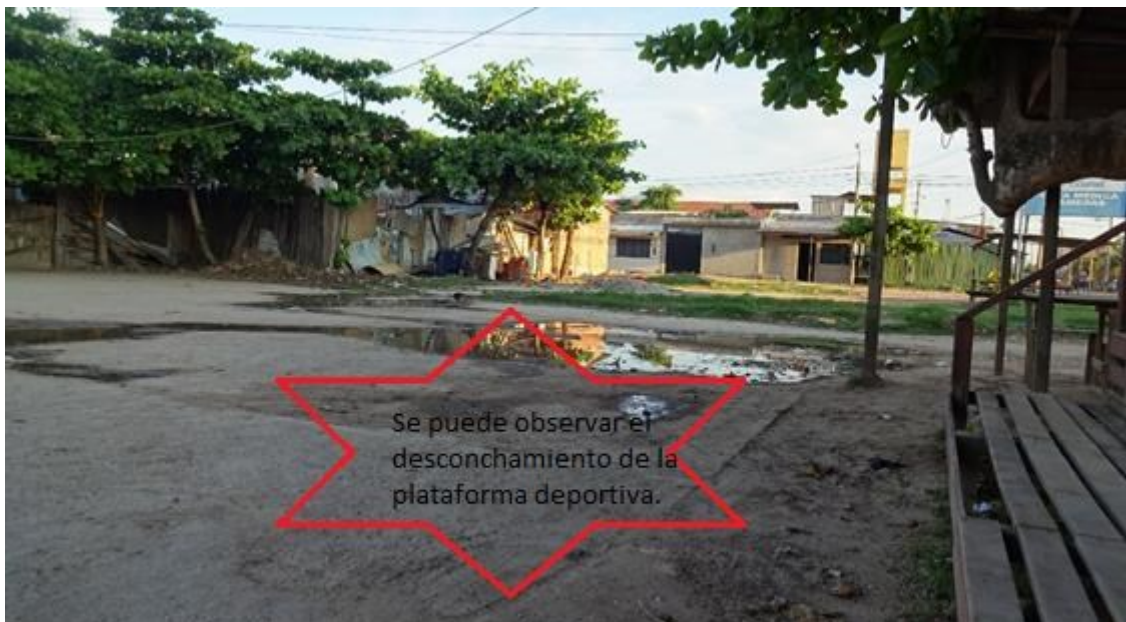
Figura N° 22 Se puede observar la presencia de falla de Desconchamiento de la plataforma deportiva del AA.HH Nazarenos.
