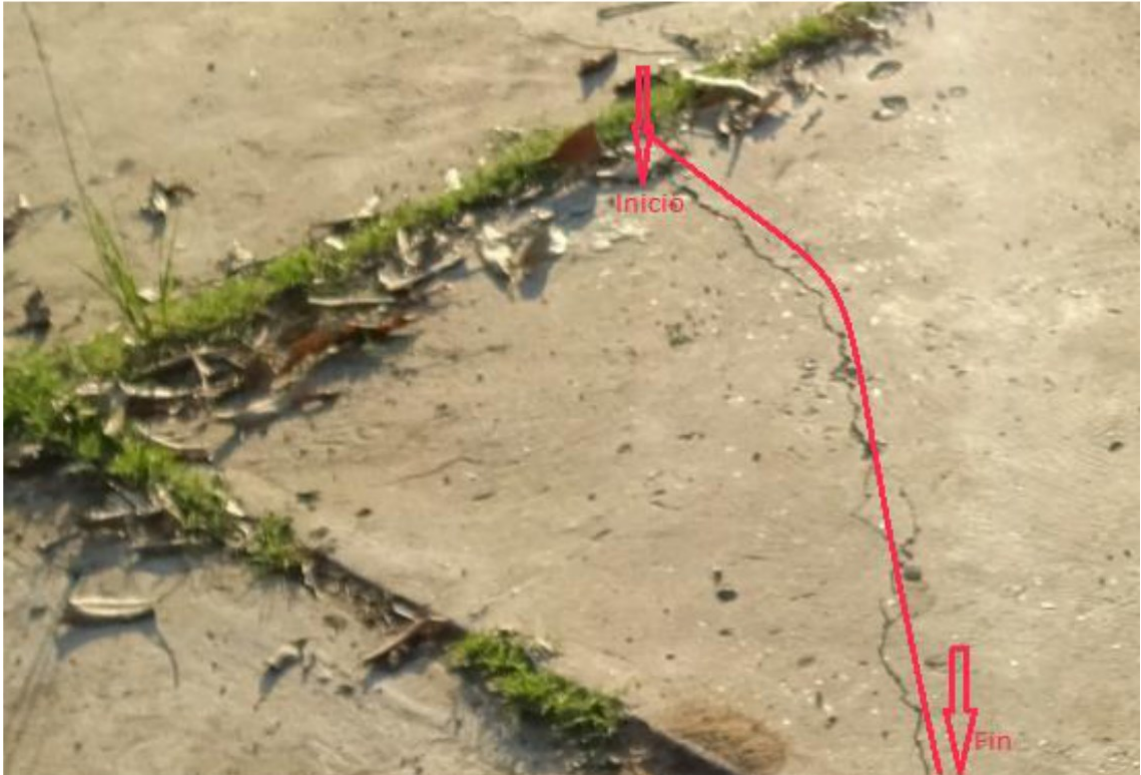
Figura N° 11 Se puede observar la presencia de falla de Grieta de esquina en la plataforma deportiva del AA .HH Miraflores.
