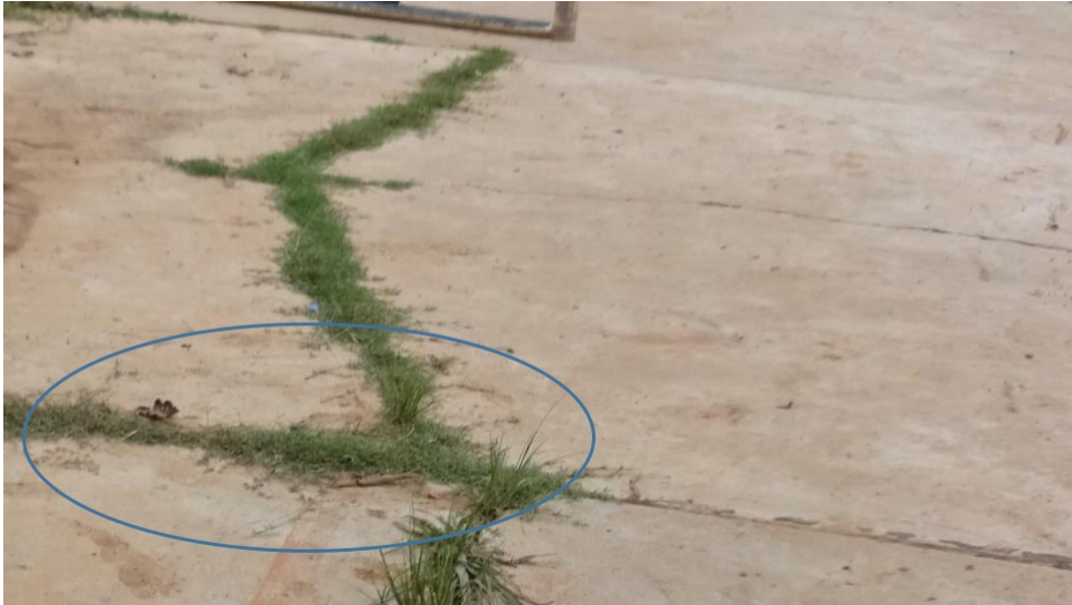
Figura N° 05 Se puede observar la presencia del Daño del sello de juntas en la plataforma deportiva.
