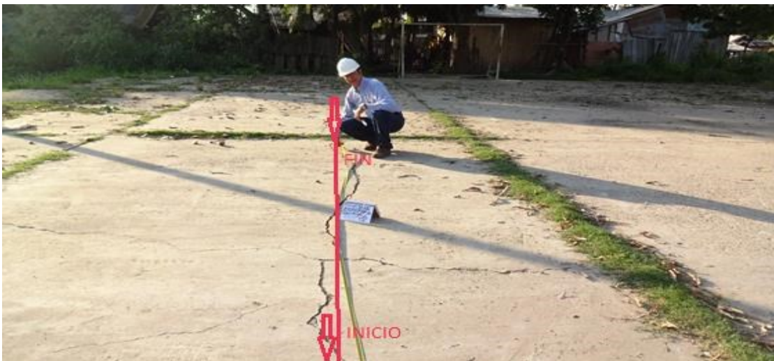
Figura N° 12 Se puede observar la presencia de falla de Losa dividida en la plataforma deportiva del AA .HH Miraflores.
