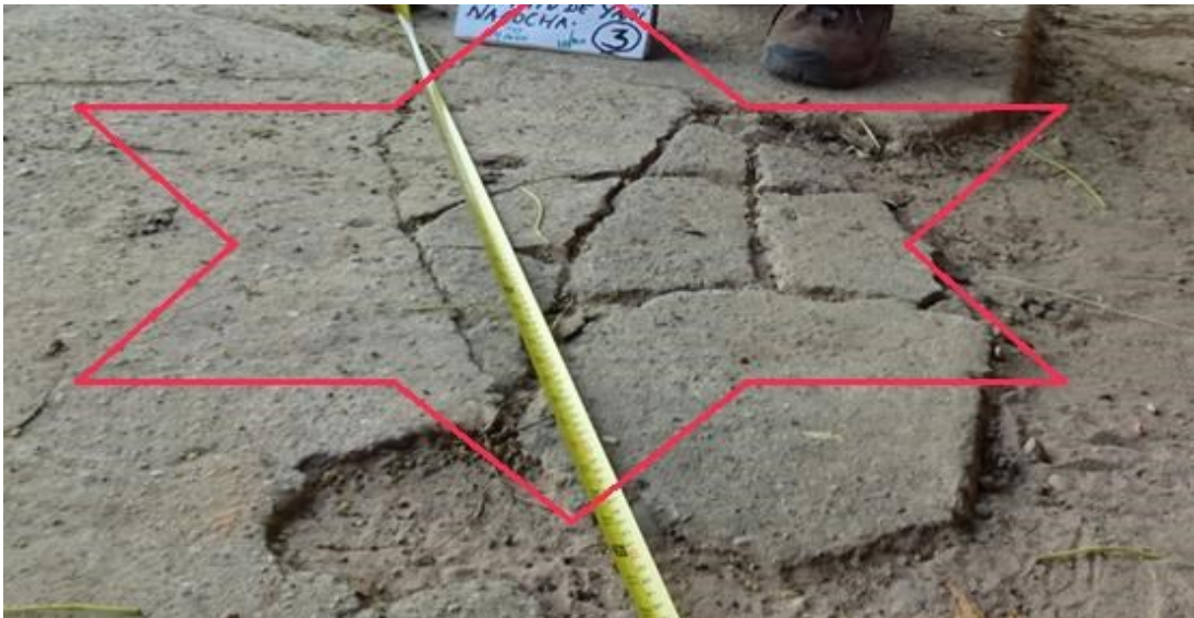
Figura N° 15 Se puede observar la presencia de falla de Punzamiento de la plataforma deportiva del AA.HH Miraflores.
