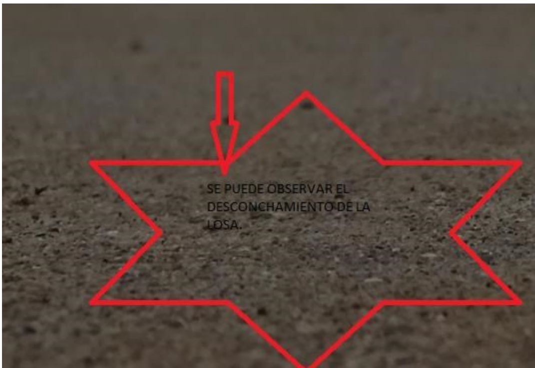
Figura N° 04 Se puede observar la presencia de la falla de Desconchamiento en la plataforma deportiva.
