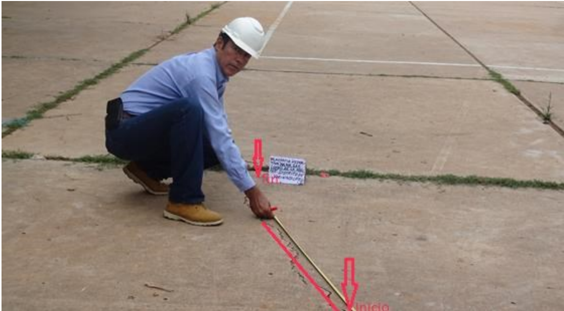
Figura N° 08 Se puede observar la presencia de falla de Grieta lineal en la plataforma deportiva del AA.HH. Las lomas de la Molina.
