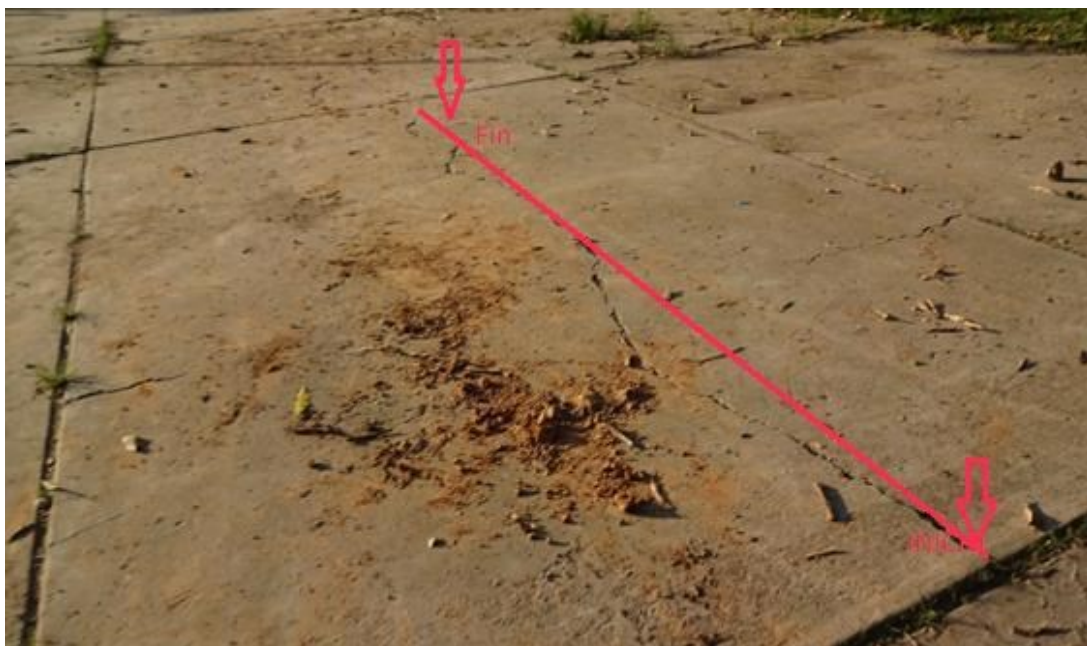
Figura N° 14 Se puede observar la presencia de falla de Grieta lineal de la plataforma deportiva del AA.HH Miraflores.
