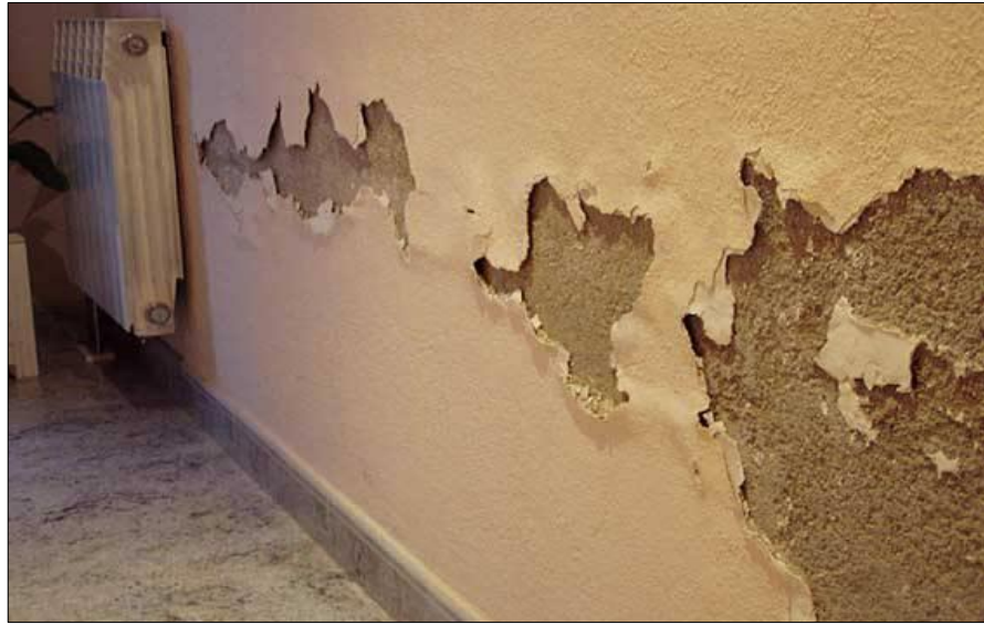
Figura 12: Descascaramiento del concreto en la pared de una vivienda.
