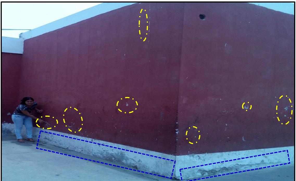
Fotografía 08- Unidad muestral 11 del pabellón F de la Institución Educativa “Republica Peruana”.
