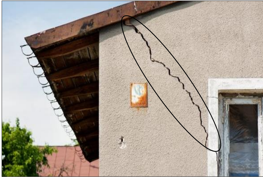
Figura 07: Grieta longitudinal en una vivienda.
