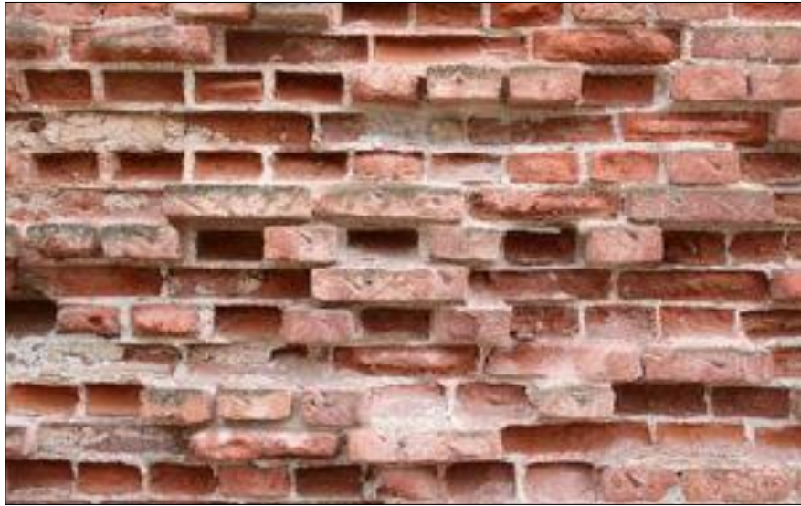
Figura 11: Erosión del material de ladrillo en una fachada.
