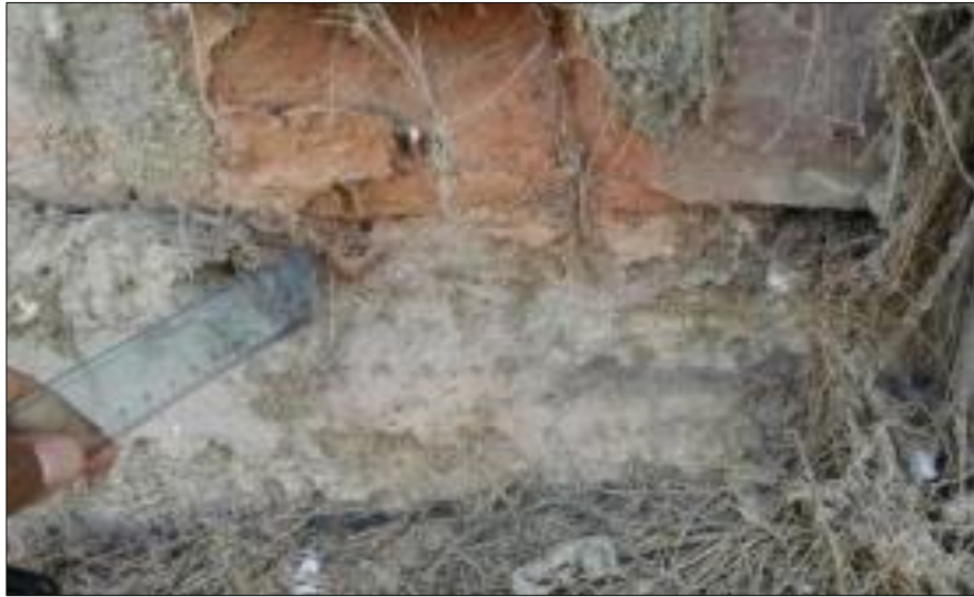
Figura 10: Disgregamiento en muros de albañilería confinada.
