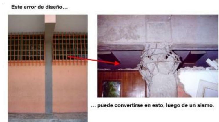
Figura 65, Falla típica de columna corta
