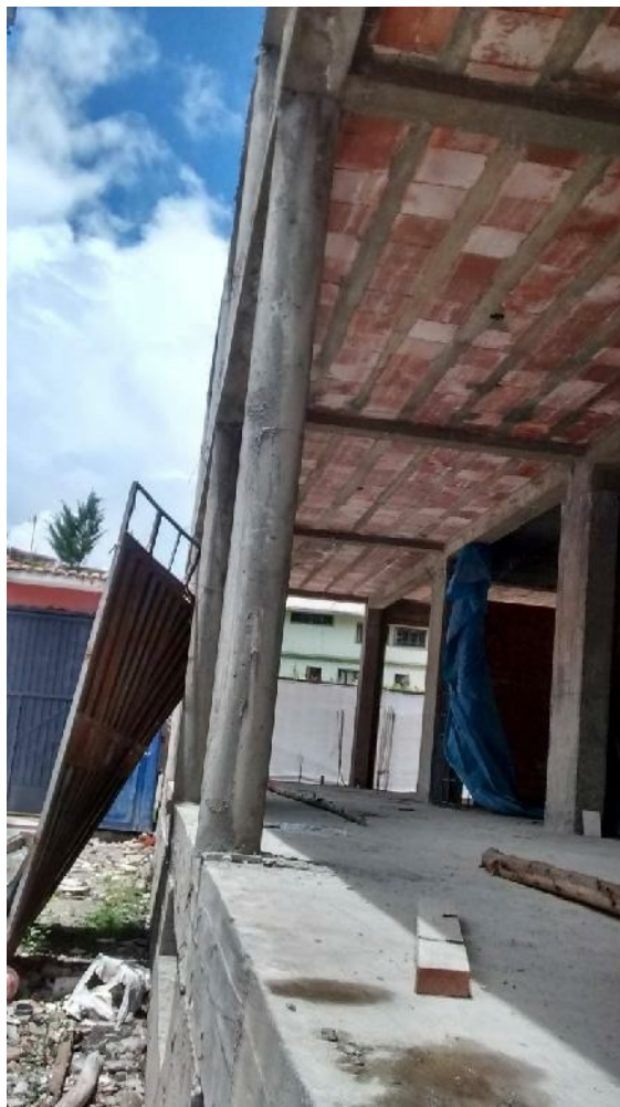
Figura 153. Desplome de columna
