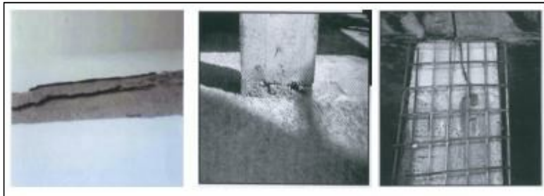
Figura 36, Ejemplo de patologías en elementos estructurales
