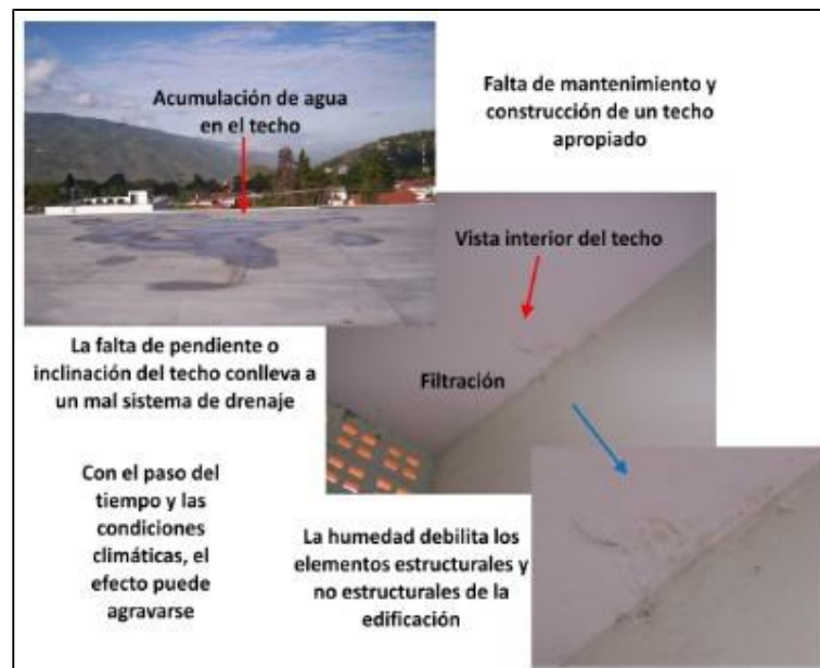
Figura 67, Filtraciones que causan humedad en techo.
