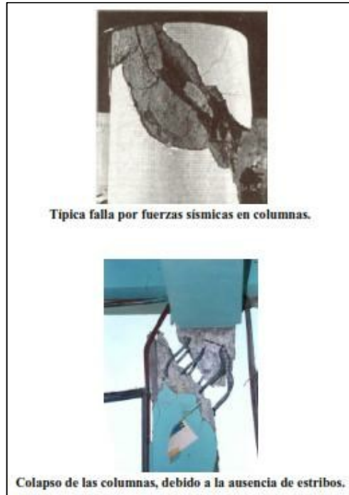
Figura 51, Fallas de columnas por carencia de acero
