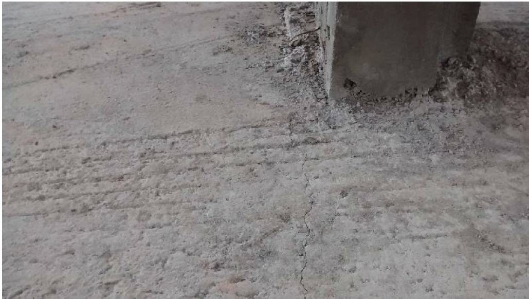
Figura 161. Vista de fisura en losa aligerada
