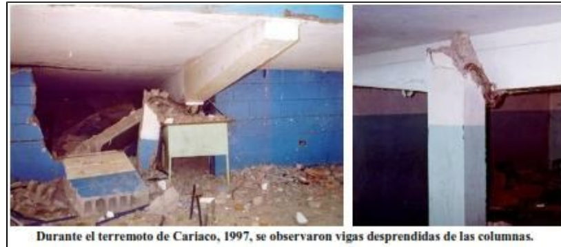
Figura 55, Imagen de vigas desprendidas de las columnas
