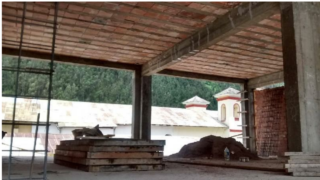
Figura 157. Vista de la viga en las zonas de agrietamiento
