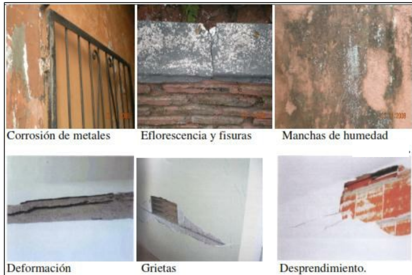
Figura 33, Ejemplos de algunas patologías
