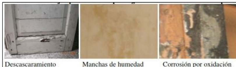
Figura 34, Ejemplo de patologías de acabados o lesiones menores (01)
