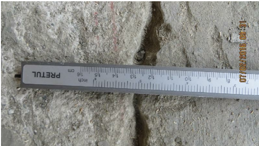
Figura 159. Grieta en la losa aligerada
