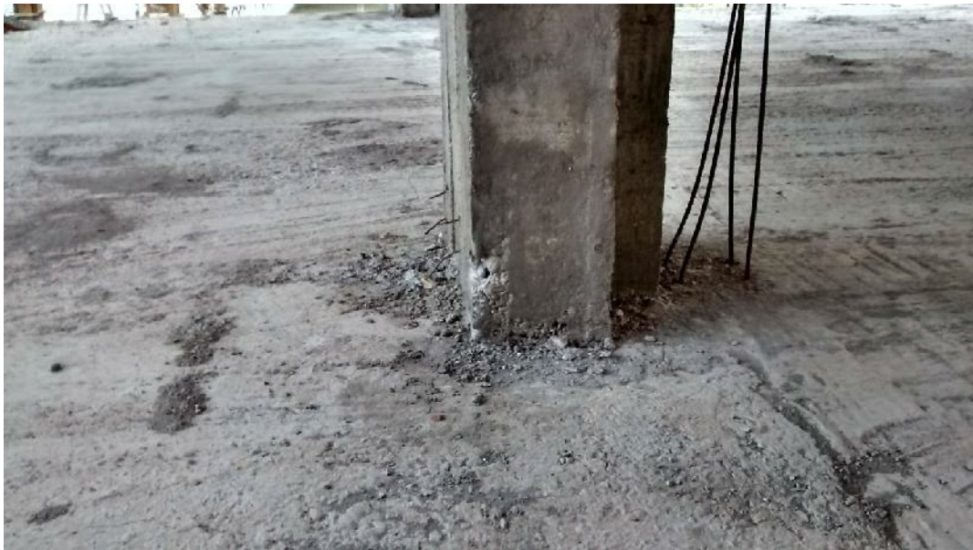
Figura 151. Vista de picaduras
