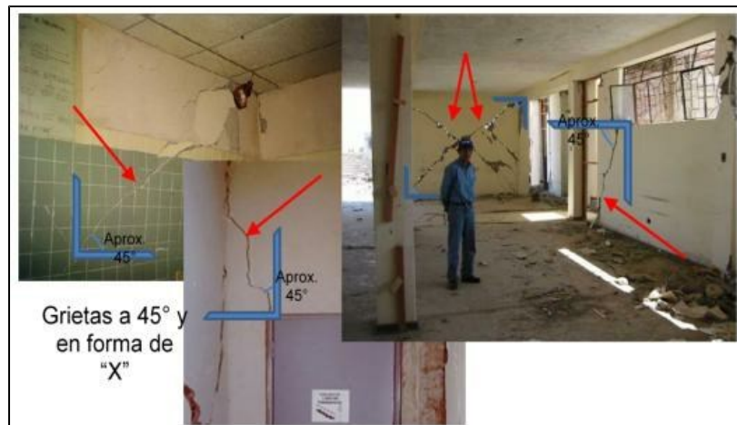
Figura 50, Grieta típica originada en tabiquerías por eventos sísmicos
