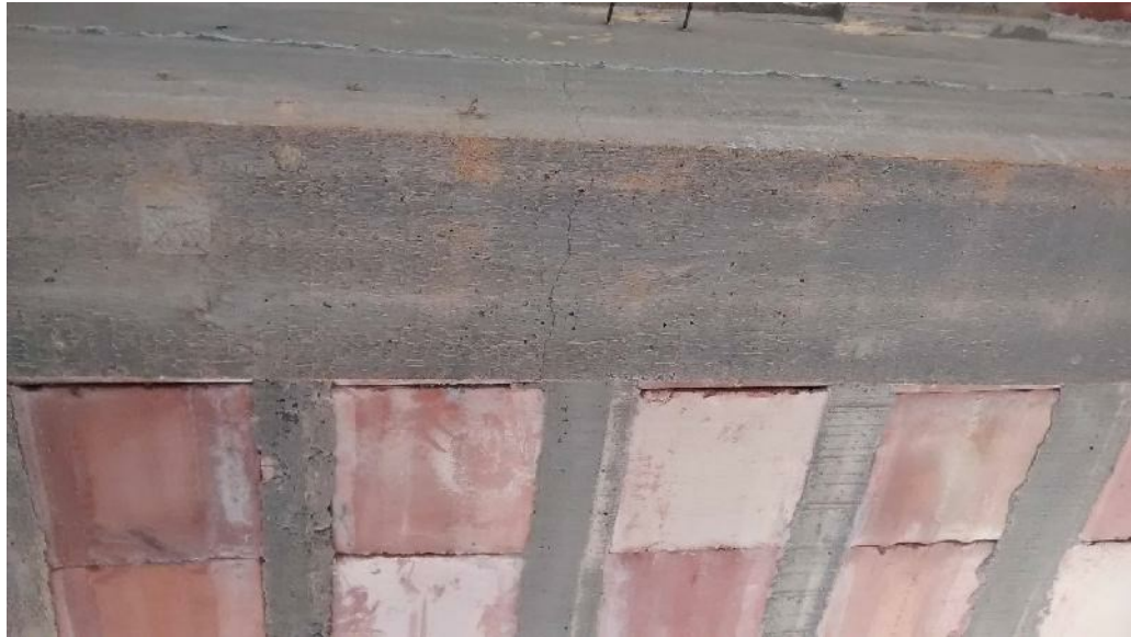
Figura 156. Vista de fisuras en las vigas
