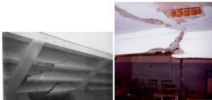
Figura 52, Fallas de viga por tensión diagonal
