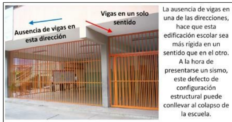
Figura 54, Imagen de ausencia de vigas
