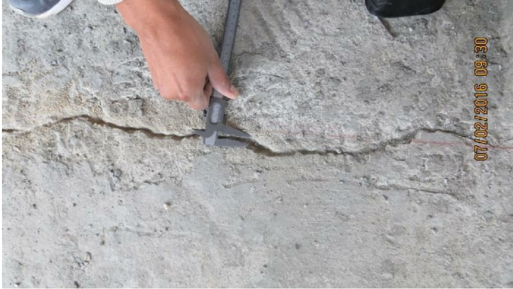
Figura 160. Vista de grietas en losa aligerada
