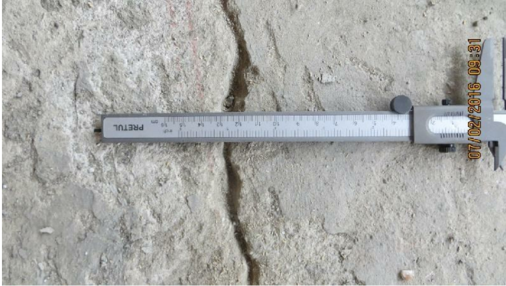
Figura 158. Grieta en la losa aligerada
