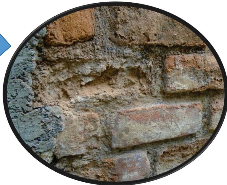
Fotografía 03: Erosión en muro del cerco perimétrico del centro educativo inicial 320 San Miguelito Arcángel.
