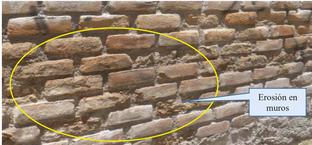
Figura 08: Erosión en muro Fuente: Elaboración propia (2017).
