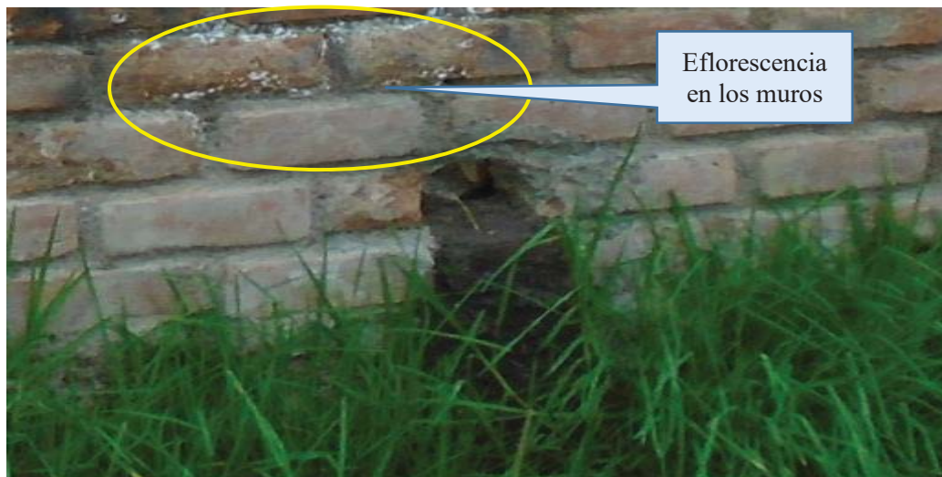
Figura 11: Eflorescencia en los muros.
