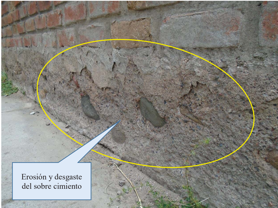
Fotografía 05: Erosión y desgaste del muro y sobrecimiento en el cerco perimétrico del centro educativo inicial 320 San Miguelito Arcángel.
