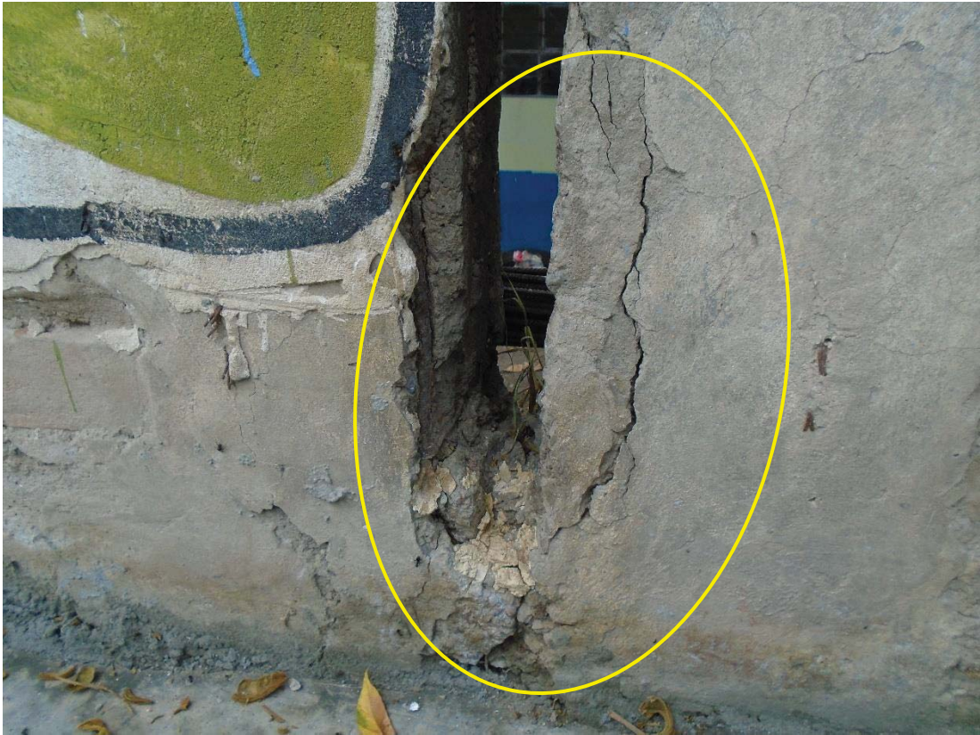
Fotografía 10: Grieta en muro del cerco perimétrico del centro educativo inicial 320 San Miguelito Arcángel.
