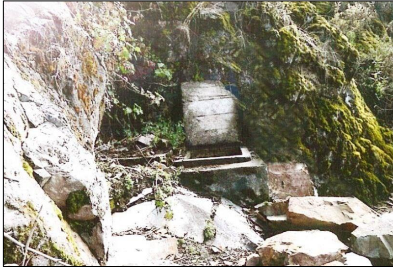
Imágen 1 Obra de captación por manantial tipo ladera de Antamarca
