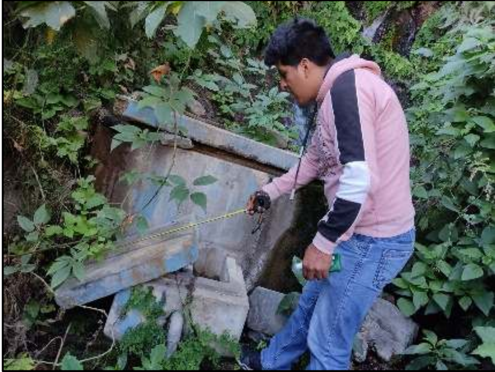
Figura N° 22: Captación del sistema
