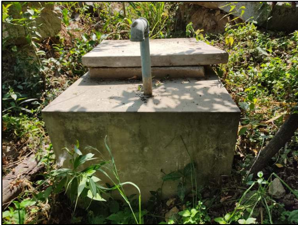
Figura N° 23: cámara rompe presión tipo 6
