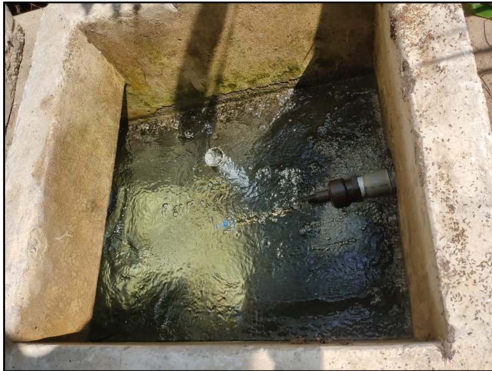
Figura N° 25: Cámara rompe presión tipo 7
