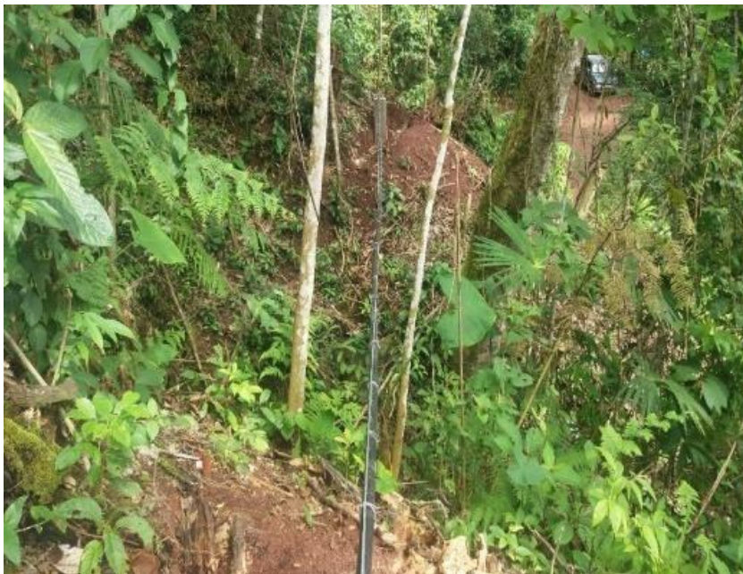
Imagen 3: Línea de conducción existente
