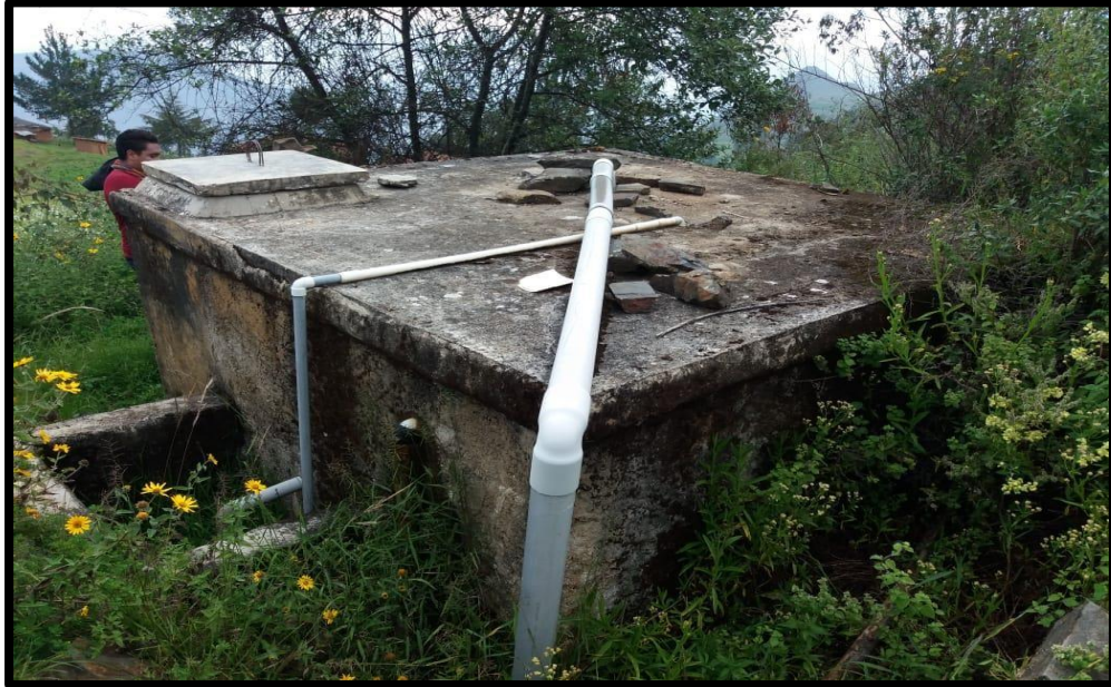
Imagen 19: Reservorio y tubería de conducción hacia el caserío de Ináco
