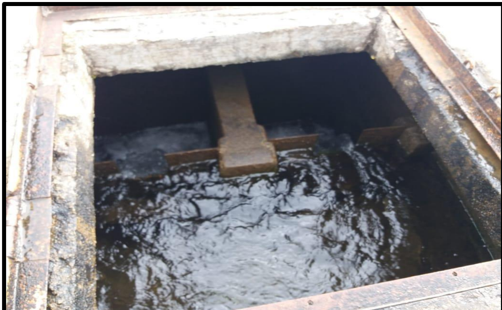
Imagen 20: Cámara de captación en malas condiciones y agua turbia.
