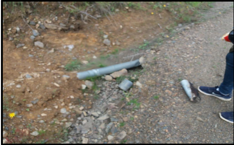
Imagen 21 : Tubería de aducción hacia la red de distribución.
