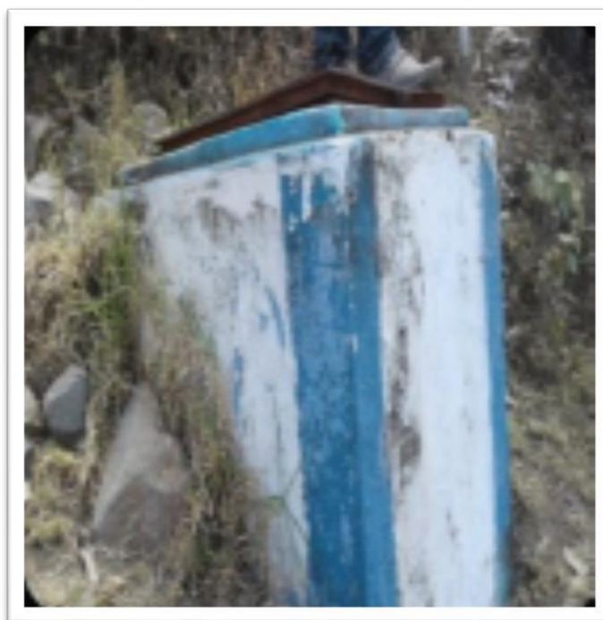
Fotografía 03: Vista del estado de unas de las Cámara rompe presión tipo-6 N° 01, ubicados en tramo de la línea de conducción desde la captación del centro poblado de Chacchan, distrito Pariacoto, provincia Huaraz, región Ancash – 2022.
