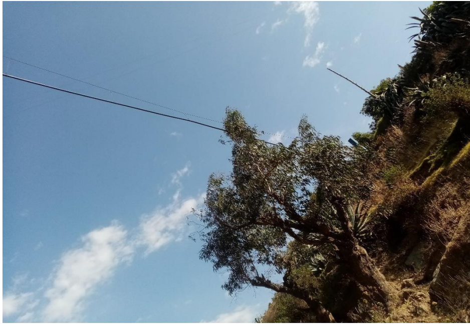
Fotografía 05: Vista del pase Aéreo con columnas de concreto y tubería flexible sujetadas con cable de acero de reciente instalación sin embargo carece de un envoltorio para su conservación de la tubería de conducción del centro poblado de Chacchan, distrito Pariacoto, provincia Huaraz, región Ancash – 2022.
