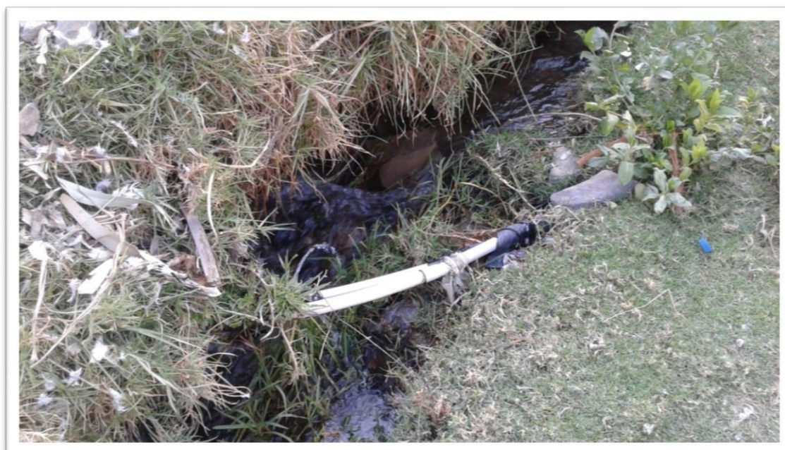
Fotografía 04: Vista de la tubería de la Red de conducción expuesta y se observa el estado de una parte de la red con filtraciones que genera pérdidas de cargas por desperdicios del agua del centro poblado de Chacchan, distrito Pariacoto, provincia Huaraz, región Ancash – 2022.
