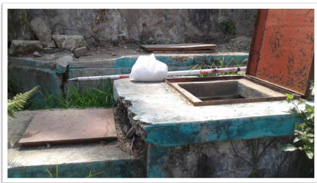
Fotografía 02: Vista del estado deteriorado la estructura de la Cámara de Captación QUEMISHPAMPA del centro poblado de Chacchan, distrito Pariacoto, provincia Huaraz, región Ancash – 2022.
