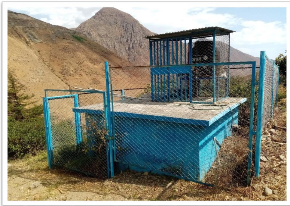
Fotografía 06: Vista del estado del reservorio remozado reciente sin embargo hay presencia de filtraciones por los cuatro lados fue implementado el sistema de desinfección y el cerco de protección a inicios del año 2022 del centro poblado de Chacchan, distrito Pariacoto, provincia Huaraz, región Ancash – 2022.
