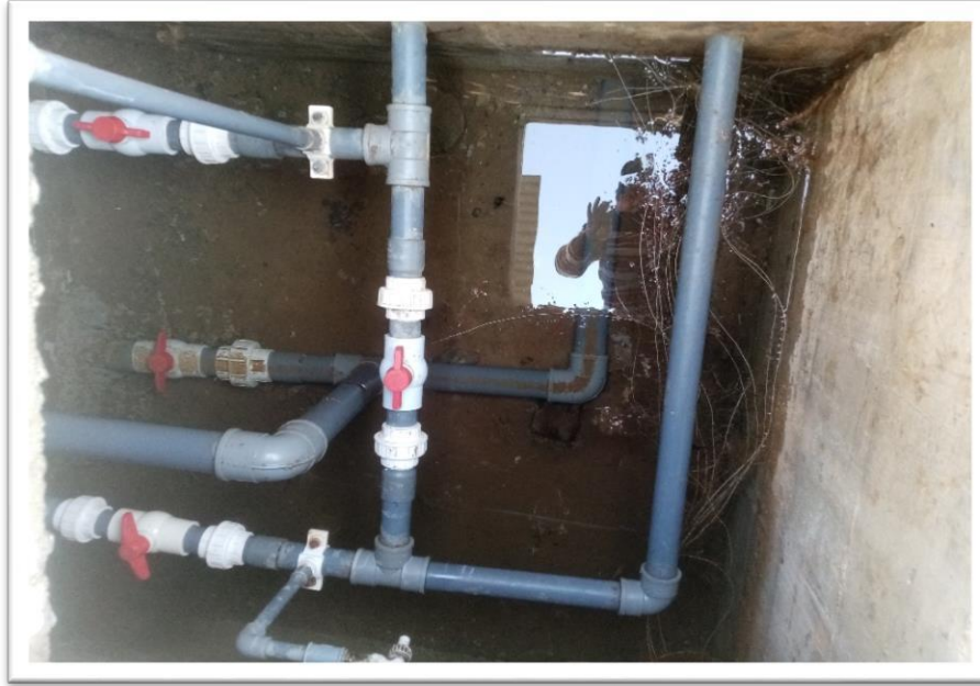
Fotografía 07: Vista al interior del estado de la caseta de válvulas del reservorio renovado reciente todas las tuberías y accesorios en buen estado sin embargo hay presencia de filtraciones por instalación al cruzar las tuberías que ocasiona inundación en la caseta y el reservorio perdida de estanqueidad del centro poblado de Chacchan, distrito Pariacoto, provincia Huaraz, región Ancash – 2022.
