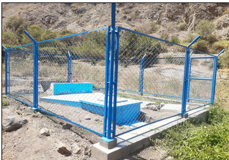
Fotografía N° 02: Captación de agua potable de San Damián Fuente: Elaboración propia
