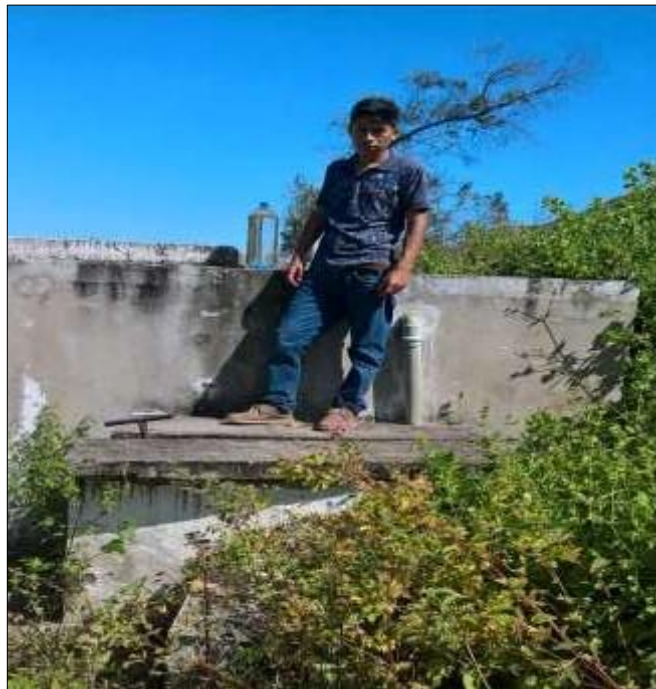
Figura 7. Reservorio existente en mal estado.
