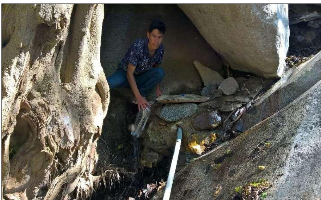
Figura 5. Fuente de captación del caserío de Yapacayan en mal estado
