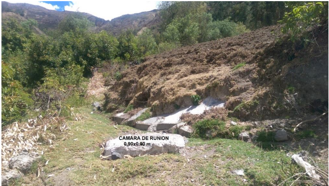
Imagen 06. Se aprecia Captación 02, no presenta cerco perimétrico
