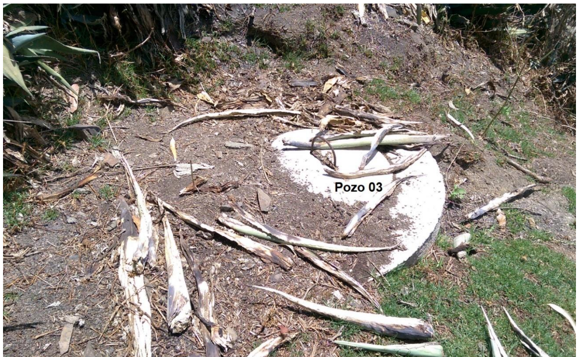
Imagen 20. Pozo de percolación 03; concreto simple de 1.45m de diámetro, 0.60 m de tapa.
