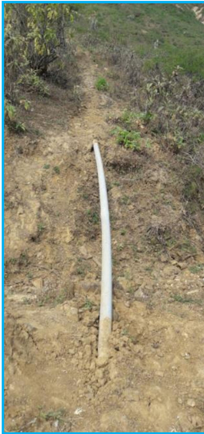
Figura 20. Línea de conducción del caserío San Felix
