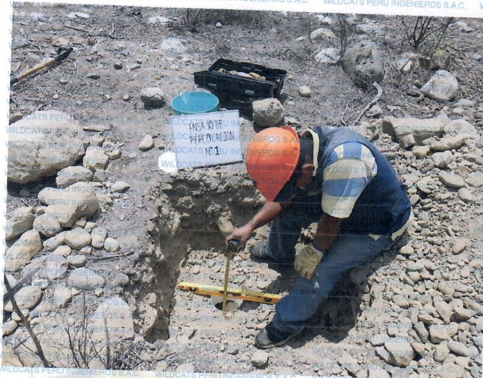
ENSAYO DE PERCOLACION N° 01 - CAMARA DE TRATAMIENTO-TANQUE SEPTICO-POZOS DE PERCOLACION (Calicata C-9)
