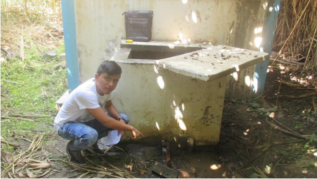
Fotografía 03: salida de la línea de conducción de 2",
