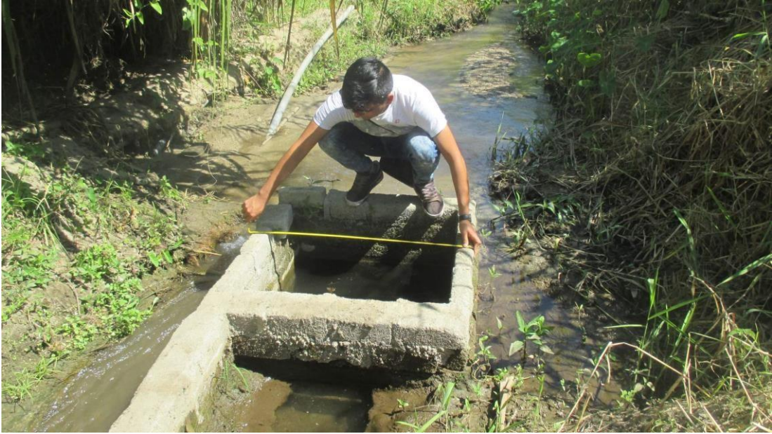
Fotografía 01: cámara de captación de fondo en mal estado
