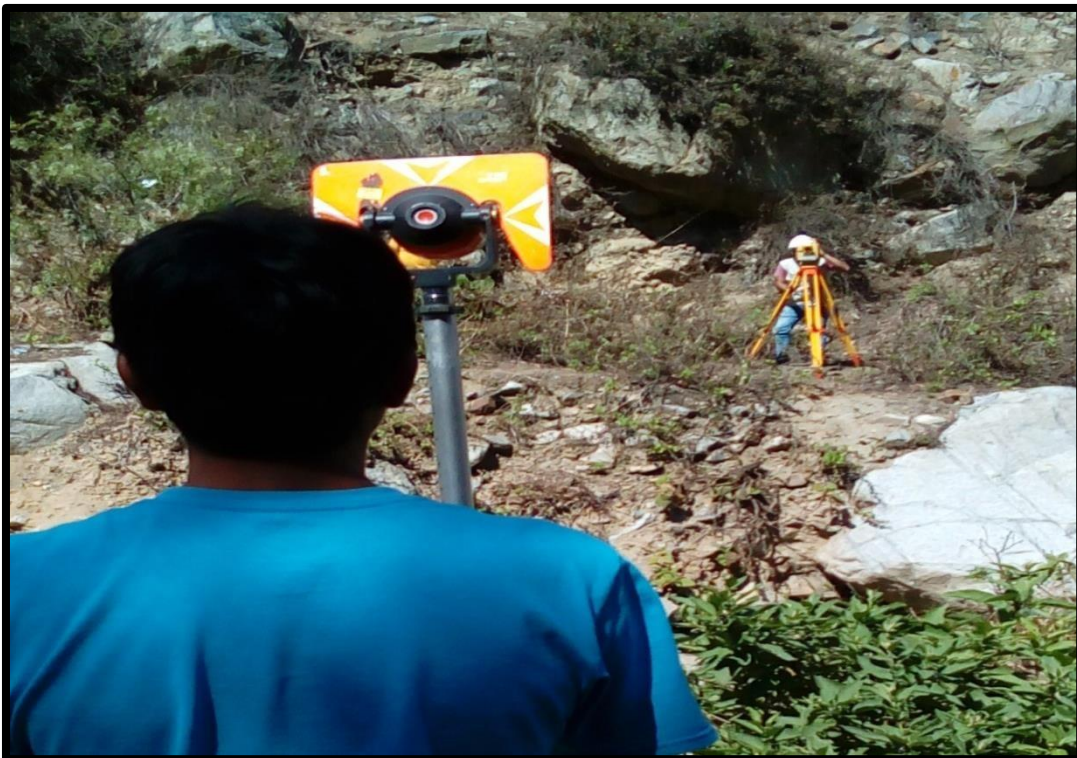
Figura 13: Punto en la cámara de captación
