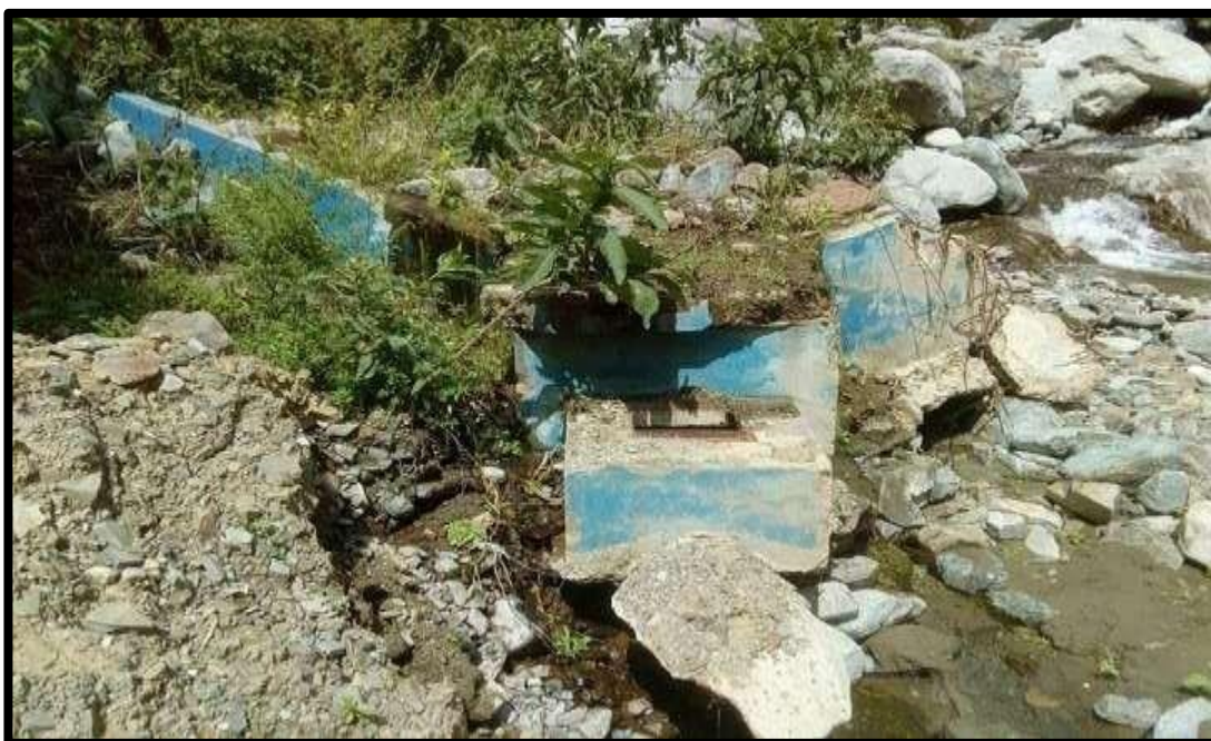
Figura 8: Cámara de captación del caserío de Huanchuy sector A en un mal estado causados por huaicos.
