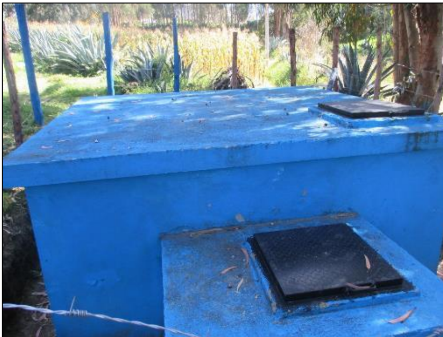
Foto N°6. Falta de Cerco Perimétrico en buenas condiciones para el Reservorio.
