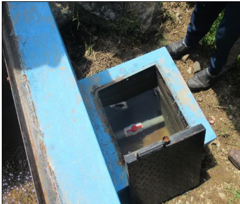
Foto N°4. La Cámara de Válvulas, llenas de agua, existe fugas en los accesorios instalados.
