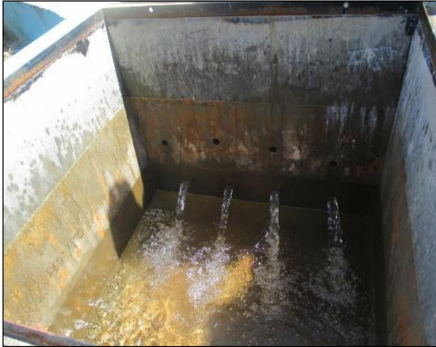
Foto N°3. La Cámara Húmeda; los lloraderos no se encuentran adecuadamente ubicados.
