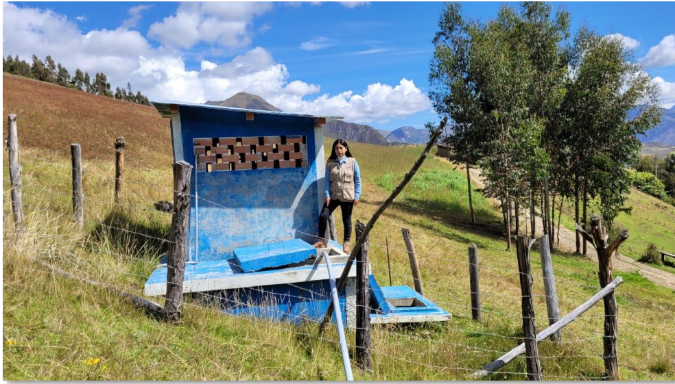
Imagen 06: Vista lateral del reservorio se presenta que el cerco perimétrico con alambres oxidados y palos deteriorados.
