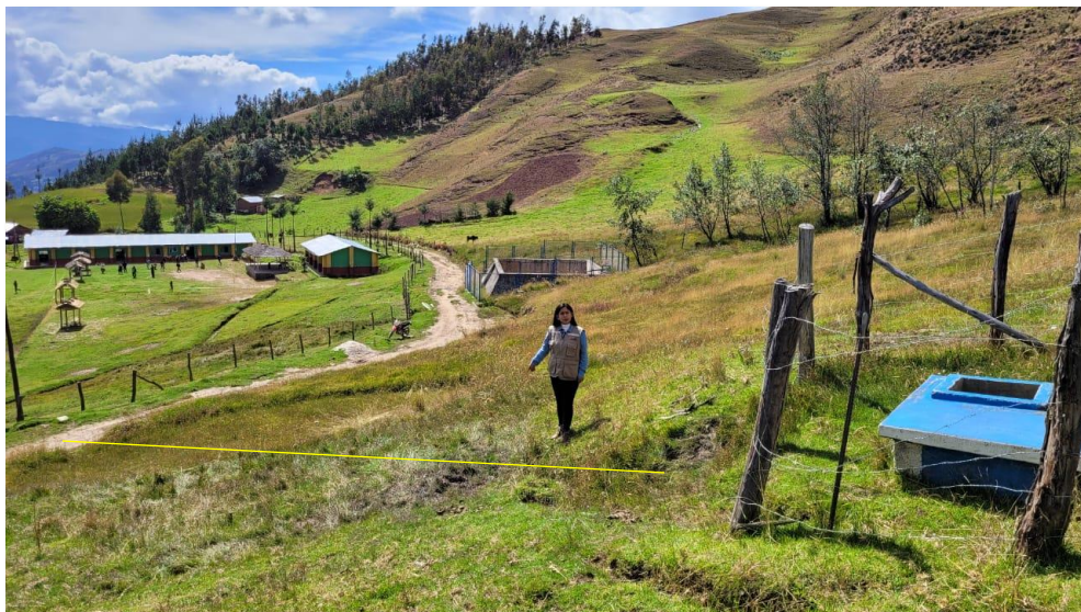
Imagen 11: Vista de la línea de aducción que se encuentra semi enterrada.
