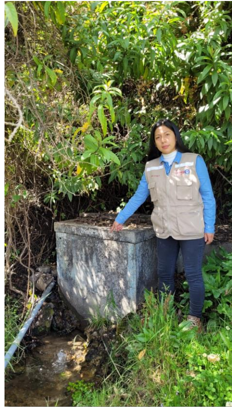
Imagen 02: Vista de la cámara húmeda, se muestra su estructura está deteriorada con fisura.
