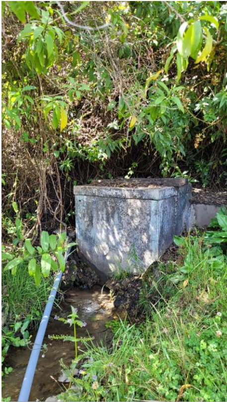
Imagen 01: Vista de la cámara de captación Chaupalliso que se encuentra en mal estado por su culminación de su vida útil.
