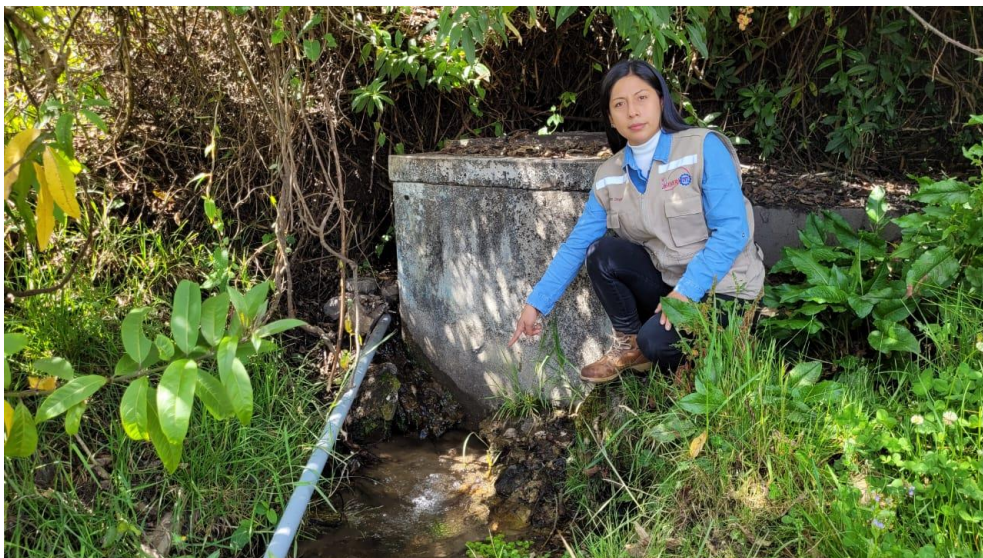
Imagen 03: Vista lateral donde se observa que hay pérdida de agua y no garantiza el buen servicio del agua potable.
