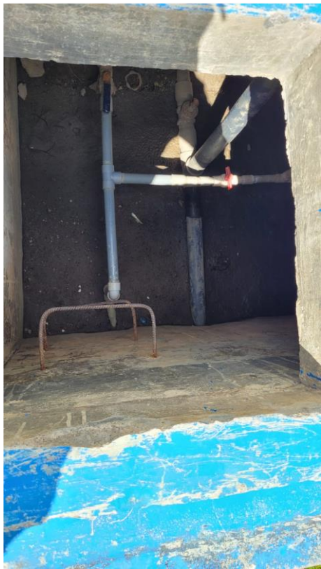
Imagen 09: Vista de los accesorios de la caseta de válvulas que se encuentra en mal estado.
