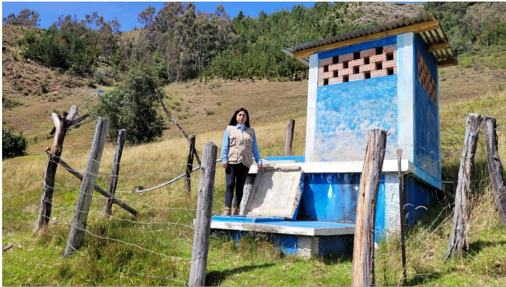
Imagen 07: Vista frontal del reservorio, donde presenta su estructura con deficiencia.
