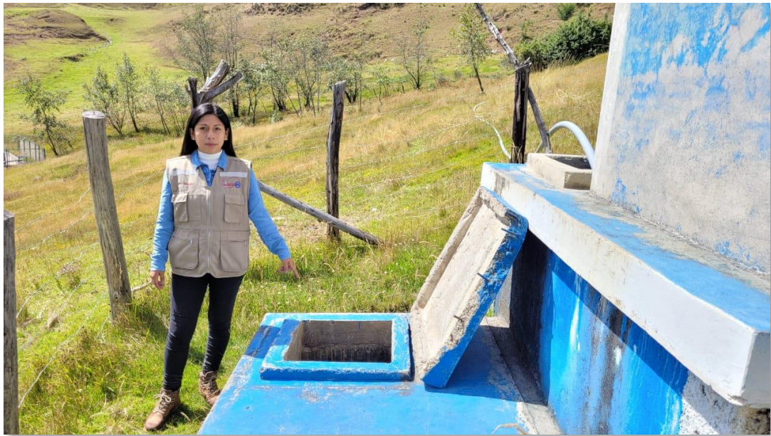
Imagen 08: Vista lateral de la tapa sanitaria de la caseta de válvula de concreto con fisuras.
