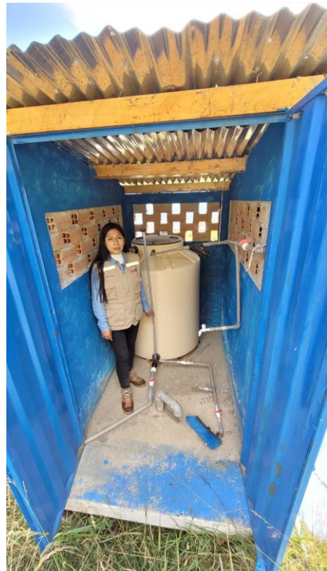
Imagen 10: Vista de la caseta de cloración trabaja de manera regular, debido a que no hacen un adecuado mantenimiento.
