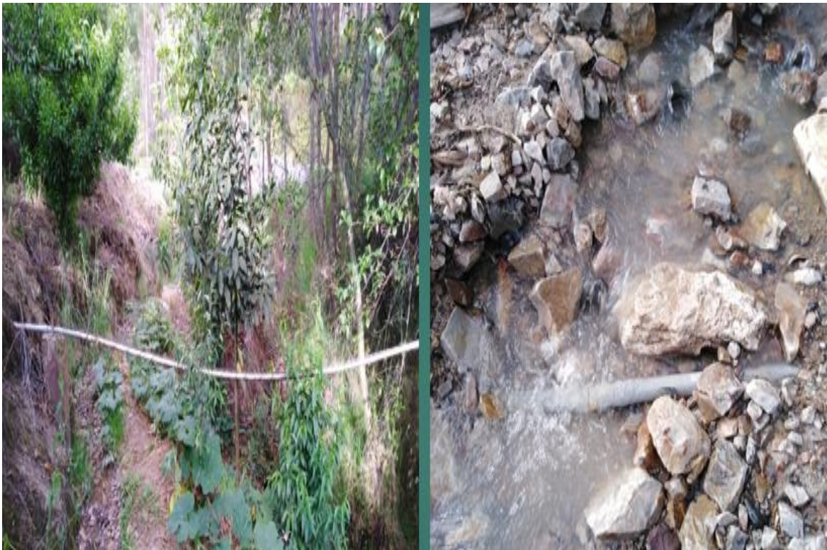
Fotografía N° 06. Tubos al intemperie-Línea de conducción
