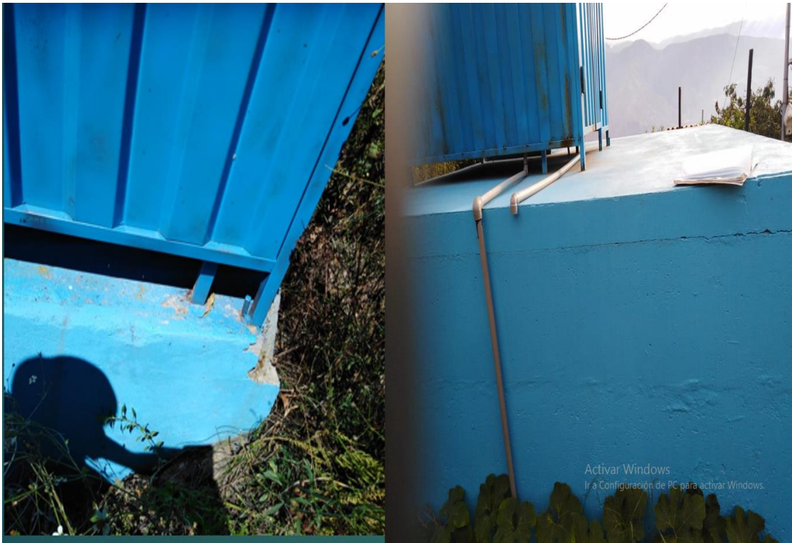
Fotografía N° 05. Patologías del concreto. fisuras y agrietamientos
