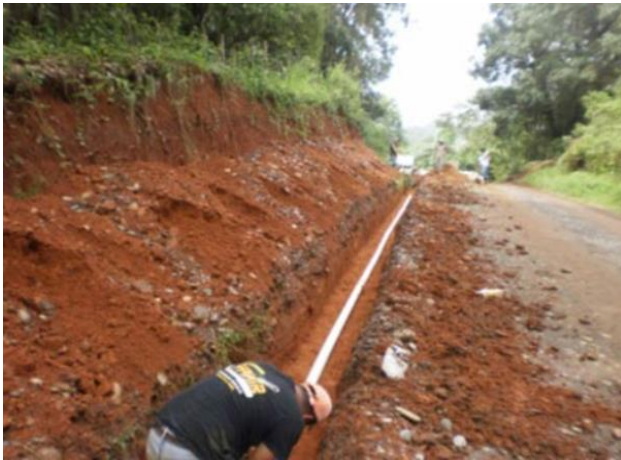
Figura 27: línea de conducción
