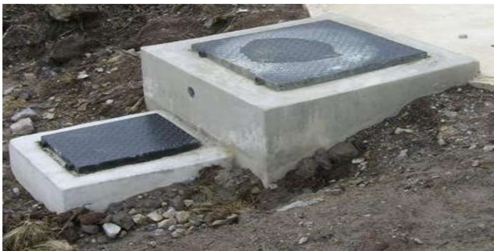
Figura 30:observando cámara de rompe presión
