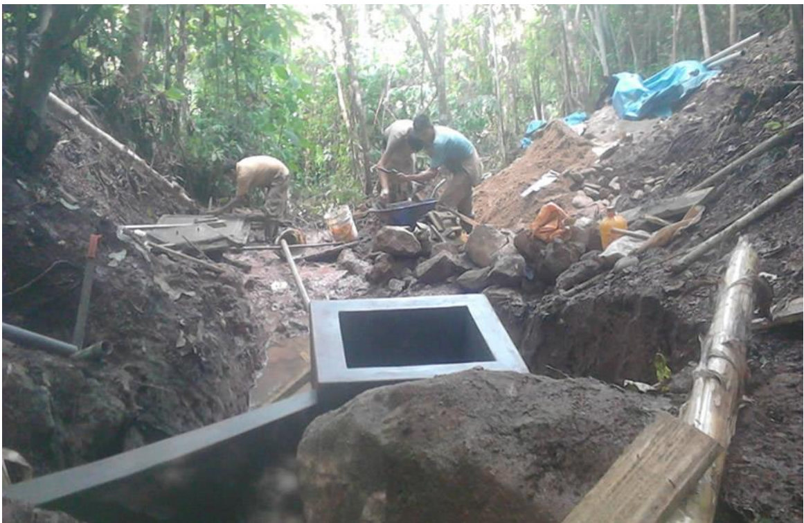
Figura 23: captación del Centro Poblado Catarata.
