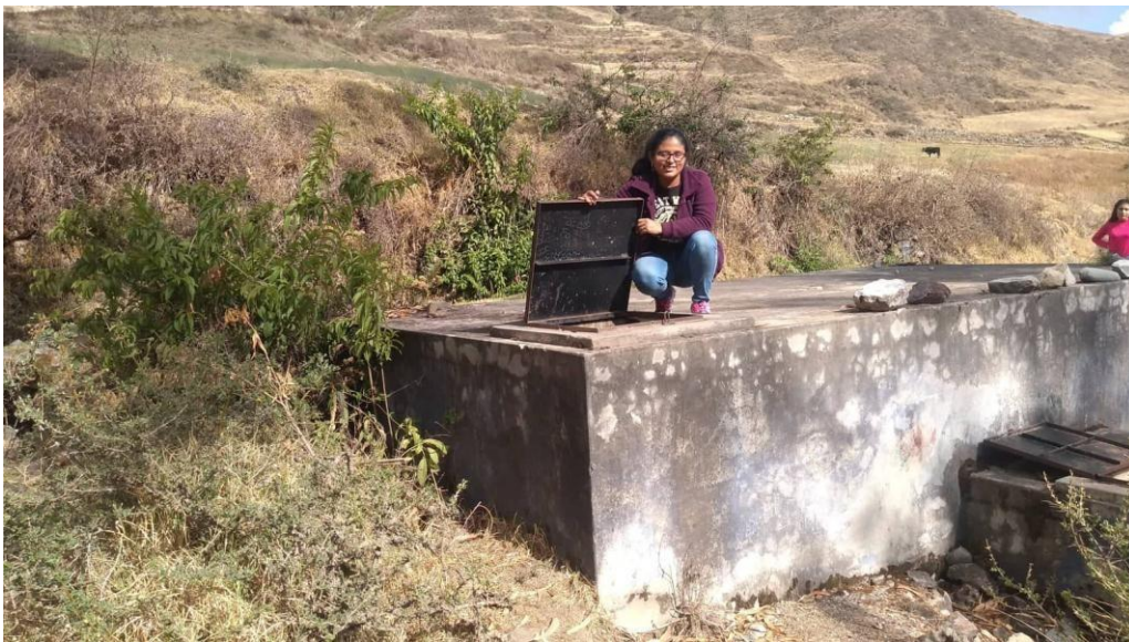
Imagen N° 2: Reservorio almacenamiento del sistema de abastecimiento, presenta fisuras en su estructura.
