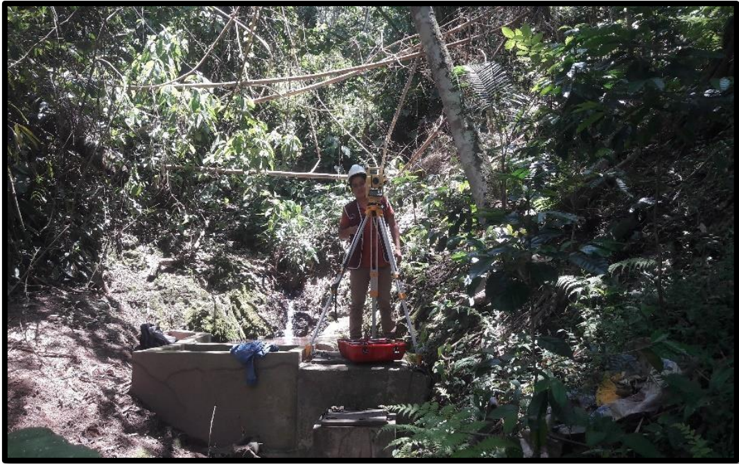
Figura 17 Línea de Conducción en mal estado
