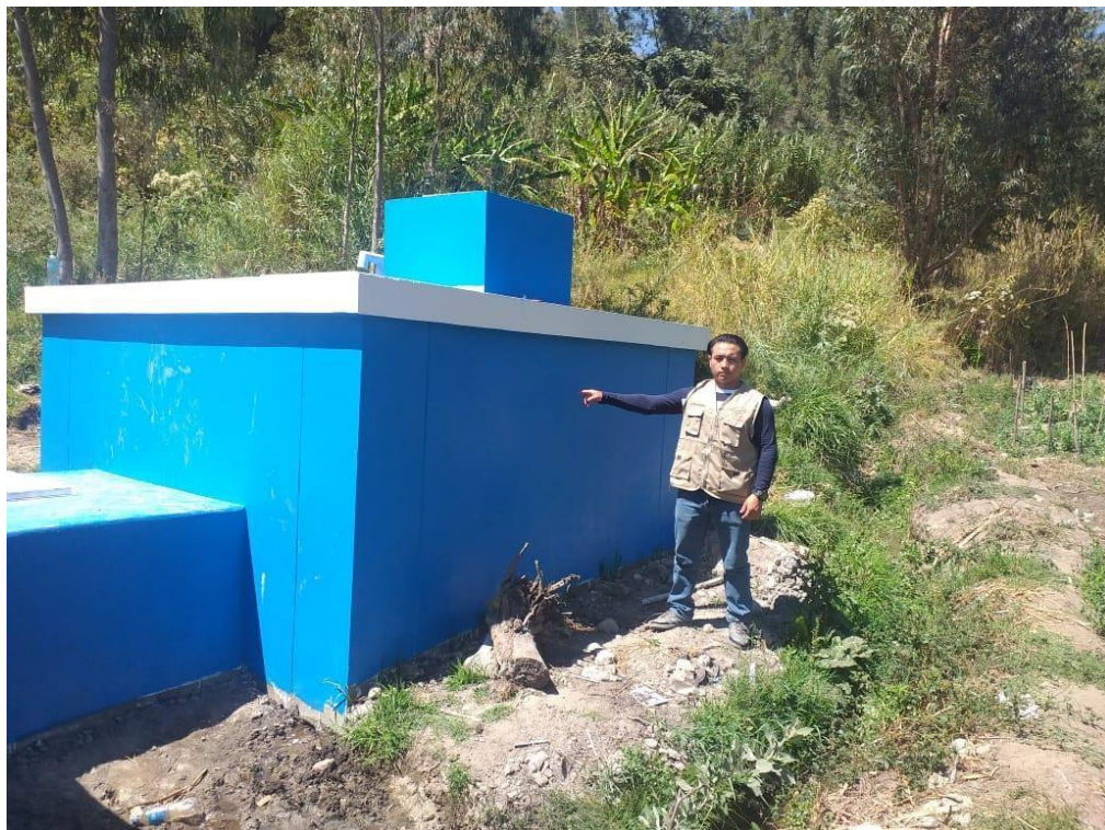
Imagen 04: Reservorio de almacenamiento del sistema de abastecimiento de agua potable del Barrio Allauca, distrito de Caraz, provincia de Huaylas, región Áncash – 2021.
