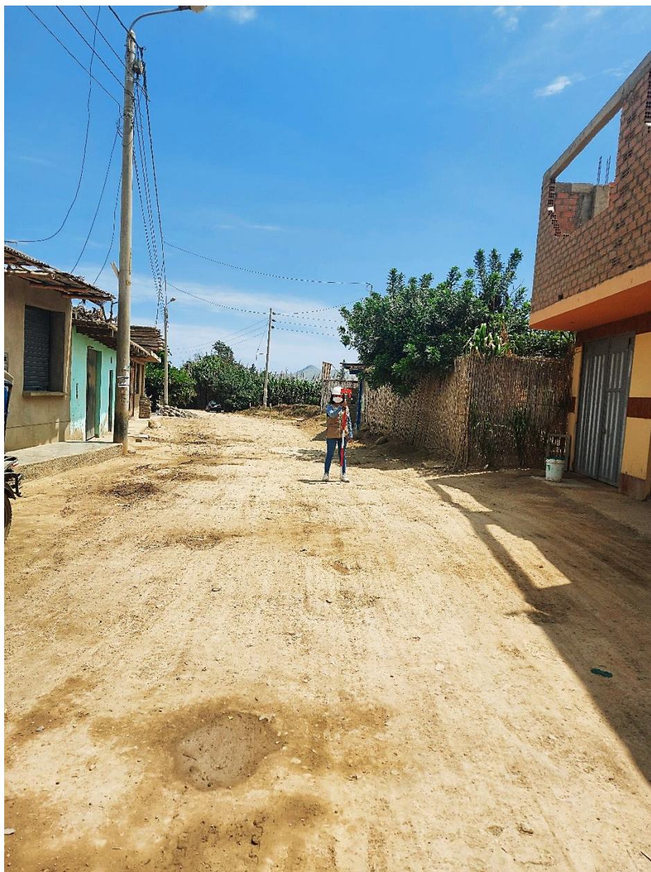
Figura 18: Siguiendo con el levantamiento topográfico en la calle principal de Cruz del Siglo.
