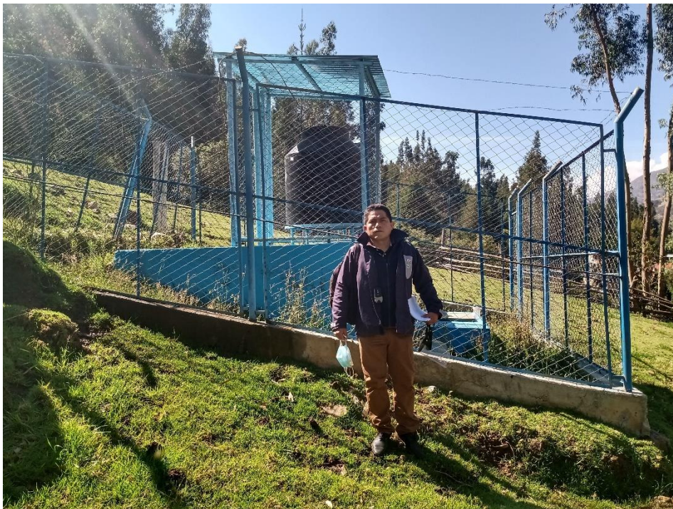
Fotografía 04: Reservorio de 20 m 3
