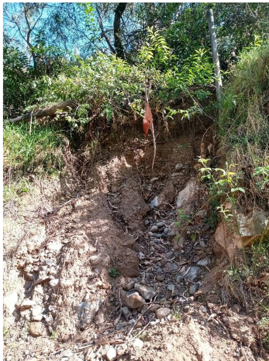
Fotografía 02: Deslizamiento de tierra en la captación.
