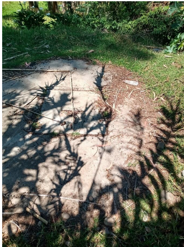
Fotografía 07: : Pozo de percolación de PTAR
