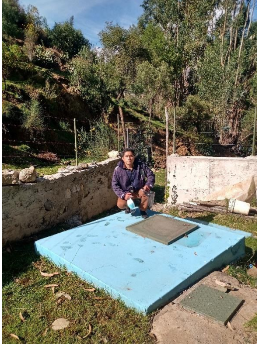
Fotografía 01: Captación del sistema de agua.
