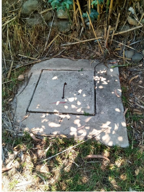
Fotografía 07: Caja de Distribución del PTAR
