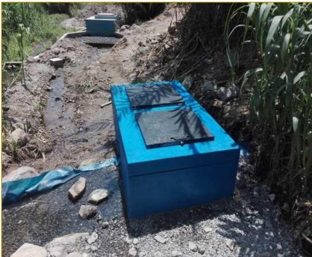
Fotografía 5: Captación de fondo de la localidad de piedra grande.
