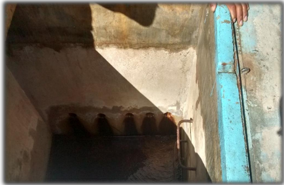
Fotografía 7. Captación Sauce Pampa
