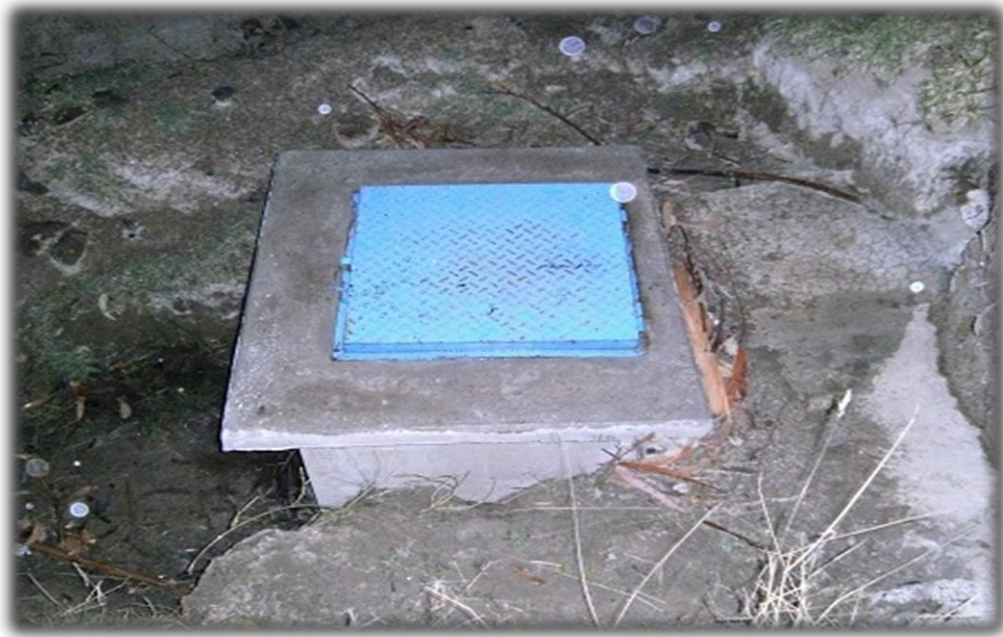
Fotografía 3. Captación Ampec Ruri II
