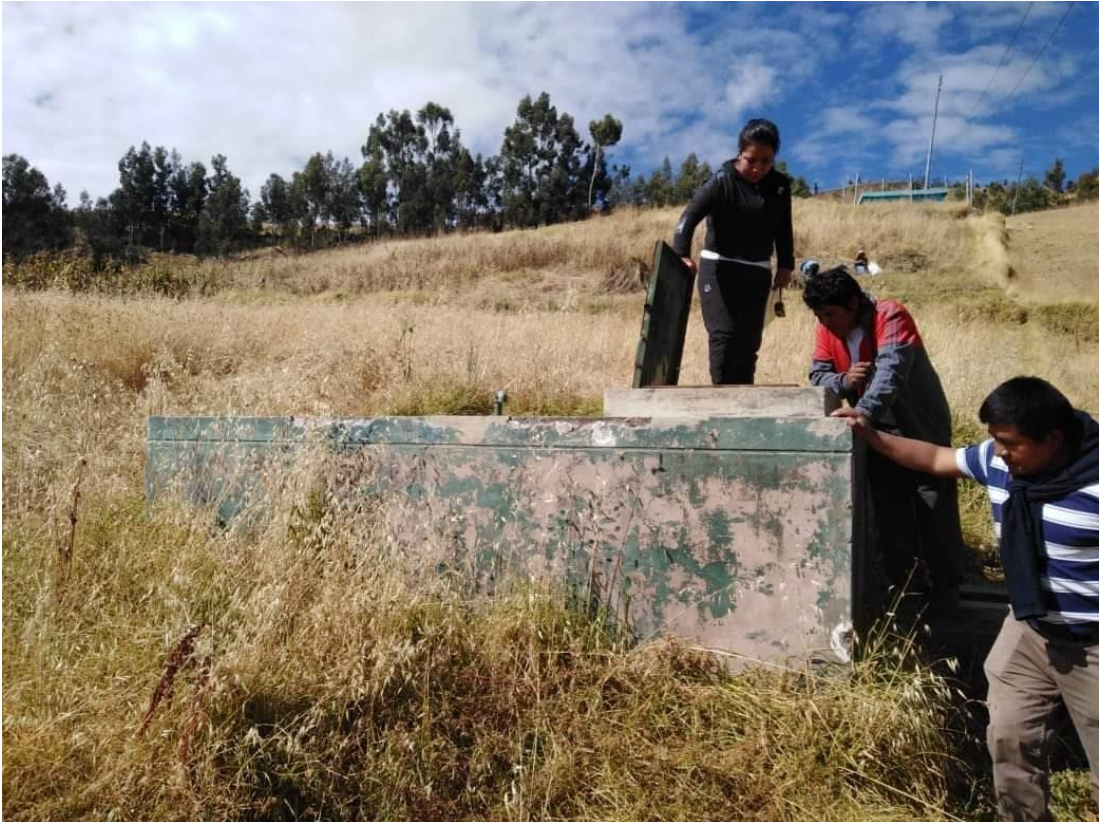
Fotografía 10. Reservorio del sistema 1
