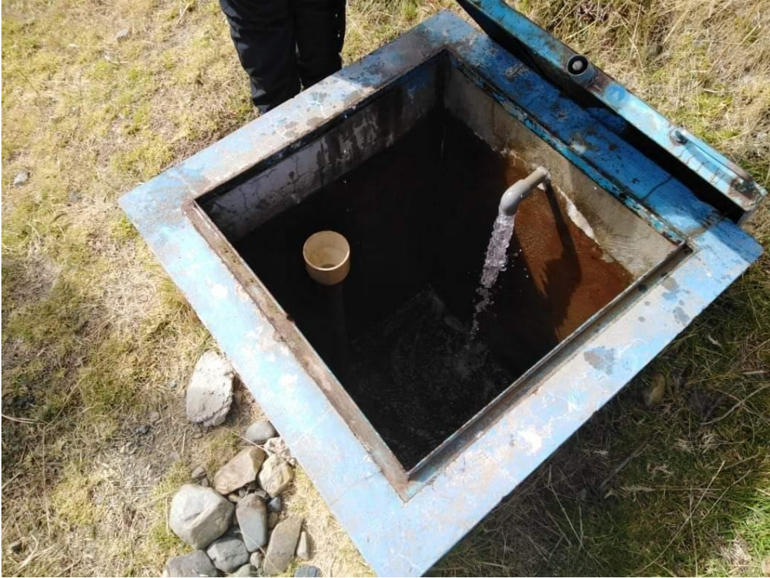
Fotografía 9. Cámara rompe presión tipo 6
