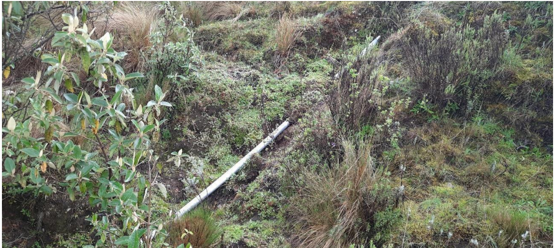
VISTA PANORAMICA DE TUBERIA DE LINEA DE CONDUCCION AL INTEMPERIE Y EN ESTADO DETERIORADO.
