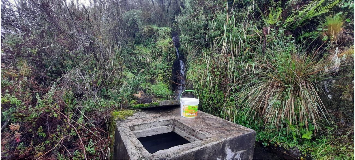
VISTA FRONTAL DE LA CAPTACION "LOS OJOS" DEL SISTEMA DE AGUA – CHALLAPUQUIO, CUALUTO
