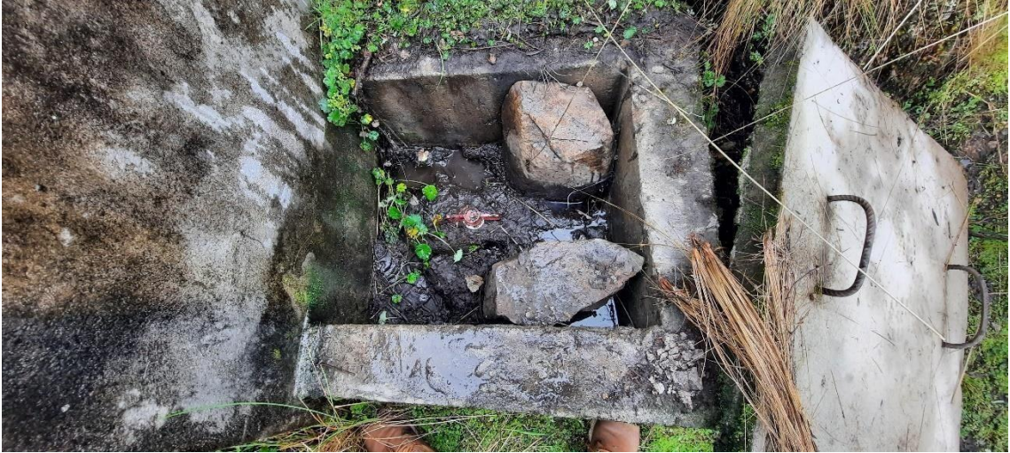
CAJA DE VALVULAS EN LA SALIDA DEL RESERVORIO, ESRTUCTURA EN ESTADO DETERIORADO
