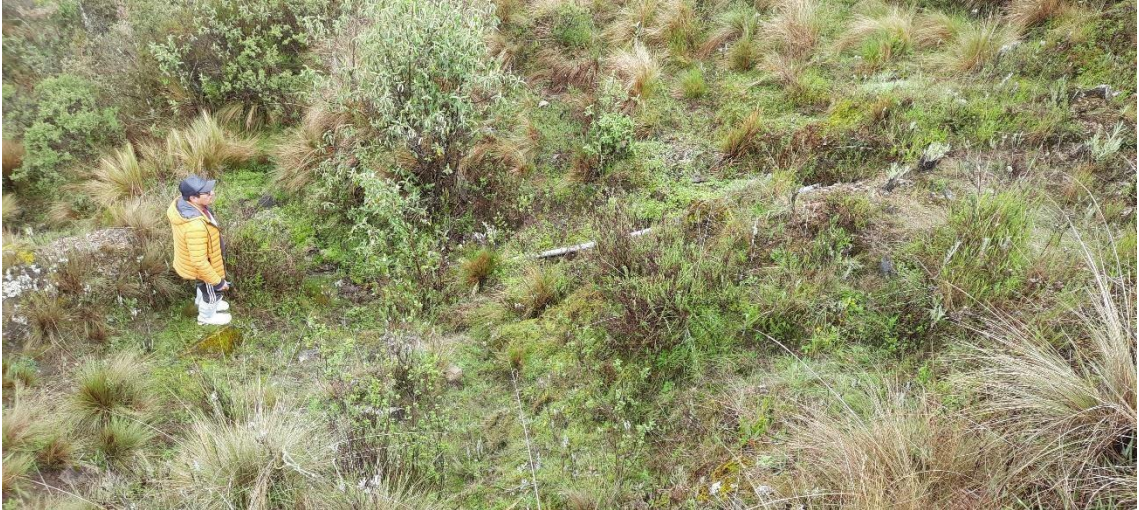
VISTA DE LA TUBERIA AL AIRE LIBRE DE LA RED DE CONDUCCION DEL SISTEMA DE AGUA POTABLE
