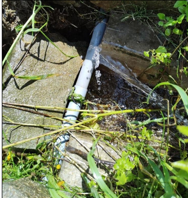
Imagen 07. Línea de aducción con fisuras de filtración
