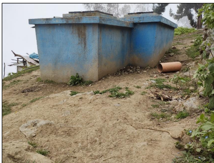
Imagen 05. Caseta de válvulas
