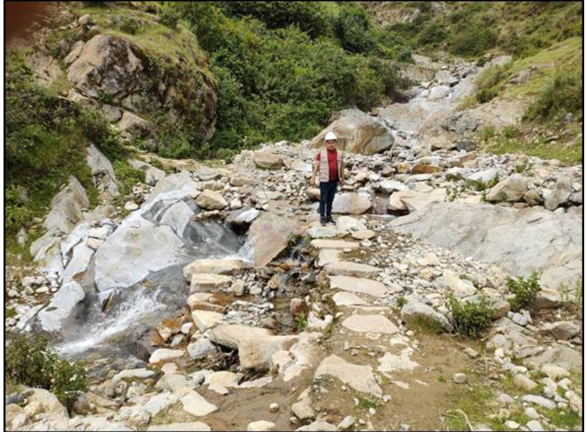
Imagen 01. Captación de manantial de ladera (Toma Hurán)
