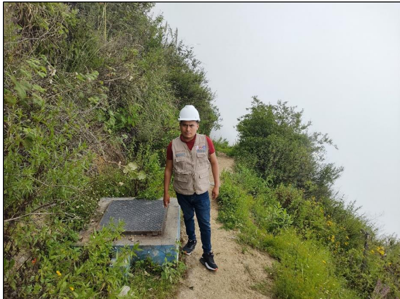
Imagen 04. En la zona de la válvula crp 6
