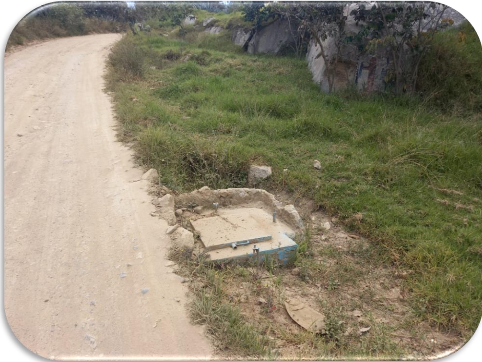
Vista de caja de purga y limpieza 01.
