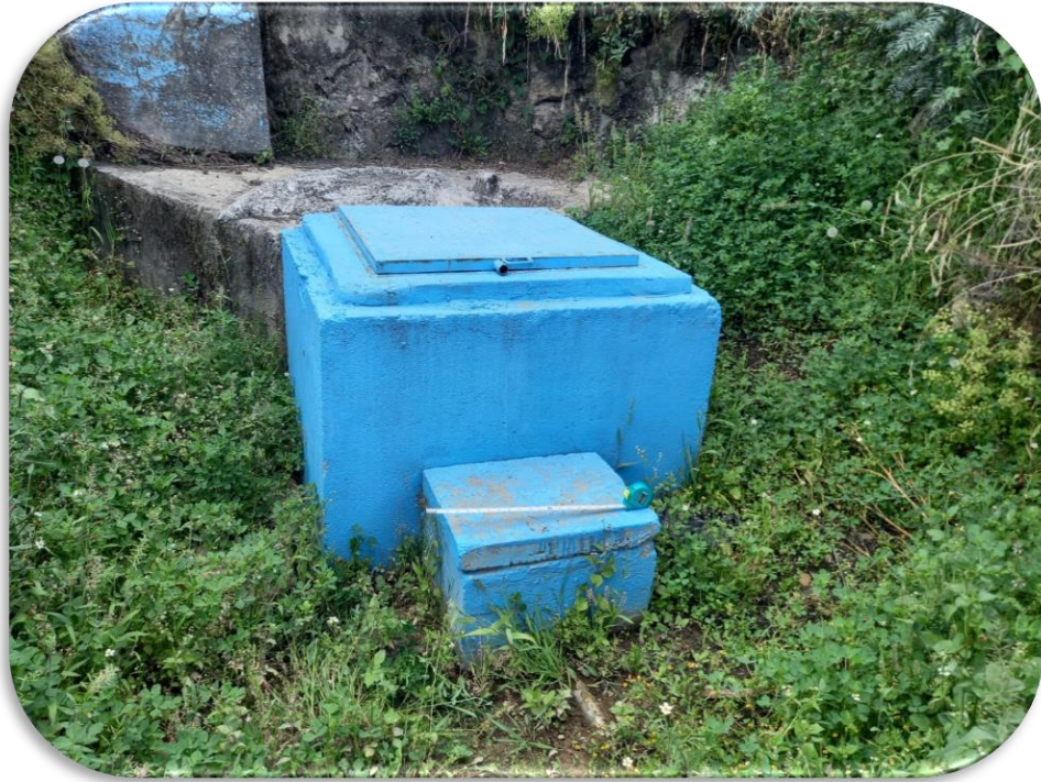
Vista captación subterránea.
