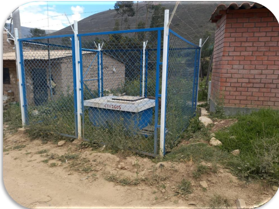
Vista de caja rompe presión 02 (CRP-2).
