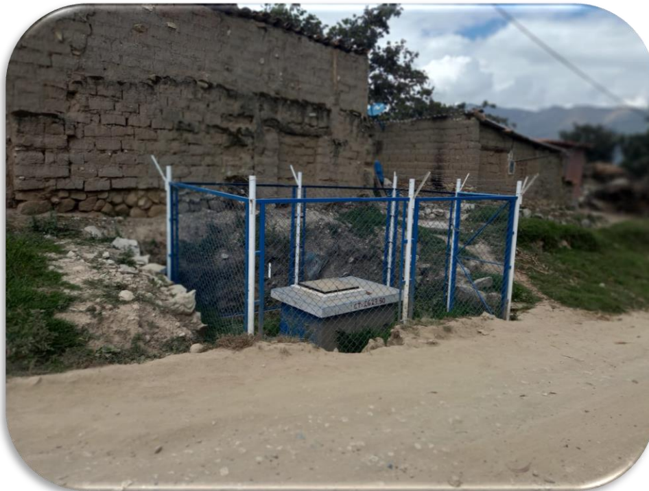
Vista de caja rompe presión 01 (CRP-1).
