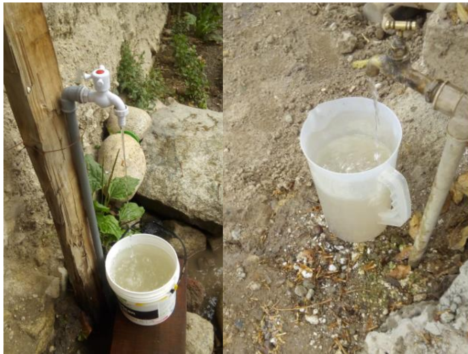
Agua potable con coloración oscura por presencia de tierra en la red e instalaciones de agua potable y presión mínima en la red de distribución de agua.
