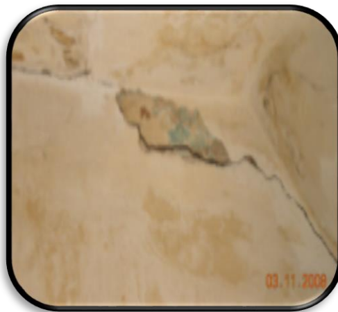
Imagen 22: Tipo de Patologías / Fisuras
