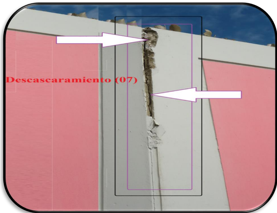
Fotografía 05: Presencia de patología, descascaramiento (07) con un nivel de seguridad media en la junta de separación entre paños. (Unidad de muestra U10)
