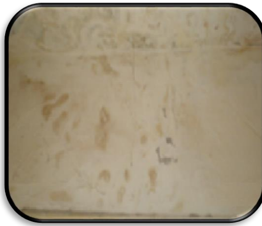
Imagen 13: Tipo de Patologías / Eflorescencia
