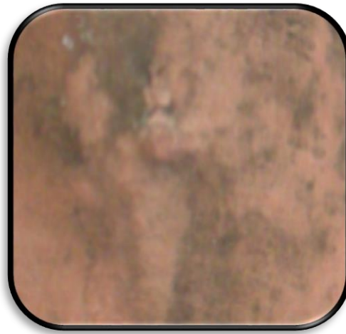
Imagen 11: Tipo de Patologías - Manchas
