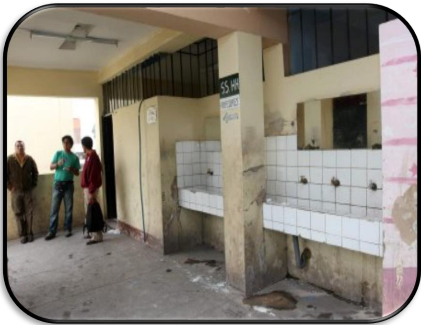
Imagen 02: Evaluación de las patologías del concreto en los muros del SS.HH. de la I.E. Ignacio Merino N° 89002 primera etapa del distrito de Piura
