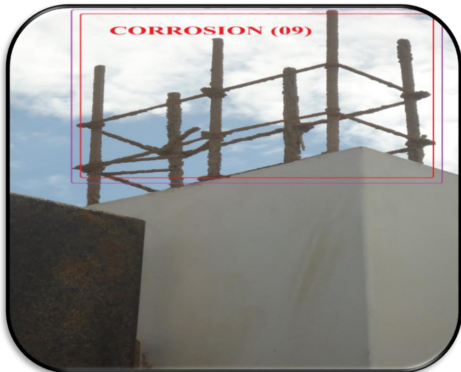
Fotografía 07: Columna con daño patológico de corrosión (09) en las 06 varillas. (Unidad de muestra U15.)
