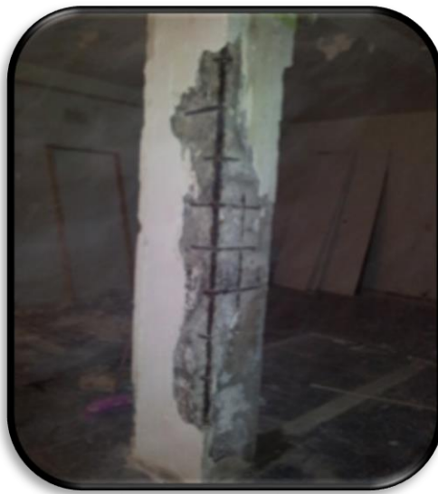
Imagen 21: Tipo de Patologías / Corrosión
