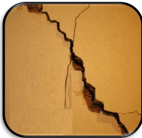
Imagen 17: Tipo de Patologías / Grietas Lineales
