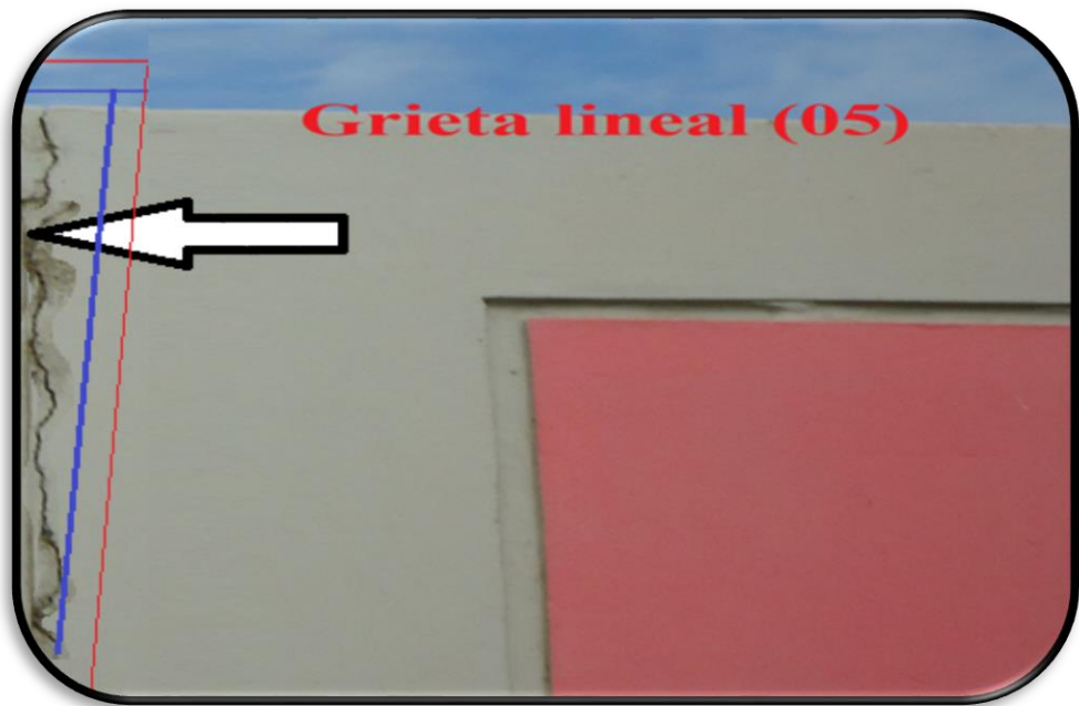
Fotografía 03: Columna perteneciente a la unidad de muestra U6 en ella se aprecia la patología de grieta lineal (05) severidad media.
