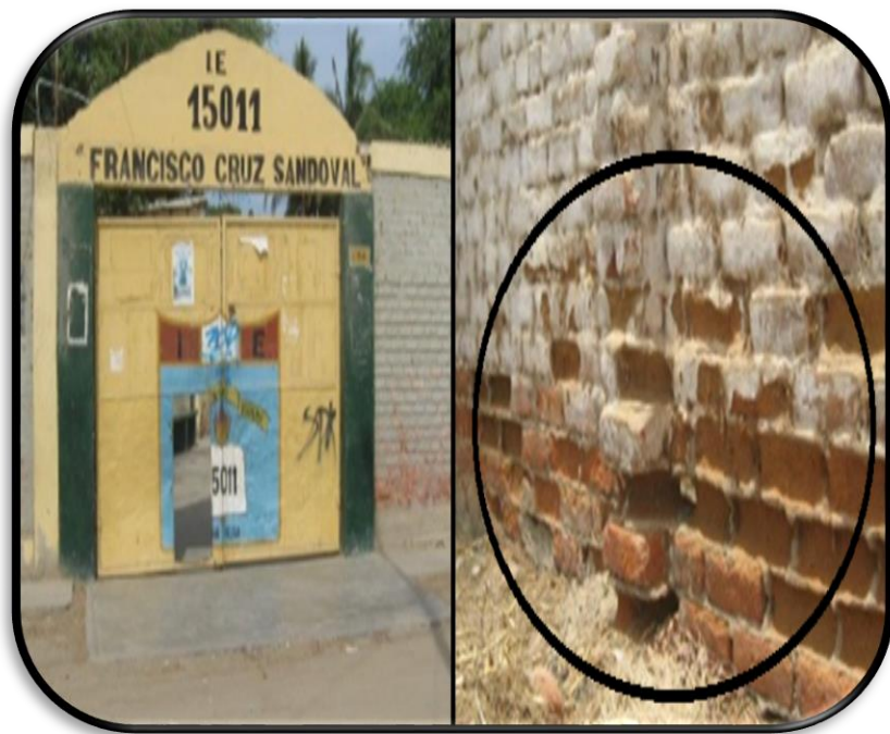
Imagen 03: Frontis I.E.15011 Francisco Cruz S. urb. Magdalena. 15011, se aprecia el muro del ladrillo con eflorescencia de salitre severo, con perforación de ladrillo sin tarrajar ni vereda de protección en muro lateral izquierdo
