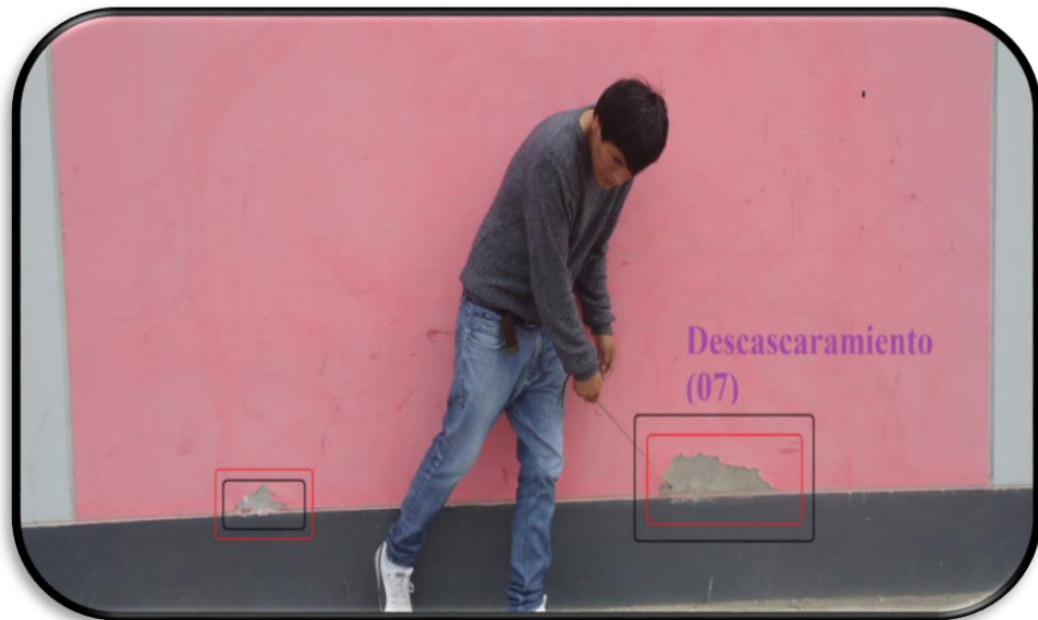
Fotografía 02: Detalle de la patología, Descascaramiento de pintura (07) de severidad leve con un área afectada de 0.55 \text{ m}^2 ubicado en la Av. Camino Real (unidad de muestra U1).
