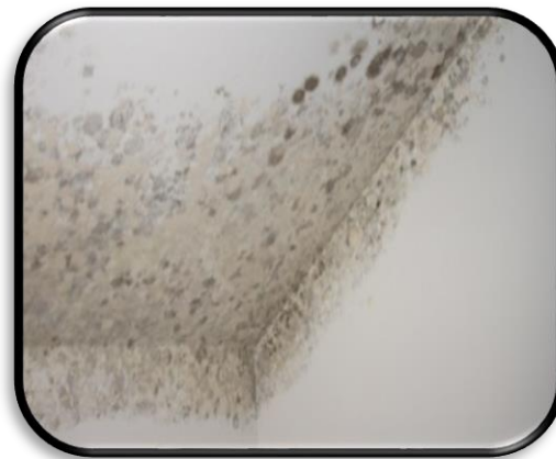
Imagen 15: Tipo de Patologías / Humedad
