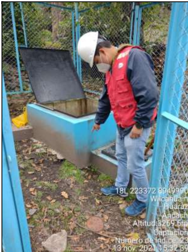
Figura 39: Vista de la captación 1, se observa agrietamiento en su estructura externa.
