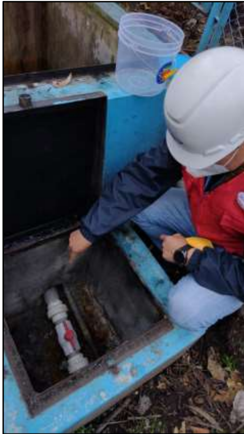
Figura 42: Vista de la cámara seca en captación 1.
