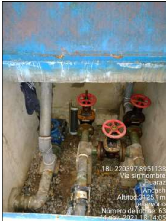
Figura 54: Vista de la caja de válvulas del reservorio, se observa que están oxidadas.
