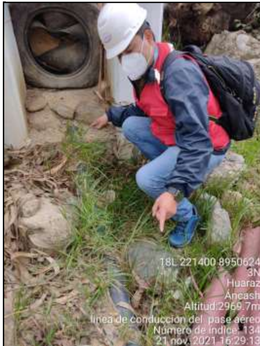
Figura 50: Vista de tubería HDPE y trasvase, se observa en proceso de deterioro.
