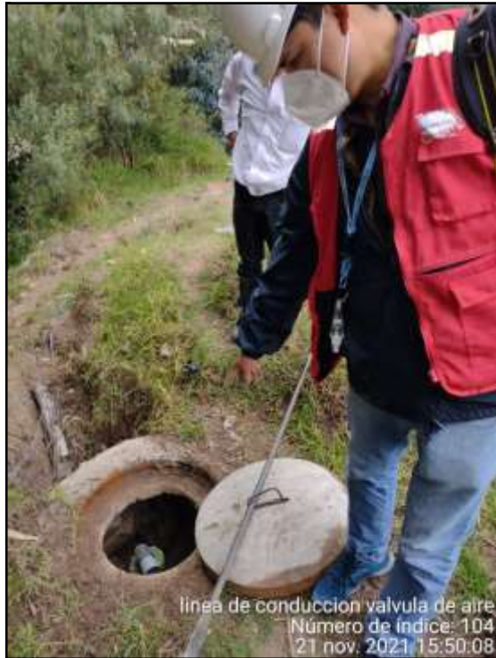
Figura 56: Vista de la válvula de aire, se observa que está en proceso de deterioro.
