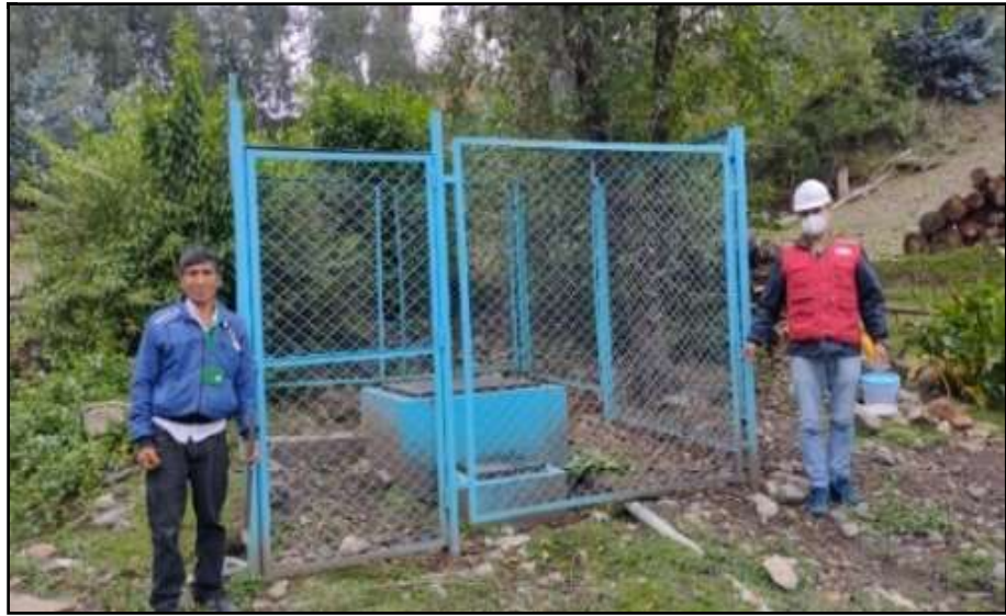
Figura 21: Vista de la línea de conducción en donde se encuentra un tramo expuesto.
