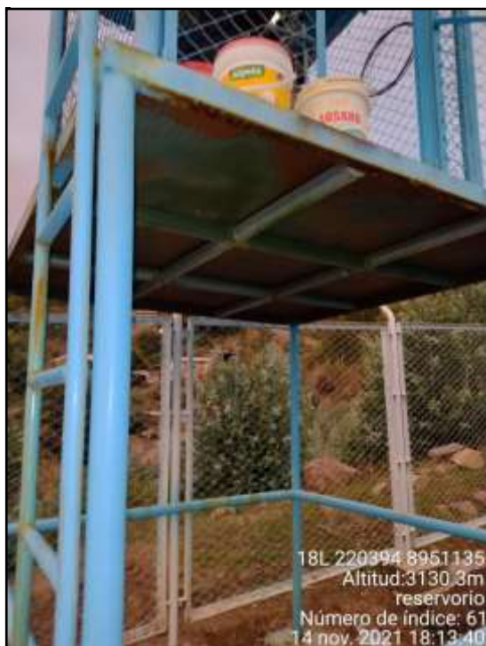
Figura 53: Vista de la caseta de cloración, se observa que la estructura esta oxidada.
