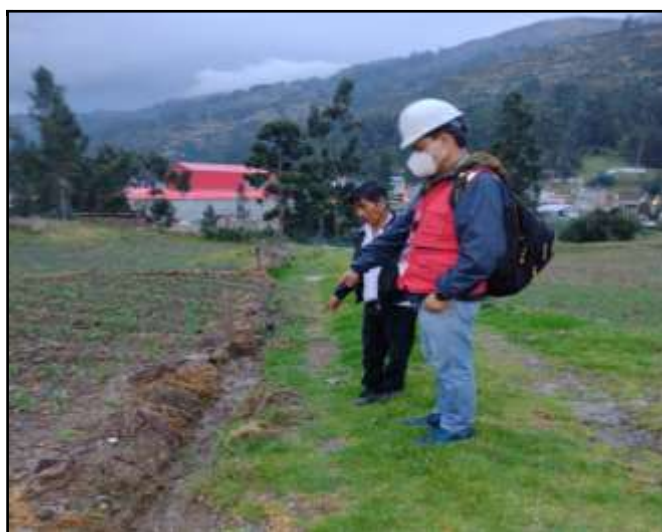
Figura 27: Vista de la línea de aducción que se encuentra enterrada en su totalidad
