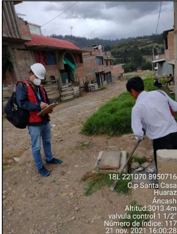
Figura 57: Vista de caja de la válvula de control, se observa la tapa metálica oxidada.
