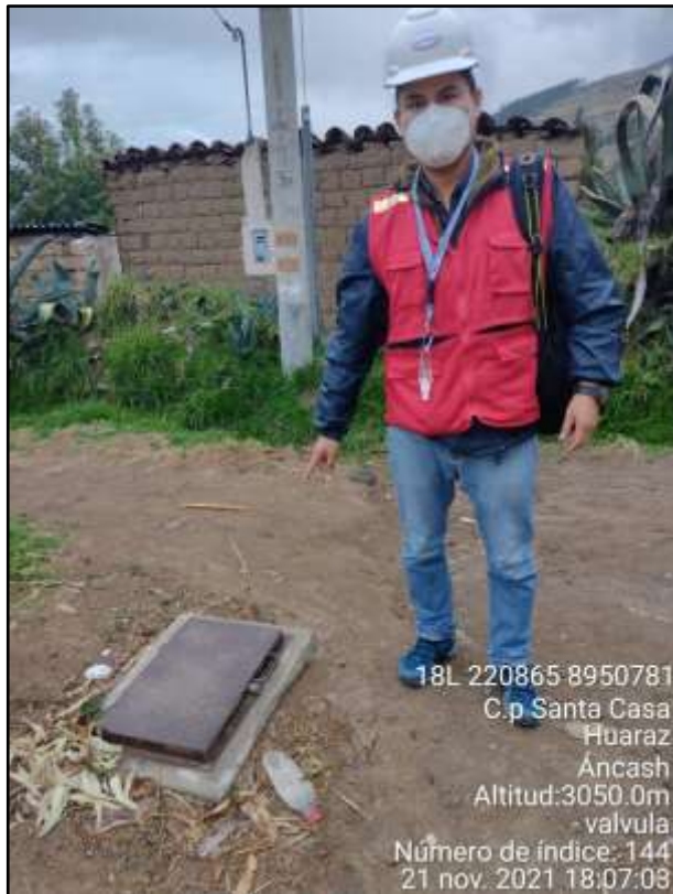
Figura 62: Vista de la caja de válvula de control.
