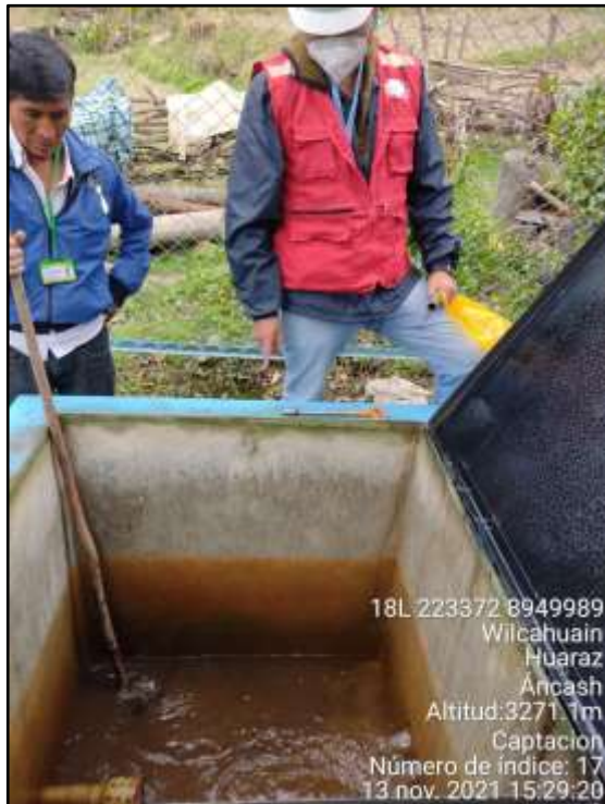
Figura 40: Vista de la captación 1, se observa la cámara húmeda.
