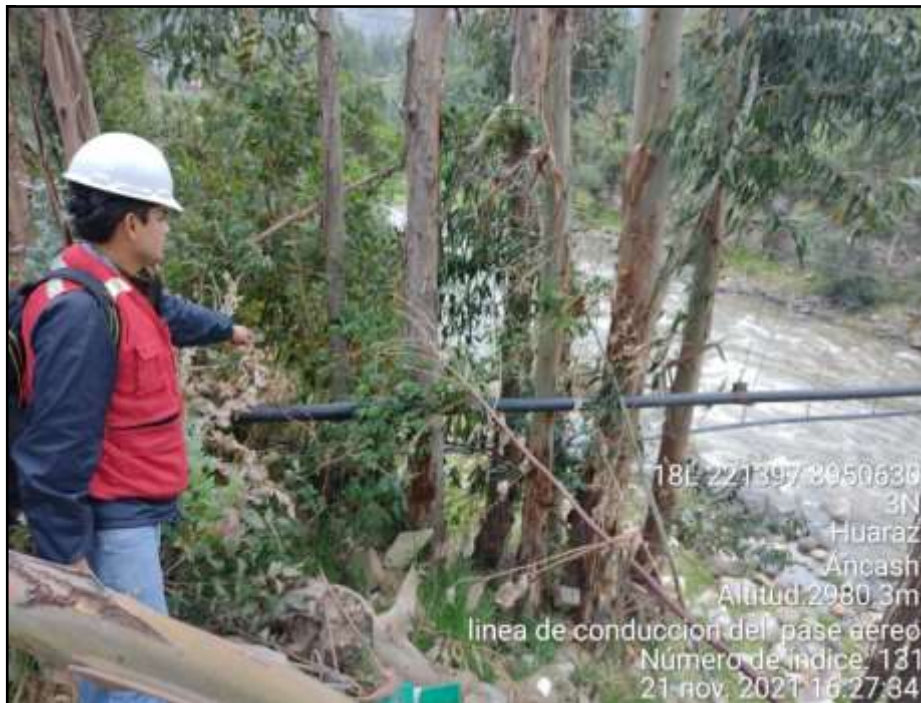
Figura 49: Vista de tubería HDPE, se observa que está en proceso de deterioro.
