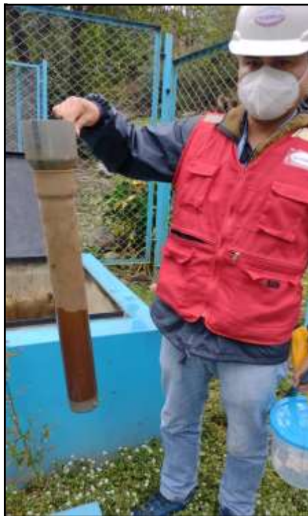
Figura 41: Vista del estado del cono de rebose de la captación 2
