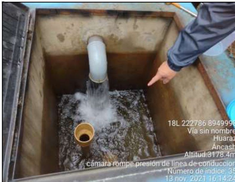
Figura 47: Vista de la segunda CRP 6 el interior cuenta con cono de rebose.
