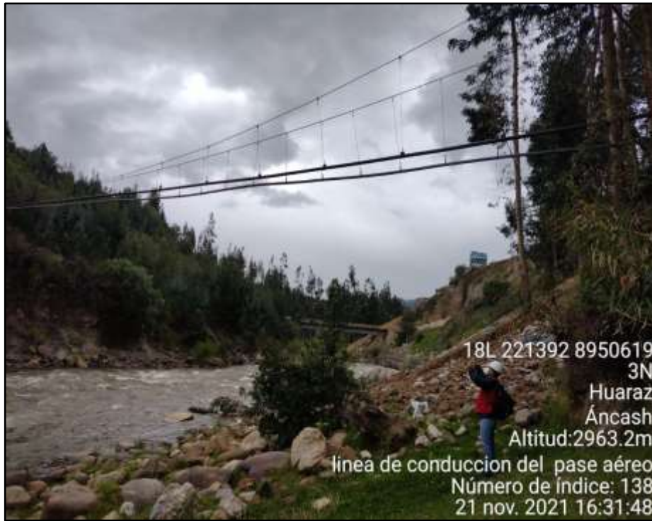
Figura 48: Vista del pase aéreo, con trasvase y tubo galvanizado.
