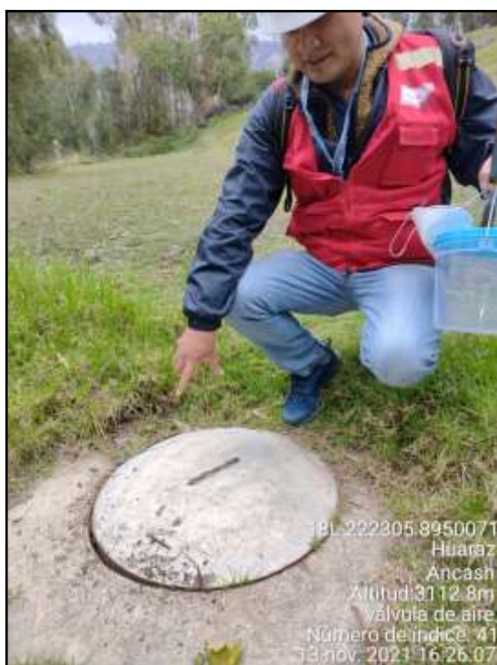
Figura 52: Vista de la válvula de aire, se observa que no tiene gancho para abrir la tapa.
