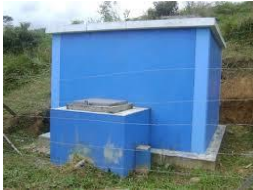
Imagen 4: Reservoirio de almacenamiento apoyado
