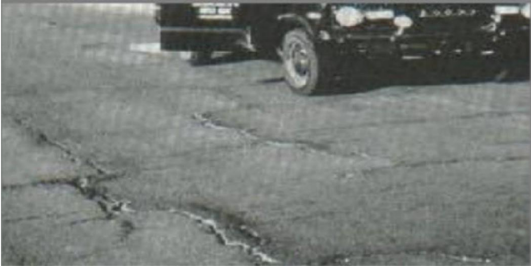
Figura 2.4: Agrietamiento en bloque de alta severidad. Fuente:(Sergio Navarro, 2008).
