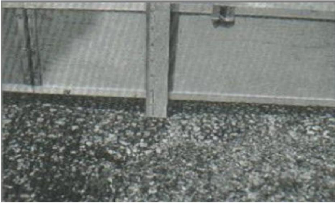
Figura 2.15: Ahuellamiento de alta severidad.
