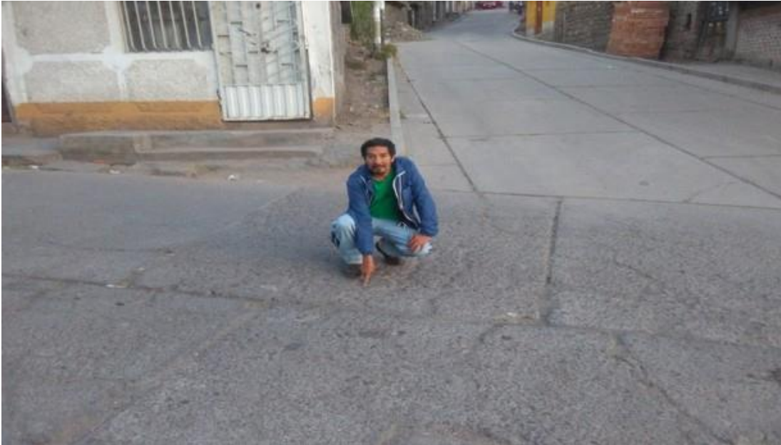
Fotografía 6: Losa dividida de lata severidad.
