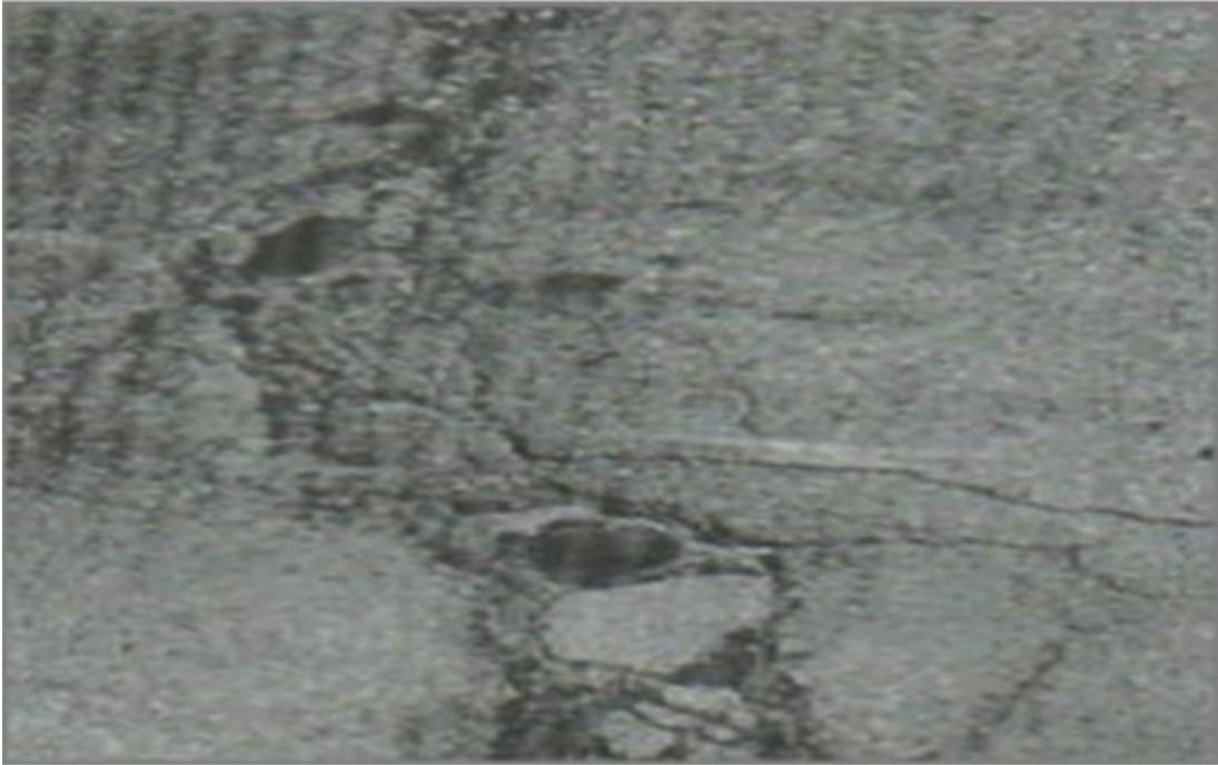
Figura 2.10: Grietas longitudinales y transversales de alta.
