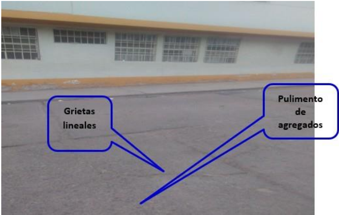
Fotografía 3: Grietas lineales de baja severidad y pulimento.
