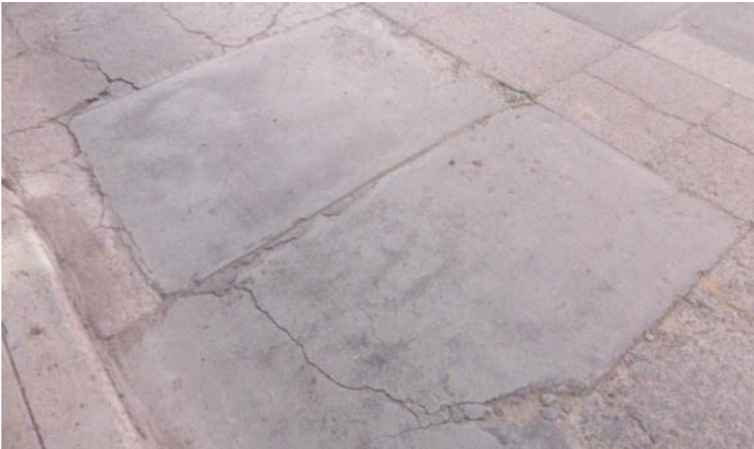
Fotografía 11: Parche grande de baja severidad.
