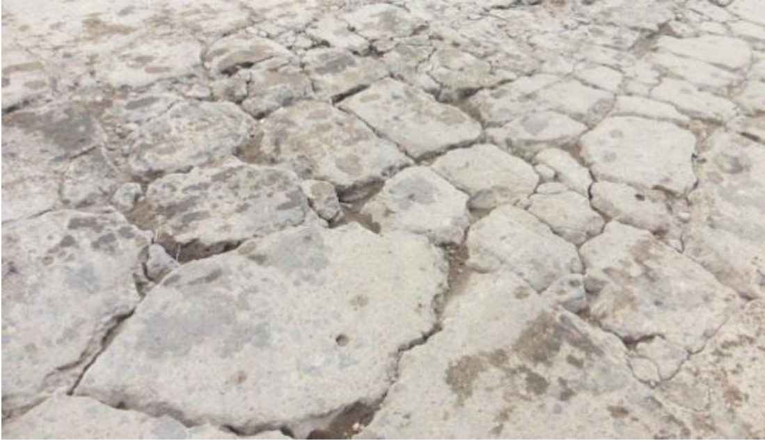
Fotografía 8: Losa dividida de severidad media.
