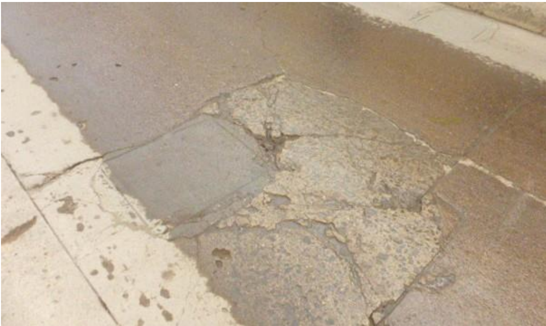
Fotografía 9: Grietas lineales de baja severidad, parche pequeño.
