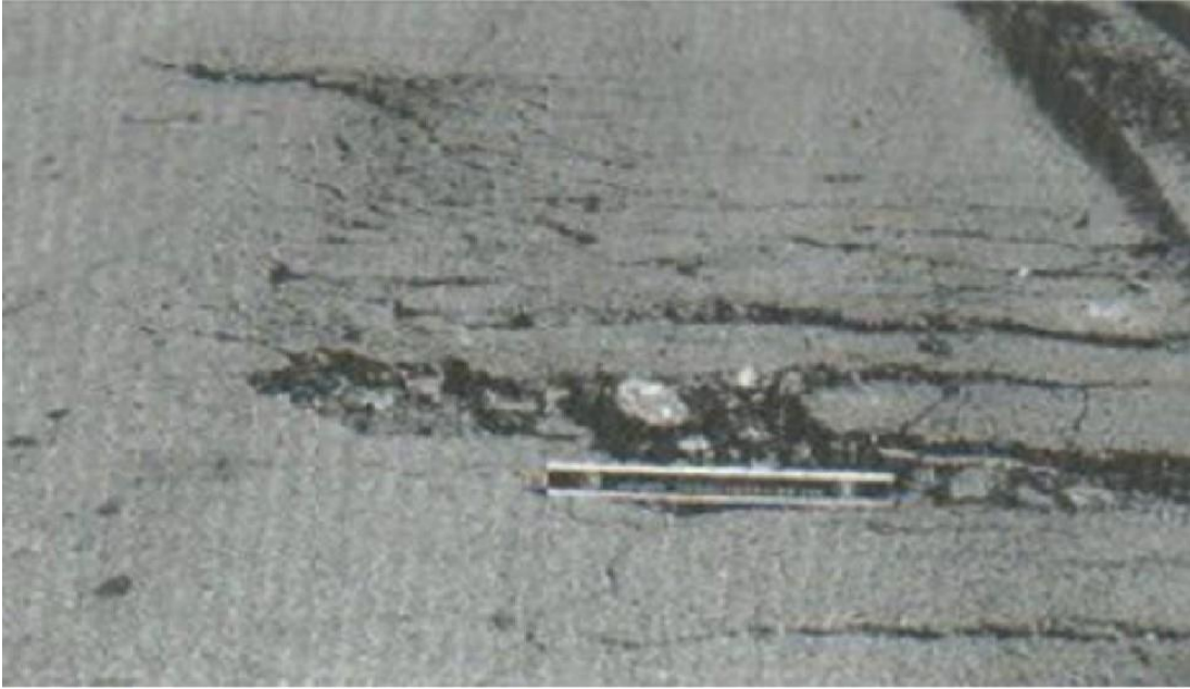
Figura 2.17: Grietas parabólicas de alta severidad.
