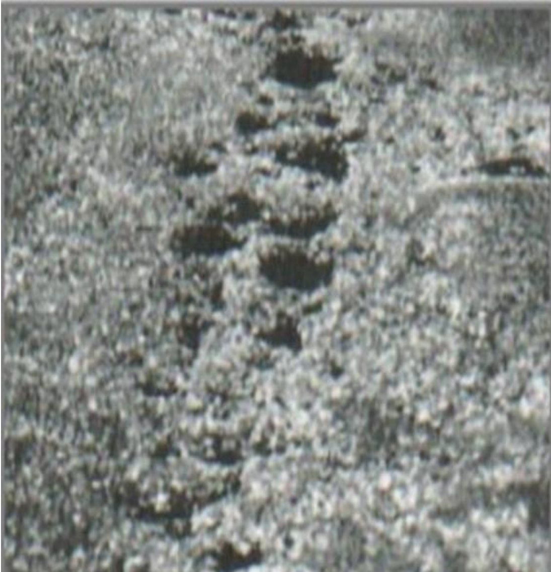
Figura 2.19: Desprendimiento de agregados de alta severidad. Fuente:(Sergio Navarro, 2008).
