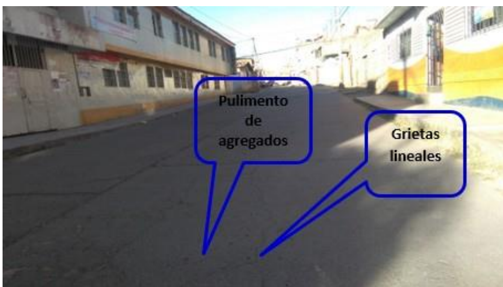
Fotografía 2: Grietas lineales de severidad media.
