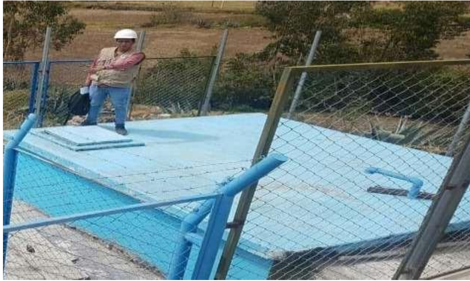
figura 07: Se observa el reservorio del caserío de Ucu,
