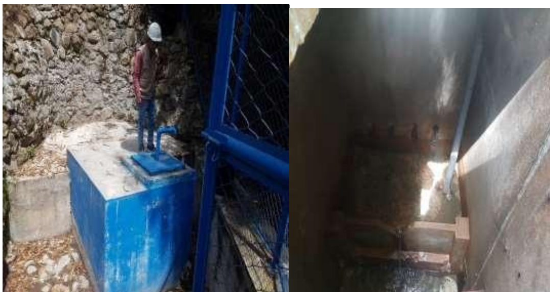
Figura 6: Se observa la cámara de captación y el puquio del caserío de Ucu,
