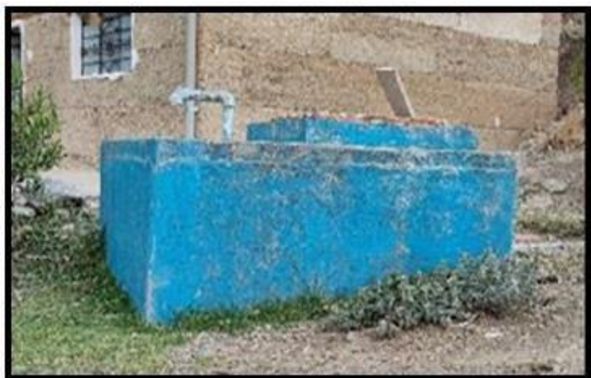
Figura 03: cámara rompe presión tipo 7 (CRP-7)
