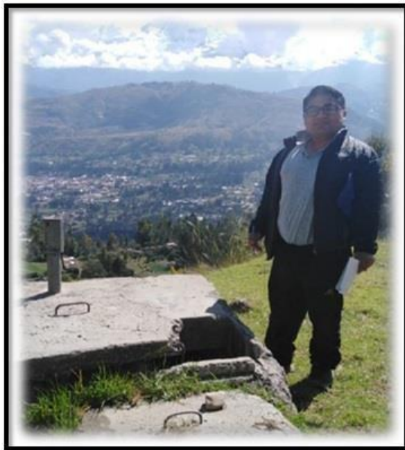
Figura 02: cámara rompe presión tipo 6 (CRP-6)
