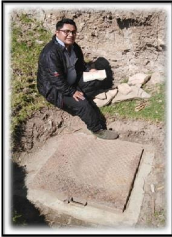
Figura 01: Captación, La fuente es subterránea y el tipo de captación es manantial de ladera
