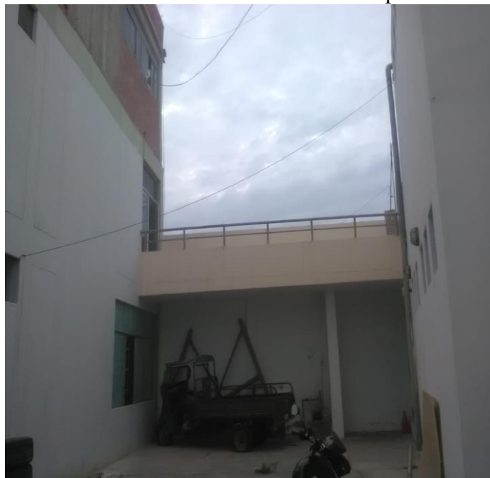
Gráfico Nro. 19: cable de red de datos al pabellón 02
