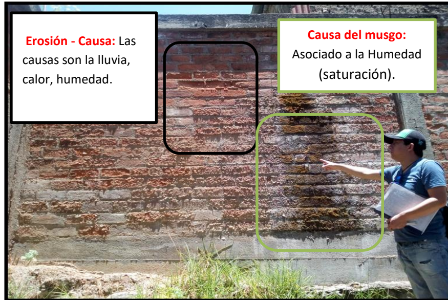
Imagen 1. Patología de musgo
