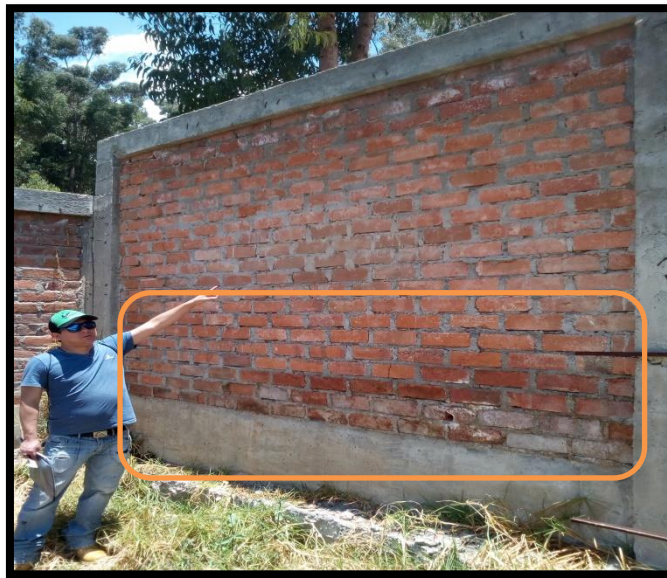
Imagen 4. Patología de Humedad
