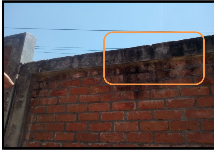
Imagen 5. Patología de Manchas
