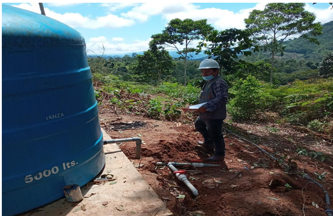
Foto 10: Se aprecia el reservorio de 5000 Litros pre fabricado, que cuenta con tubería de salida para la red de distribución, pero no cuenta con caseta de válvulas.
