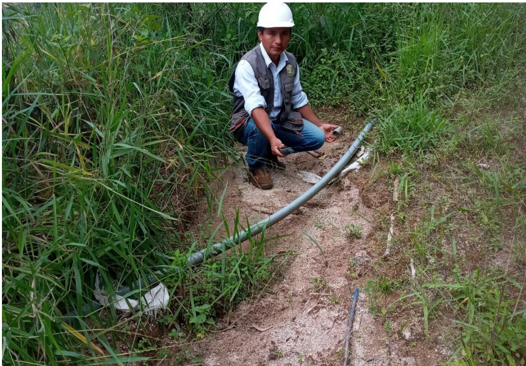
Foto 4: Se aprecia un tramo de la línea de conducción expuestas y con falta de mantenimiento.
