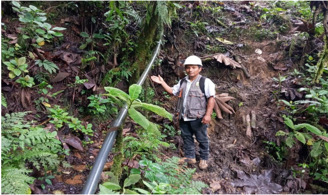
Foto 7: Se aprecia un tramo de tubería de HDPE por el terreno rocoso.
