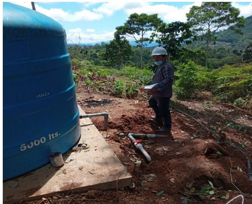
Imagen 6. Se aprecia que no cuenta con caseta de válvulas el reservorio de 5000
