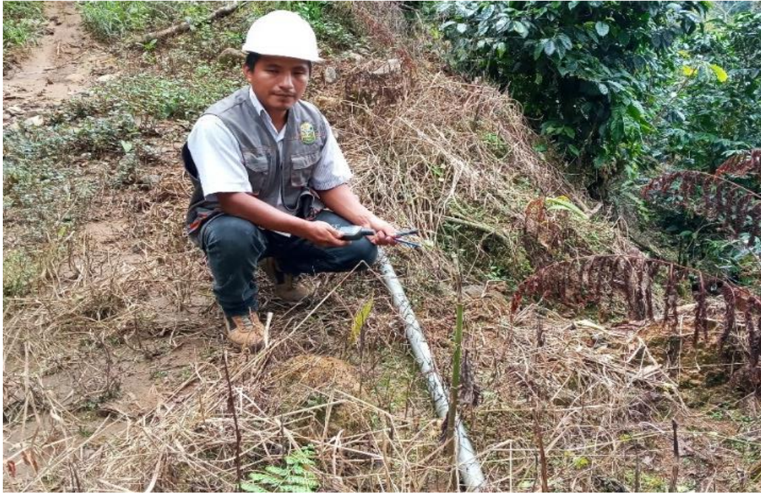
Foto 5: Se aprecia otro tramo de la línea de conducción expuestas y con falta de mantenimiento.
