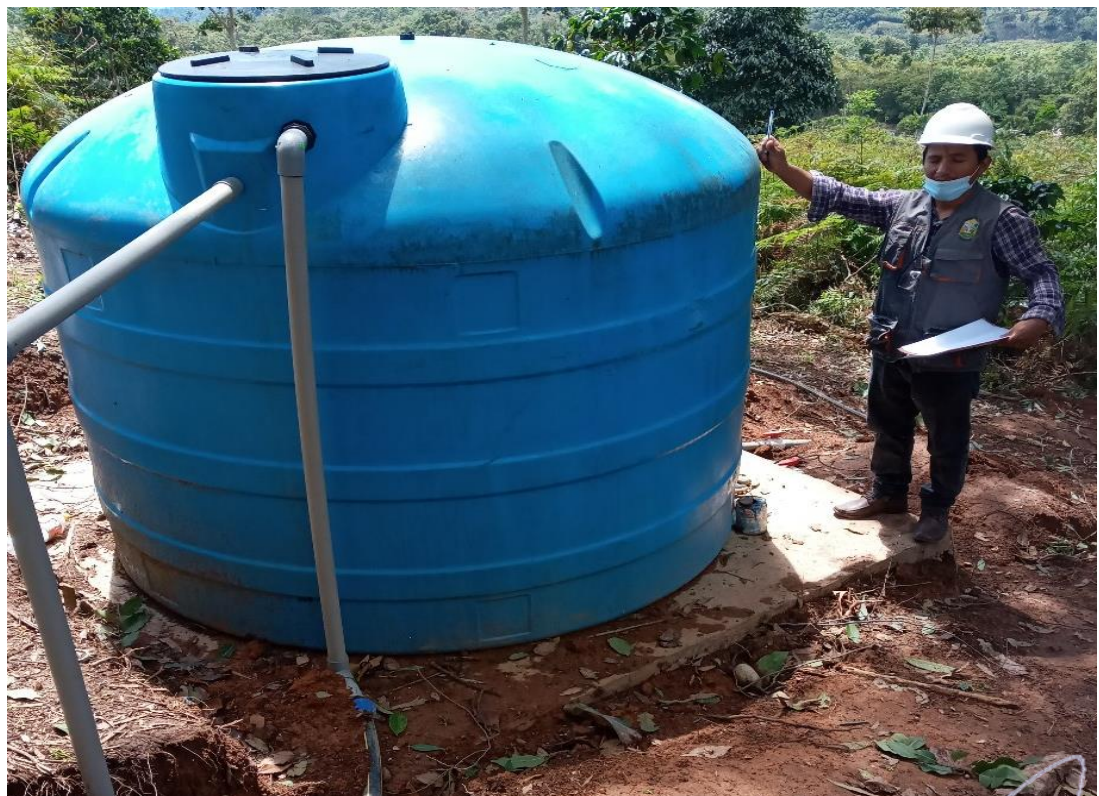
Foto 8: Se aprecia el reservorio existente de 5000 Litros de material pre fabricado.
