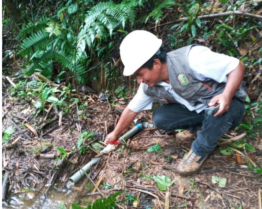
Imagen 4. Válvula de purga expuesta y sin caja de concreto
