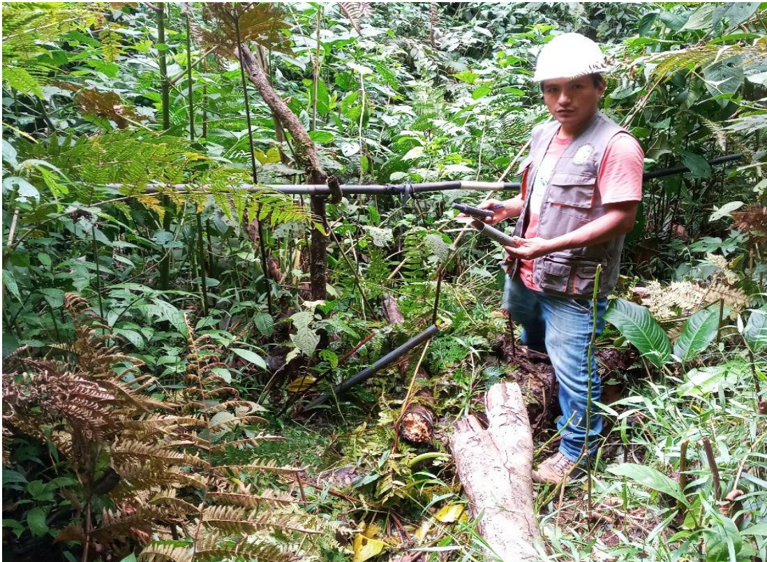
Foto 12: Se aprecia segundo tramo de la línea de aducción que se encuentra expuesta por la falta de mantenimiento.
