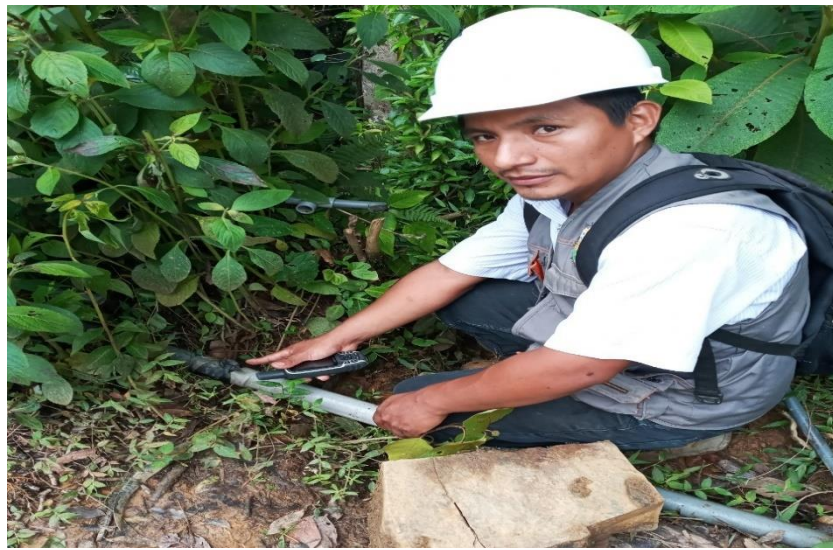
Imagen7. Roturas de tubería ubicada en línea de aducción expuesta
