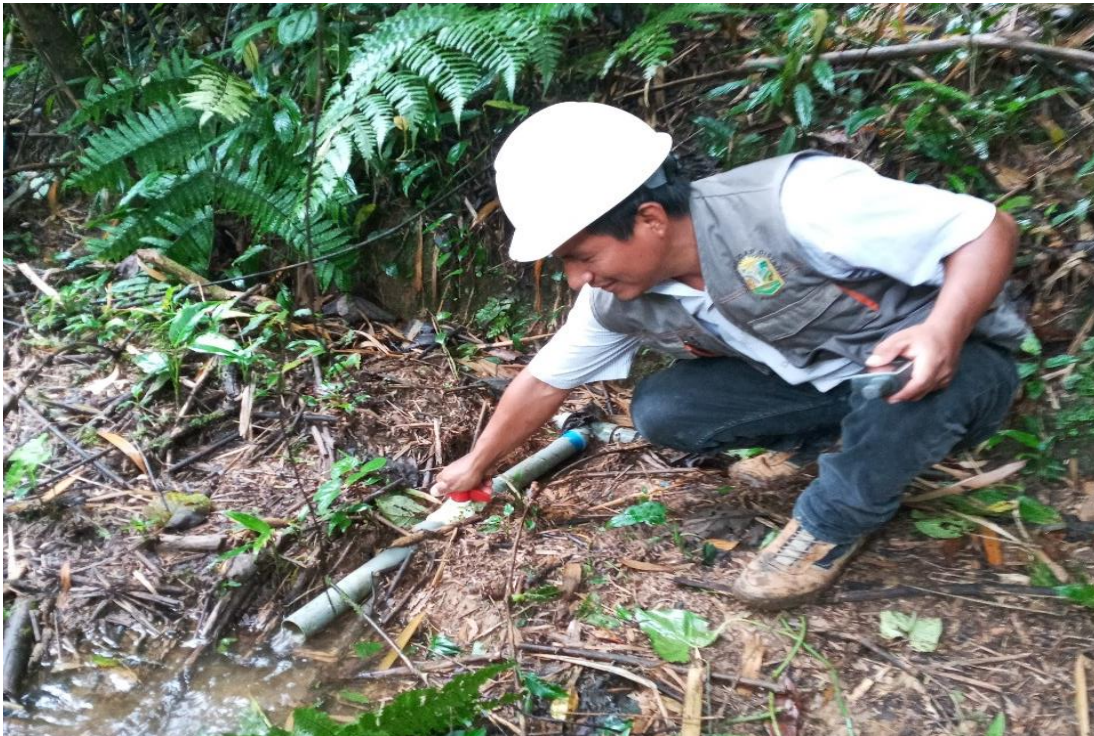
Foto 6: Se aprecia una válvula de purga artesanal para purga de sedimentos por la línea de conducción.
