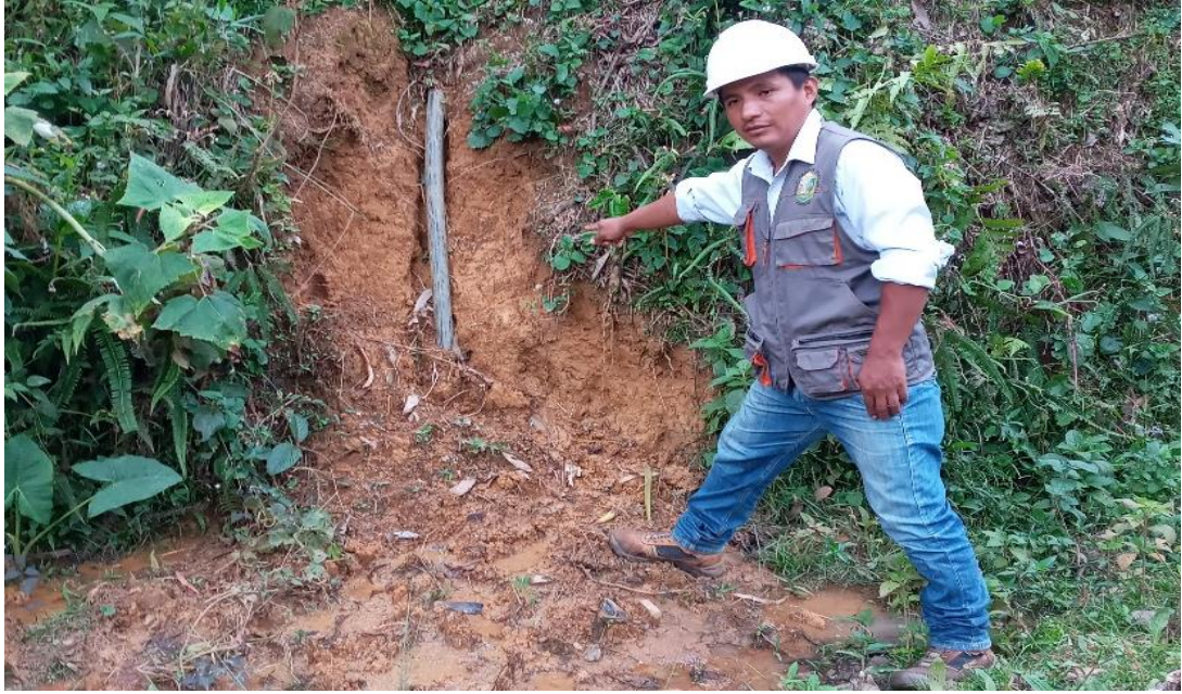
Foto 11: Se aprecia un tramo de la línea de aducción que se encuentra expuesta por la falta de mantenimiento.
