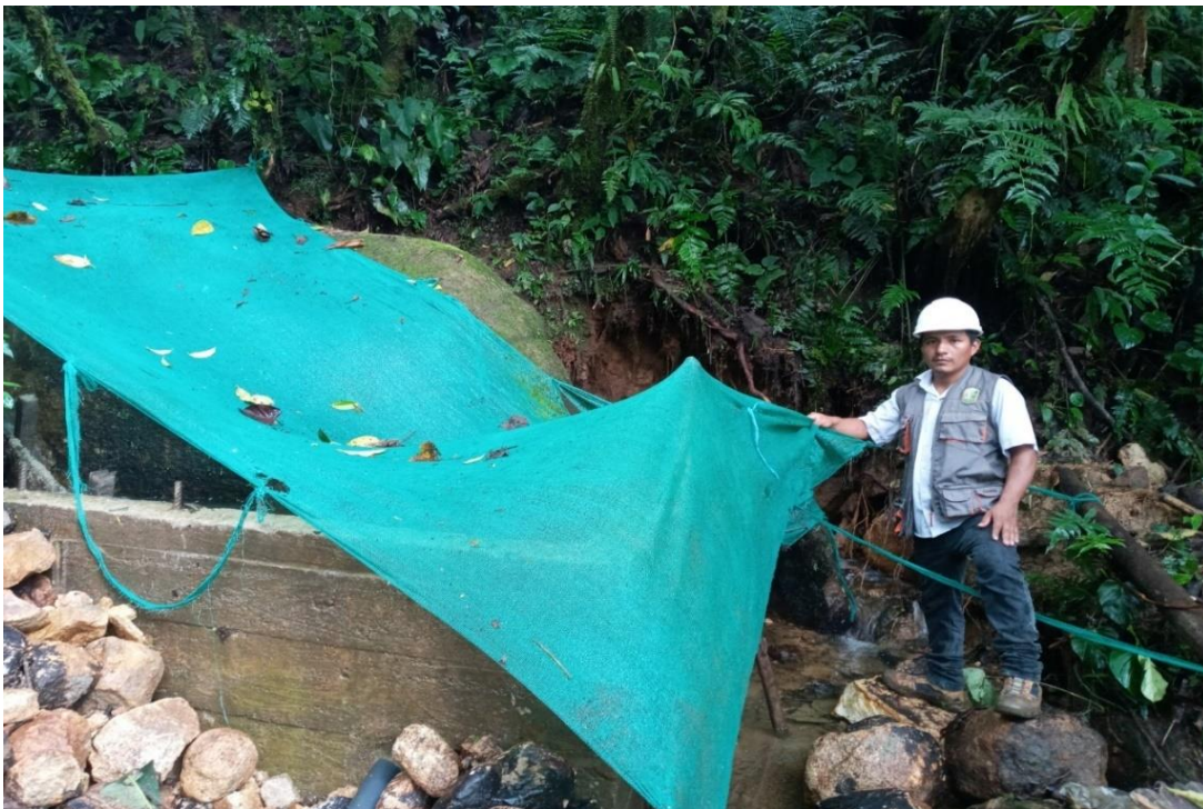
Foto 2: Se aprecia la captación existente que se encuentra con un inadecuado mantenimiento por parte del sector Nueva Betania.
