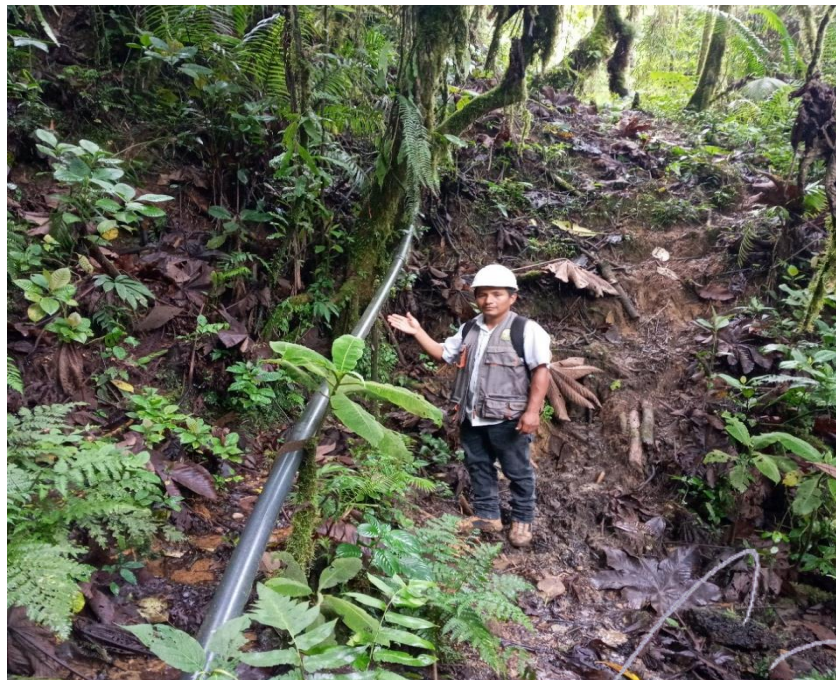
Imagen 3. Tubería de línea de conducción expuesta
