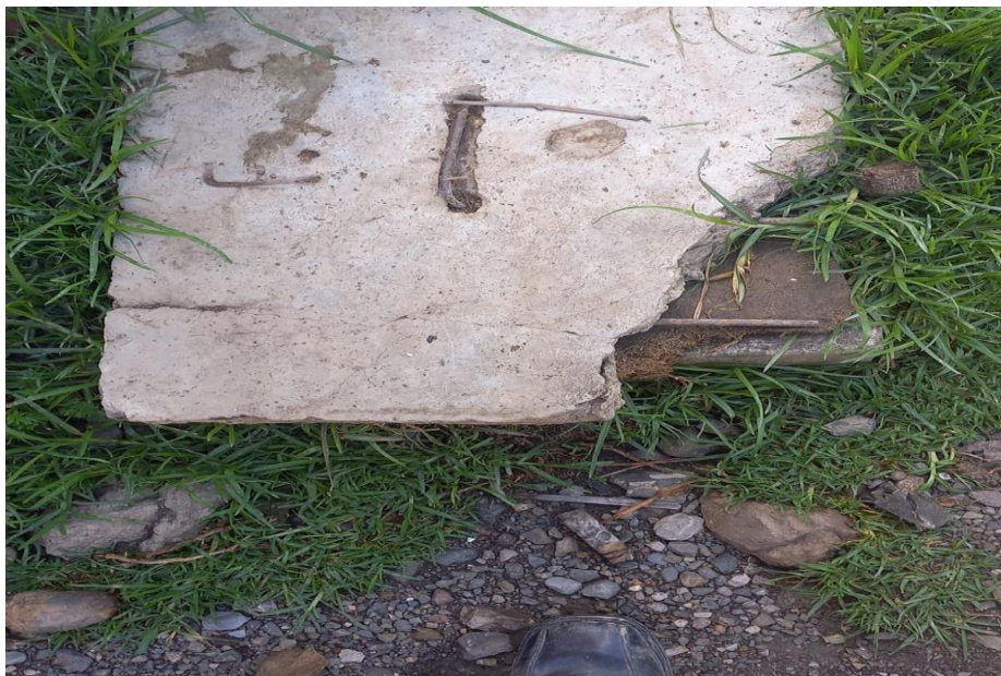
Fotografía 14: caja de paso en mal estado
