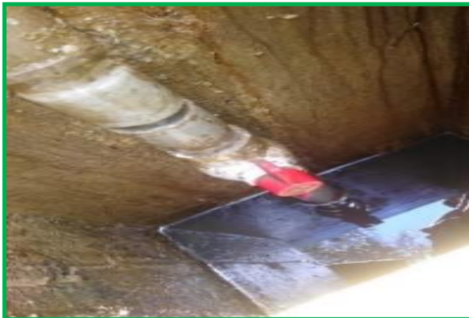
Fotografía 16: Válvula de control en mal estado
