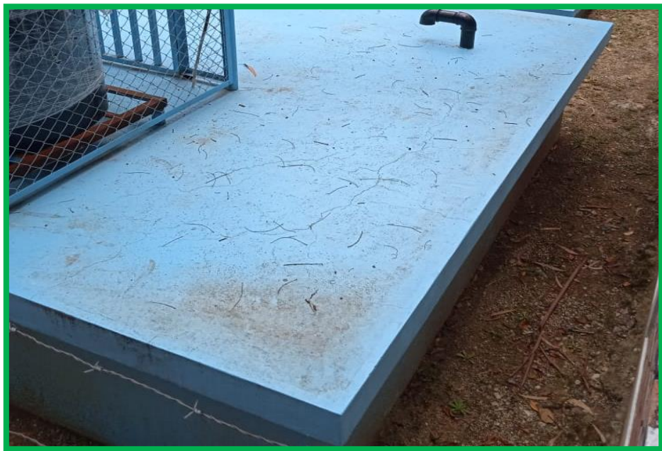
Fotografía 10: fisuras en el reservorio
