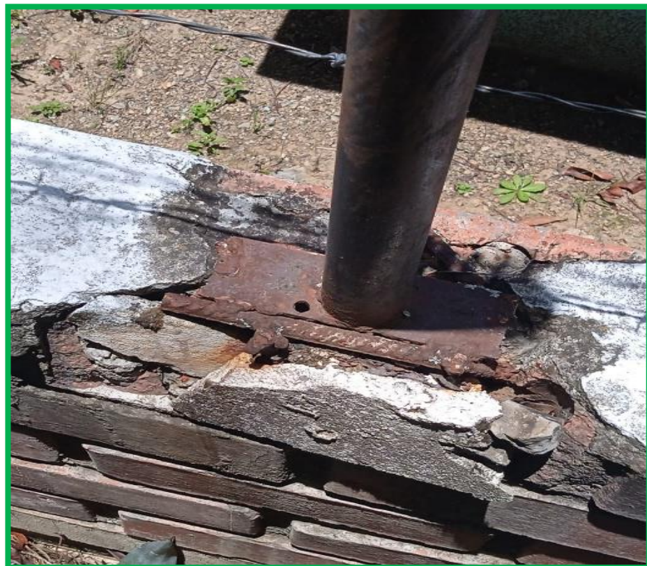
Fotografía 08: cerco perimétrico deteriorado
