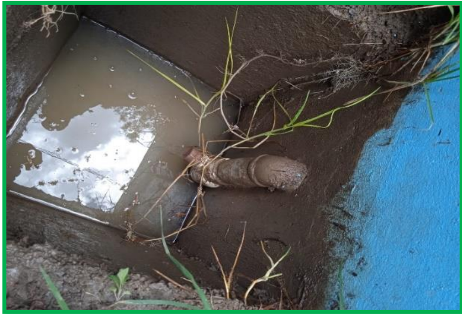
Fotografía 13: válvulas en mal estado
