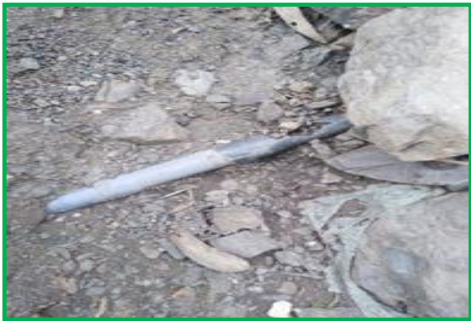
Fotografía 12: red de distribución visible
