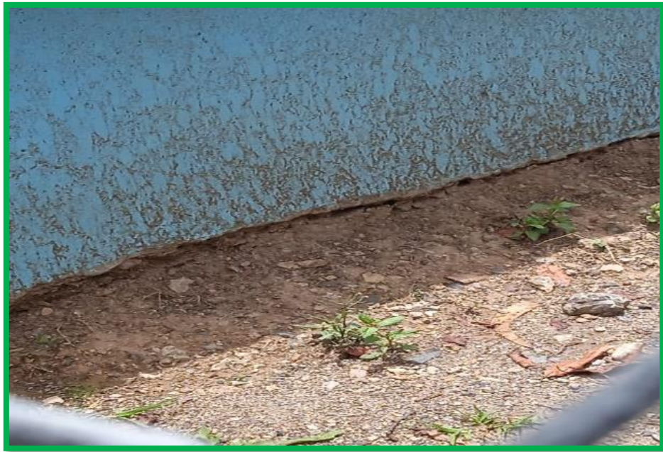
Fotografía 11: socavamiento en el reservorio
