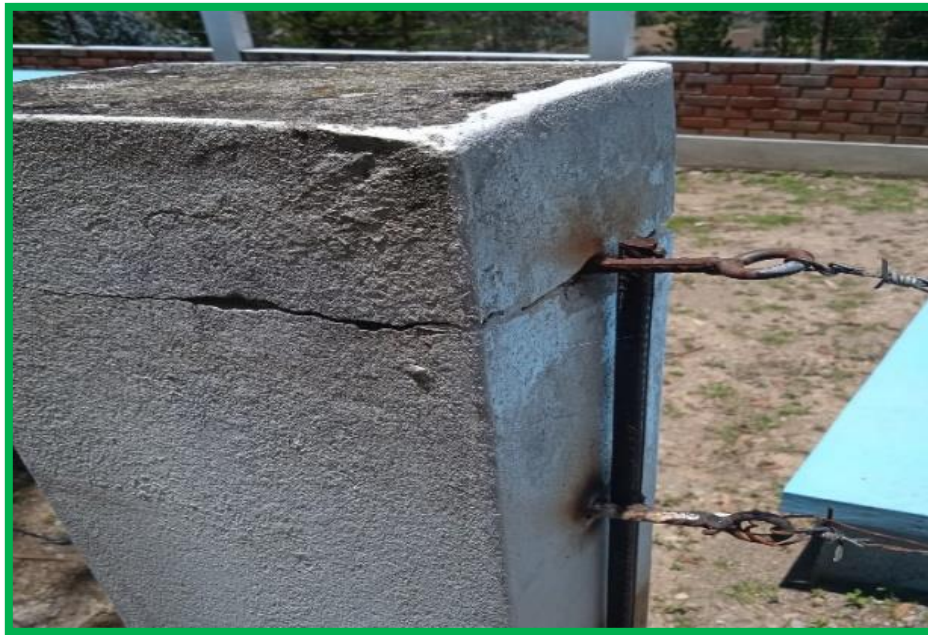
Fotografía 07: rajaduras en el cerco perimétrico
