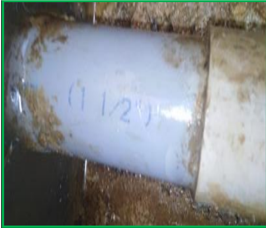
Fotografía 15: diámetro de tubería de la línea de conducción y red de distribución.
