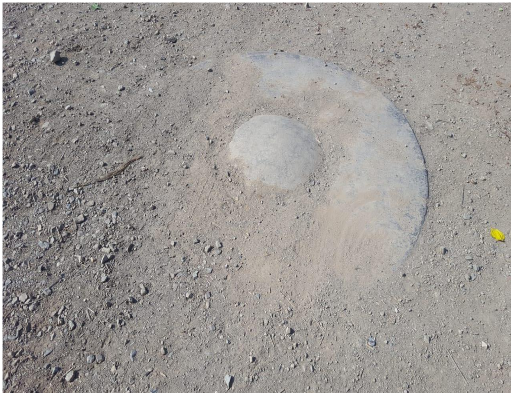
FOTO N° 8: SISTEMA DE ALCANTARILLADO. BUZONES TAPADOS
