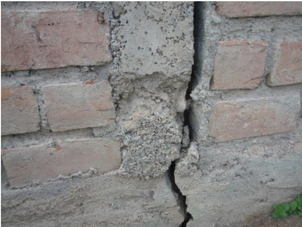
Figura 27: vista de fallas en la muestra 09 detallado
