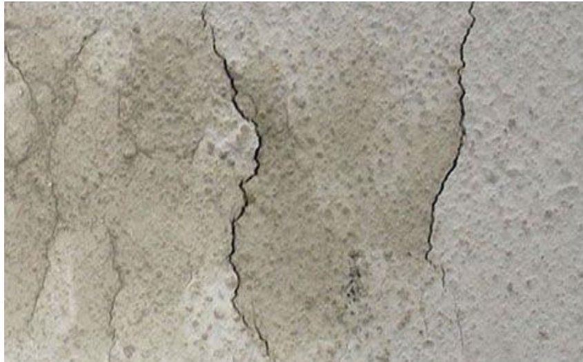
Figura 9: imagen de fisuras en paredes.
