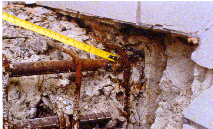
Figura 14: imagen de corrosión
