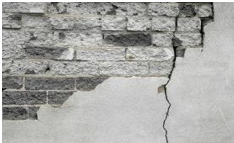
Figura 10: imagen de grieta en muro.
