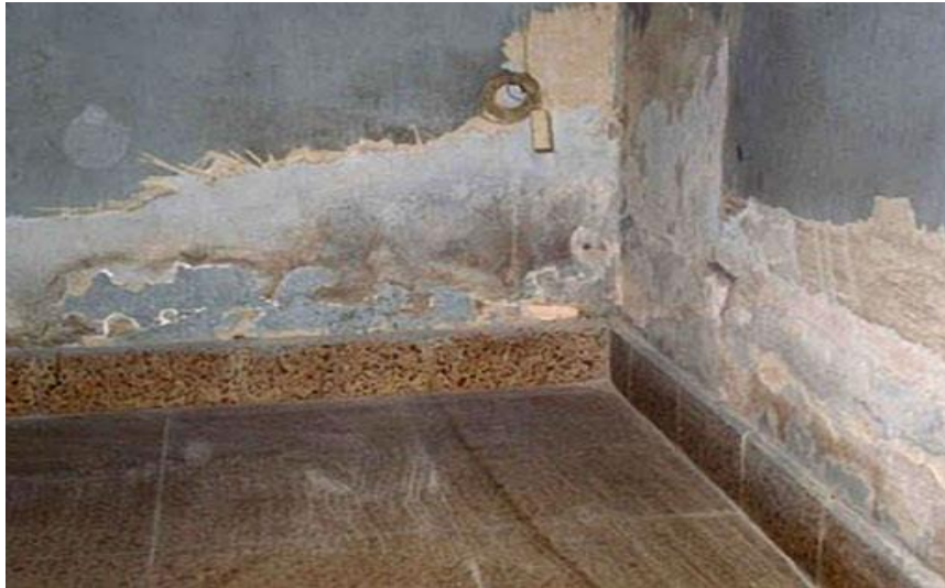
Figura 11: imagen de eflorescencia en paredes.
