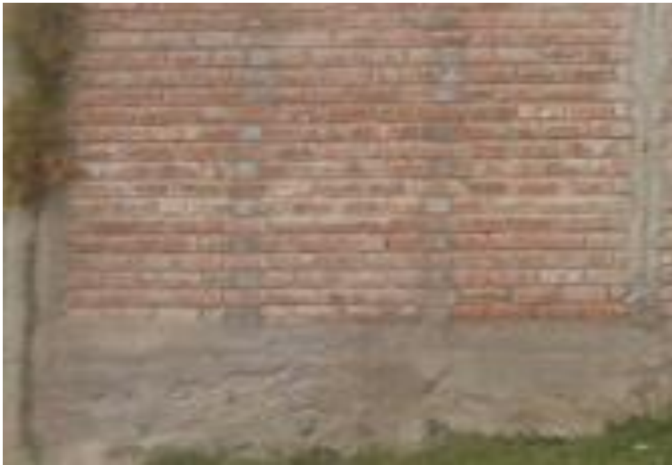
Figura 29: vista de fallas en la muestra 07 detallado
