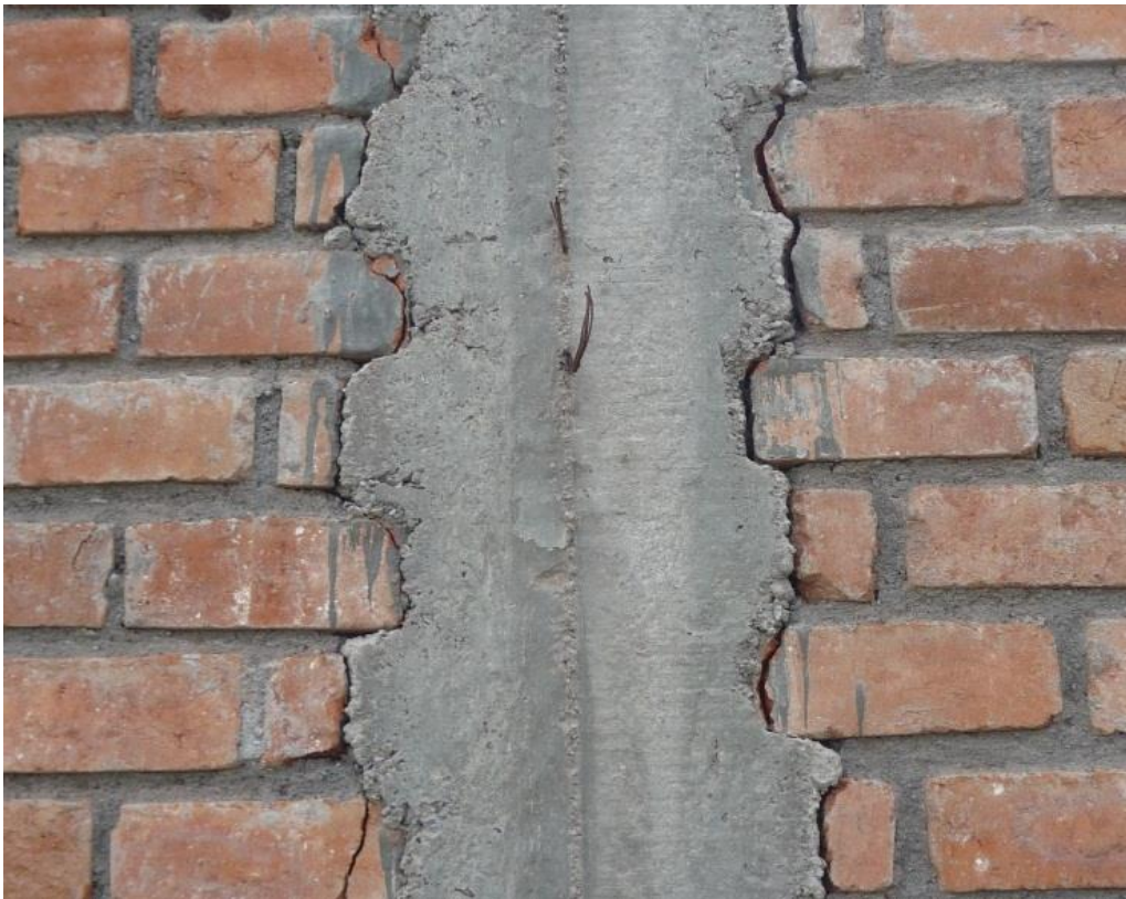
Figura 28: patología de grietas en la muestra 06 detallado
