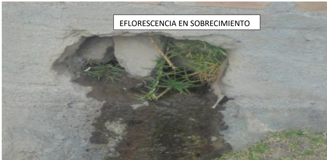
Figura 30: Presencia de patología por eflorescencia en la muestra 01 afectando el elemento de severidad.
