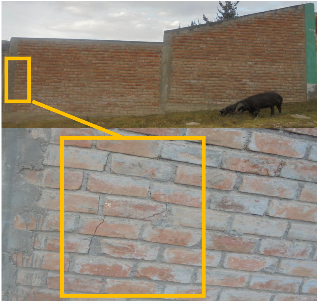
Figura 32: fotografía de la muestra 03, una de las patologías que afecta el muro es grieta
