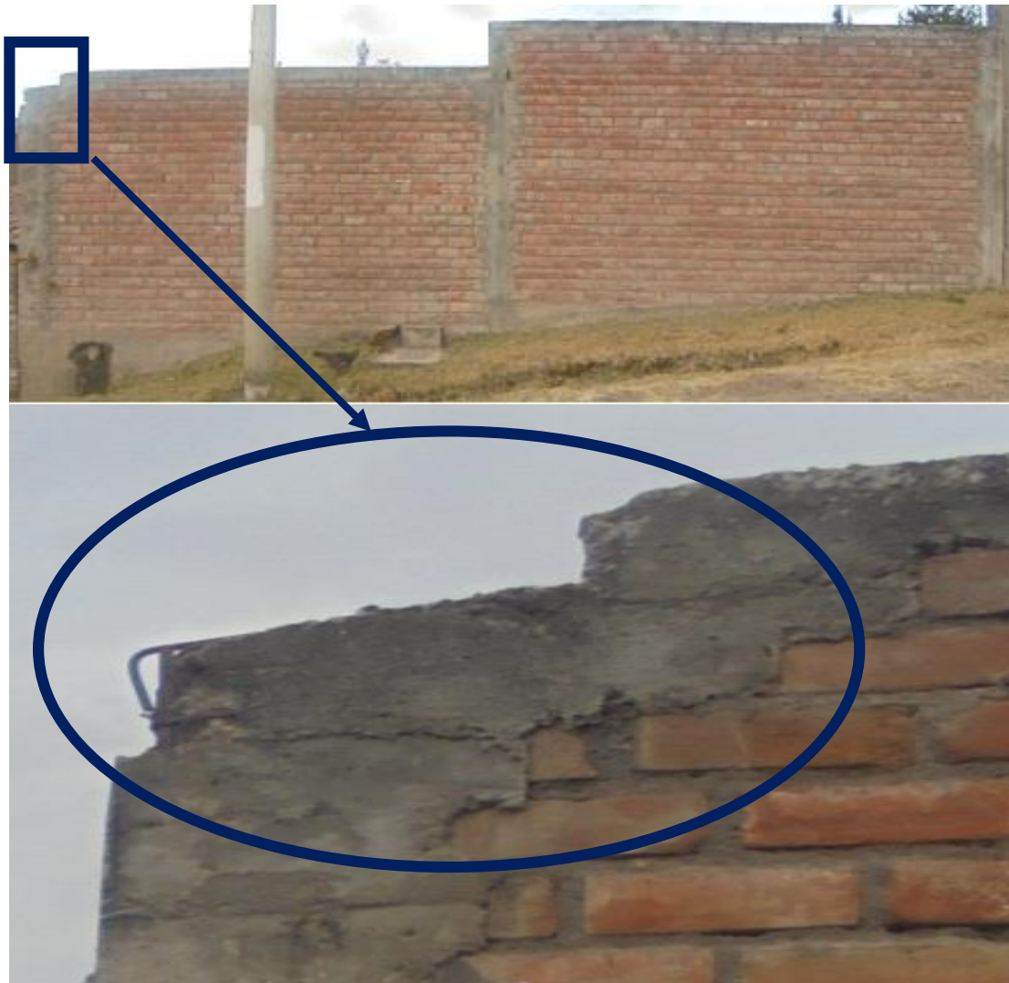
Figura 31: Patología de desintegración en los elementos de viga y columna
