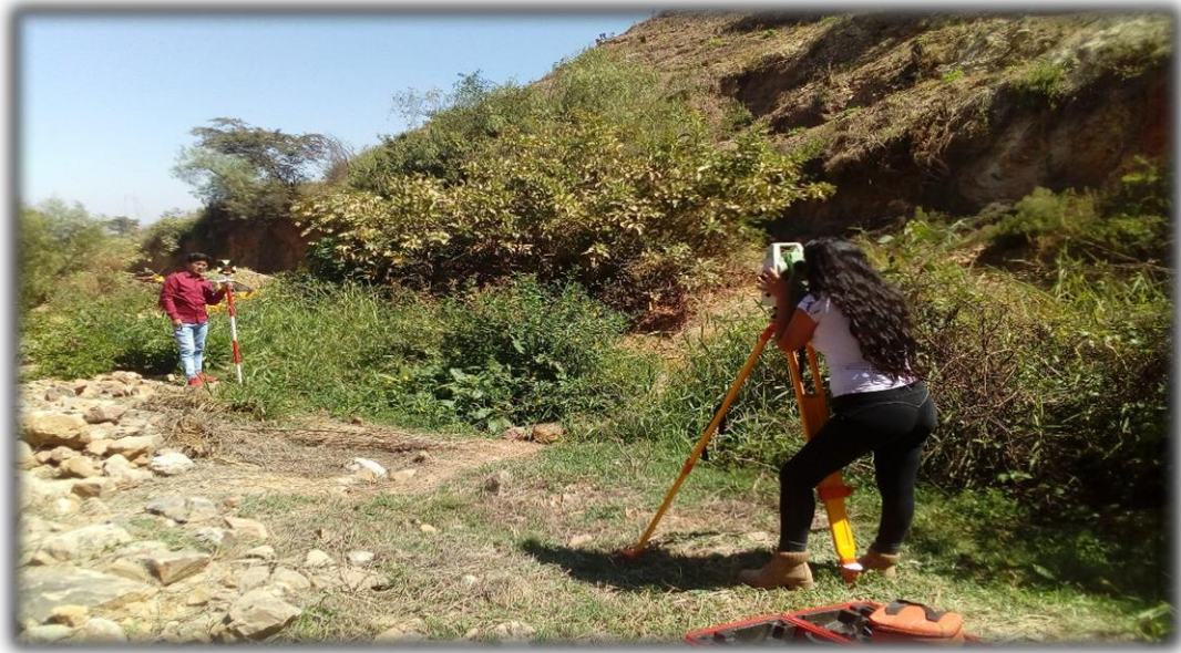
Imagen N° 4: Realizando levantamiento topográfico en el Caserío de Trigopampa distrito de Otuzco, provincia de Otuzco, región la liberta
